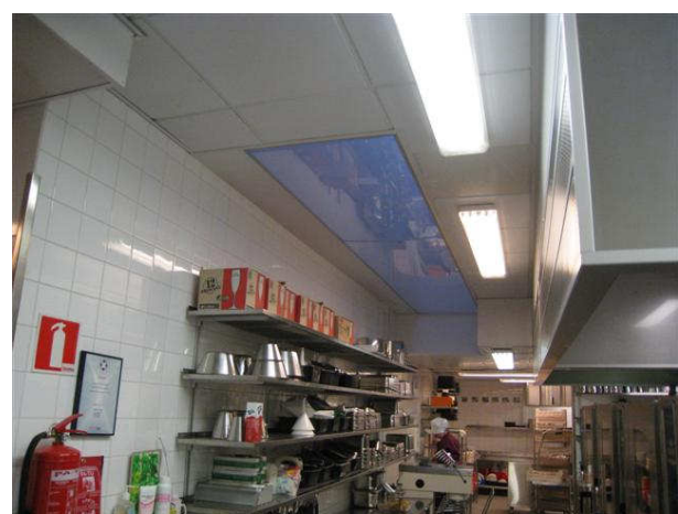
Kuva 40 Yleiskuva keittiön ruuanvalmistustilaan. Osa vesihöyrystä menee huuvien ohi.
