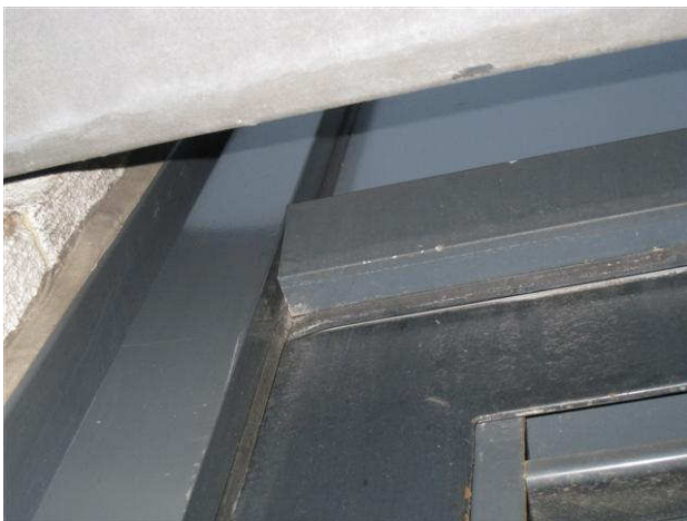
Kuva 21 Porras A:n ulko-oven yläp. on lista irti ja välistä pääsee vesi .
