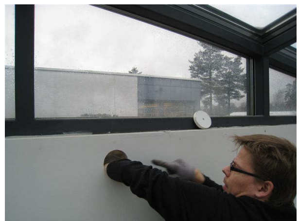
Kuva 36 Kuvaamataitoluokan 1.53 kattolyhdyn vuotopaikka on kuilun seinässä lasitusten alla selvästi vesikatetta ylempänä.
