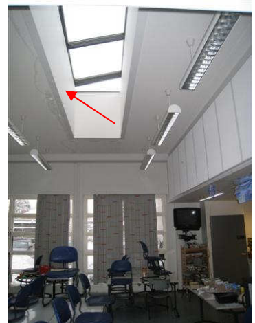
Kuva 34 Yleiskuva kuvaamataitoluokka 1.53 ja sen vuotavaan kattolyhtyyn.
