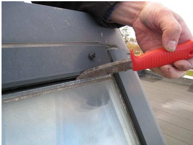
Kuva 4 Kuvan 3 kattolyhdyn yläreunassa on 10 mm rako, koska lasielementti on liikkunut.
