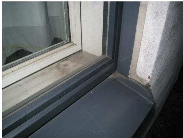
Kuva 33 Ikkunoiden kautta on päässyt pölyä ja vettä mm. kanslia 1.34 kohdalla.
