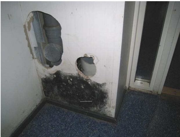
Kuva 15 Homeinen putkikotelo solun 2.11 alla solussa 1.11. Myös lattia on kostea.
