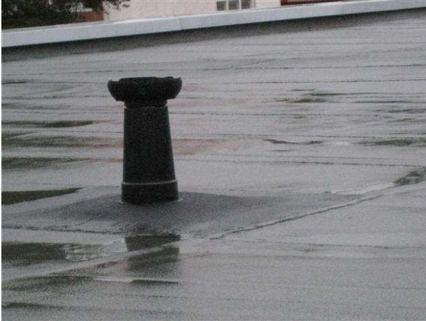
Kuva 7 Alipainetuulettimen katoskupu on irrotettu.
