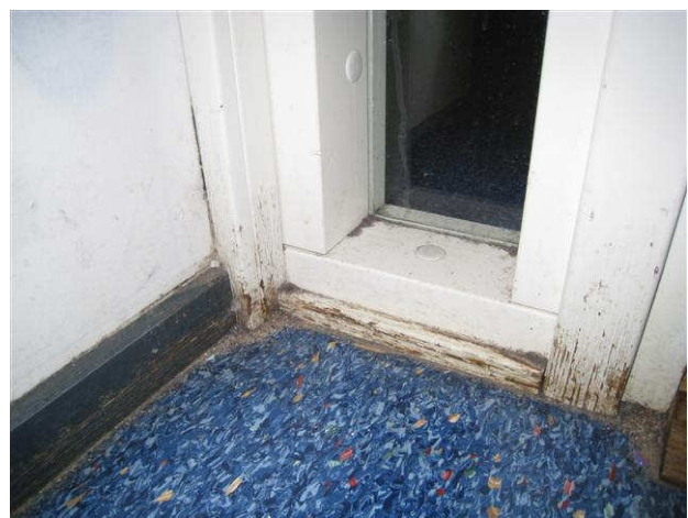
Kuva 46 Nurkkiin kertynyttä hiekkaa, puulistat ovat kuluneet siivouksen johdosta.
