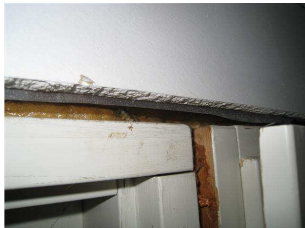
Kuva 20 Musiikkiluokan 1.06 ikkuna on elänyt vesivuotojen takia, yläp. kipsilevy vaikutti olevan kunnossa. Liittymät eivät ole tiiviit.
