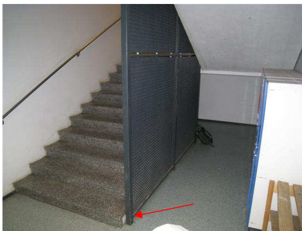
Kuva 23 C-portaan hajun syynä on tod. näköisesti portaalan alapään epätiivis liittäminen alapohjaan.
