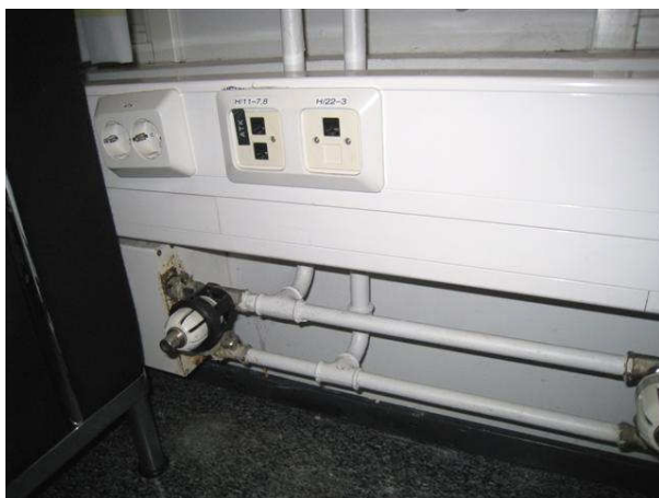
Kuva 29 Vuotava patteriputken liitos opettajien huoneessa 1.35.
