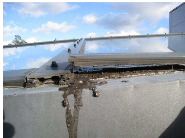
Kuva 6 Loivien lasikattojen listojen alle kertynyttä roinaa ravintolasalin katolla.
