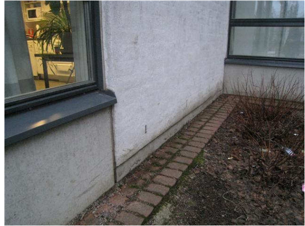
Kuva 32 Rakennusvierillä maanpinnat ovat korkealla lähellä lattiapintoja.
