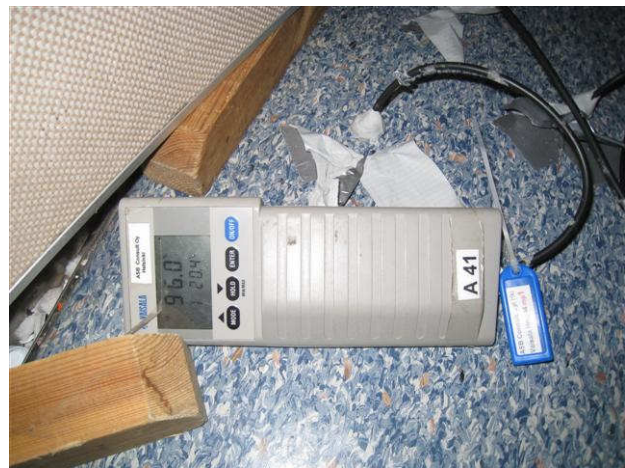
Kuva 38 Kuvaamataidon luokan ritiläkaivon vieressä betonilaatan kosteus on selvästi koholla, n. 96 % RH (LPR3). Kaivon rakenteesta ei saatu käsitystä.
