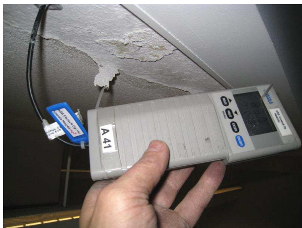
Kuva 35 Kattolyhdyn kuiluseinän alla on ontelolaatan ontelon kosteus suuri 83 % RH (KPR 2). Pinnassa on kosteus- ja mikrobivaurio, levykotelon sisällä on selvä mikrobivaurioon viittaava haju.
