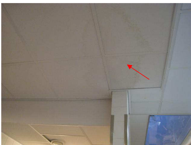
Kuva 41 Keittiön alakaton vuotojälkiä porrastuskohdalla moduulipisteen K3 lähellä.
