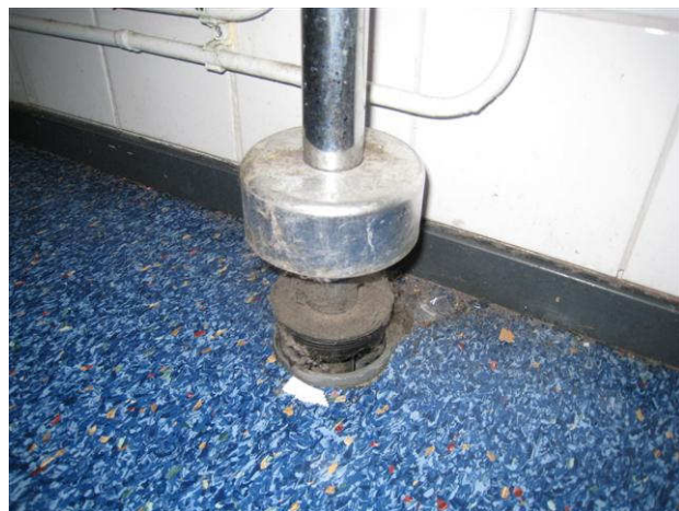
Kuva 17 Lavuaarin vesilukon putken ja viemärin liitos ei ole tiivis..
