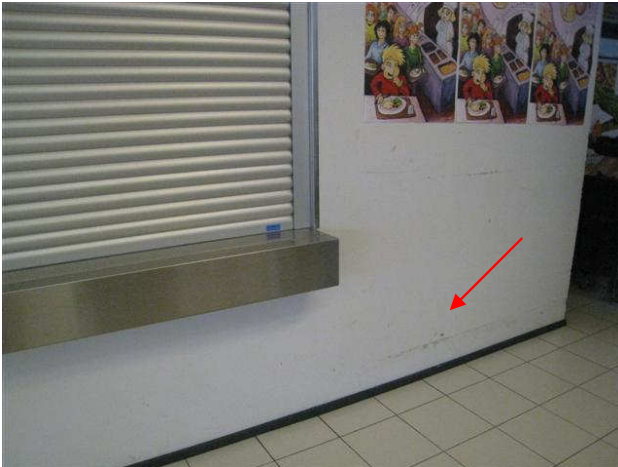
Kuva 43 Ravintolasalin 1.30 ruokalinjaston päässä olevan seinän alaosa on kostea
