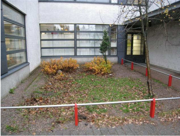
Kuva 31 Rakennussiipien välillä olevat pihat ovat painuneet montulle ja keräävät vettä.
