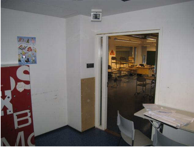
Kuva 13 Kipsilevyrakenteinen putkikotelo 2. kerroksessa/ solu 2.11 on homeessa, rikottu kipsilevy on suojattu vanerilla.
