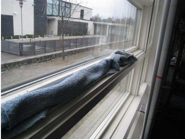
Kuva 19 Musiikkiluokan 1.06 ikkunalla oleva rätti yläpuolisten vesivuotojen varalta.
