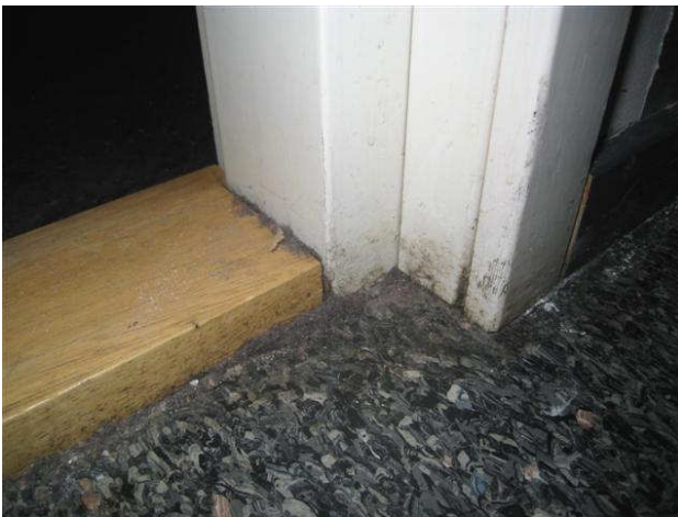
Kuva 45 Siivousjälki on suurpiirteistä, tomua on erityisesti nurkissa, kalusteiden seassa ja tasopinnoilla.
