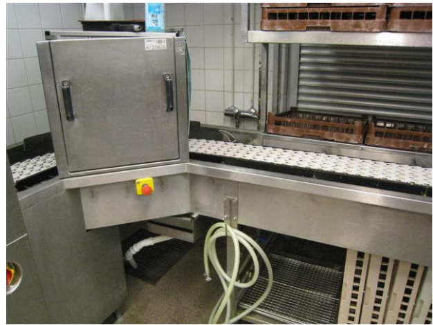
Kuva 44 Ruokalinjaston kostean seinän takana on astianpesulinjasto.
