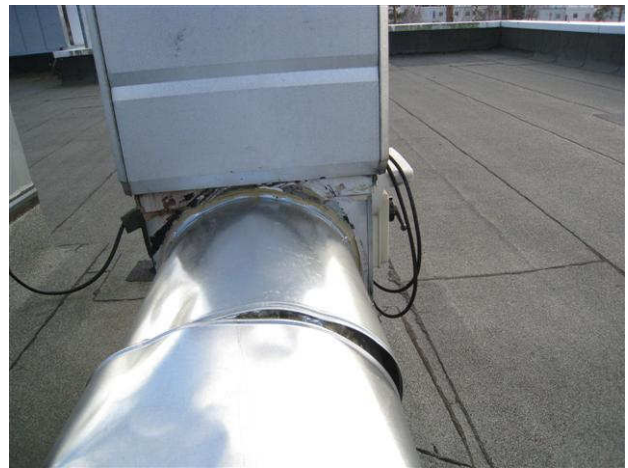
Kuva 8 IV-kanavien lämpöeristysten suojapeltejä on tallottu, raoista pääsee vesi.
