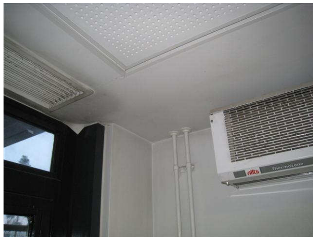
Kuva 22 A-portaan ulko-oven edessä oleva puhallin on likainen ja alakaton kipsilevyssä on kosteusvaurioita ulkop. vuotojen takia.
