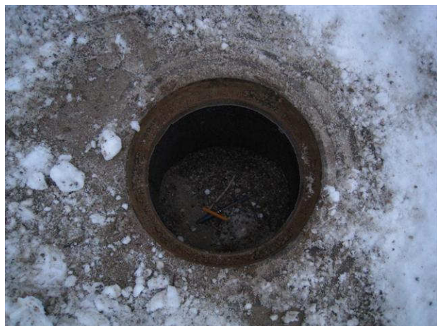
Kuva 30 Opettajien huoneen kohdalla oleva perusvesikaivo on lähes täynnä hiekoitusso- raa. Kaivon putkitilannetta ei voitu tutkia
