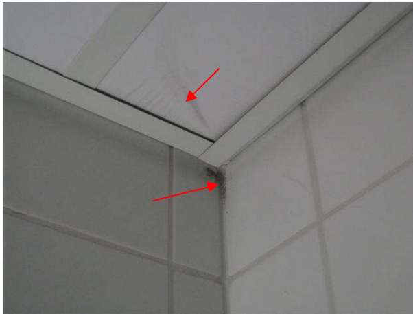
Kuva 27 Ilmavuotojälkiä wc-tiloissa käytävän 1.31 vieressä.
