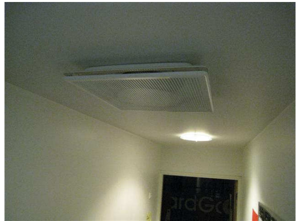
Kuva 26 Tuloilmahajotin käytävän 1.31 katossa.
