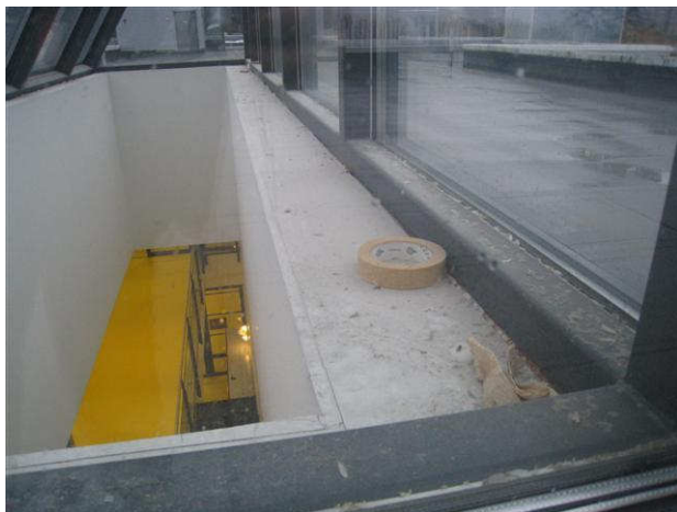
Kuva 5 Kattolyhtyjen tasopinnoilla on pölyä ja paikoin vuotojälkiä.
