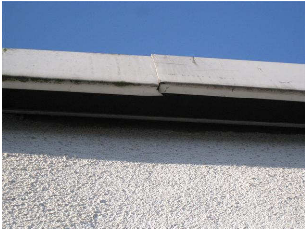
Kuva 9 Räystäspelttien väli on aivan liian iso ja välistä pääsee vesi ja lumi tuulella.
