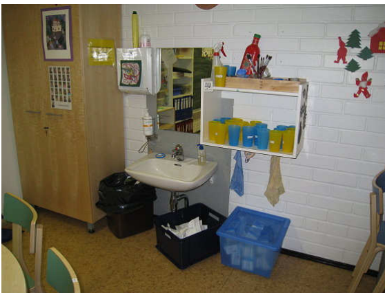
Kuva 17 Lattian pintakosteus on normaalia korkeampi vesipisteen edustalla huoneessa LH-3.
