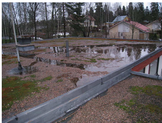
Kuva 5 Sadevedet kerääntyvät katon eteläkulmaan.
