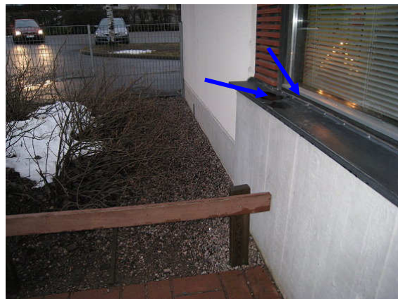
Kuva 18 Ikkunoiden vesipeltien kallistukset ovat puutteelliset. Ikkunan ja alalistan välit vaikuttivat epätiiveiltä.
