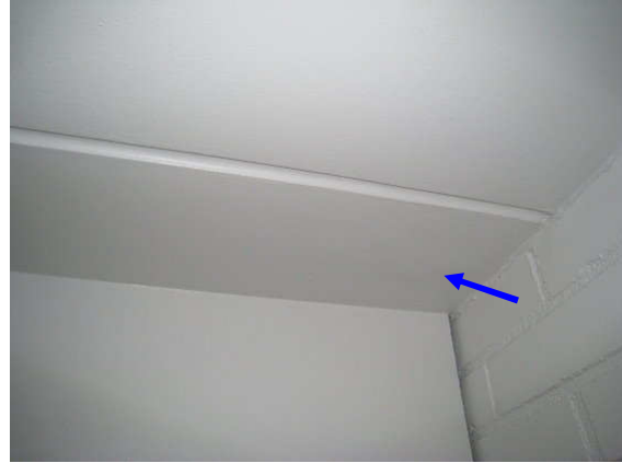
Kuva 8 Lasten WC-/ KPH -tilan katossa kattovuodon aiheuttama kupru.
