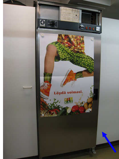
Kuva 14 Pakastinkaapin oikean puoleisen kaapin sisäpuolelle tiivistyy ajoittain kosteutta (kts. kuva 15).
