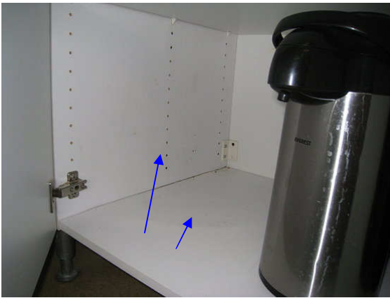
Kuva 15 Kuvan 14 kaappi sisäpuolelta.
