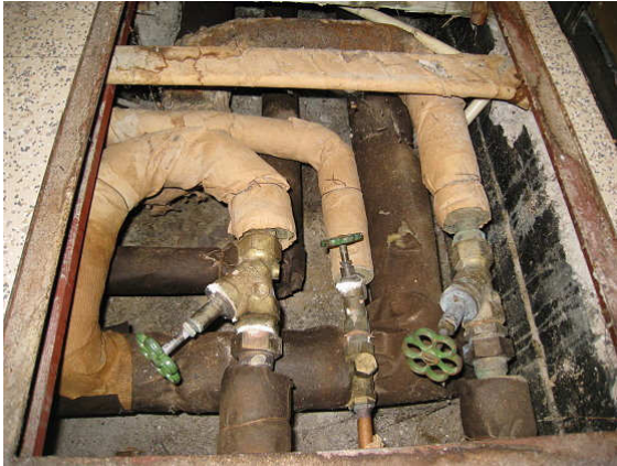
Kuva 19 Putkikanaalin luukut eivät ole kaasutiiviit. Luukkujen ympärillä on puutavaraa.
