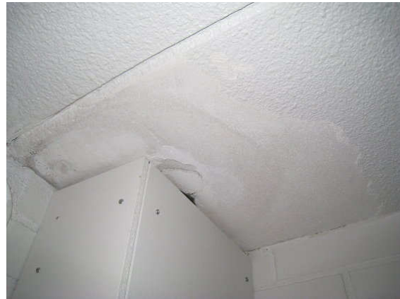
Kuva 10 Sk-tilan katossa on vanha vesivuotojälki.
