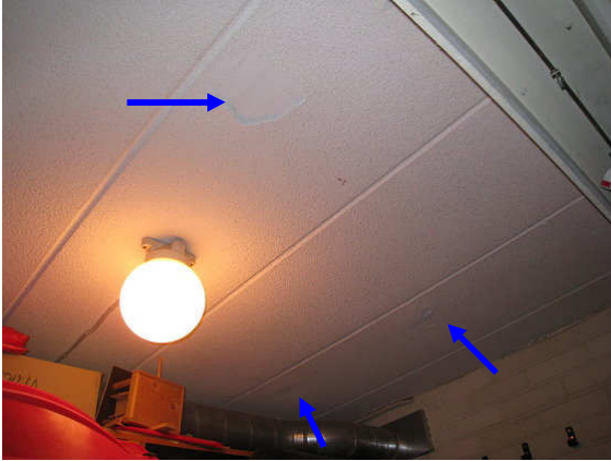
Kuva 7 Varaston katossa on kattovuodon aiheuttamia vaurioita.
