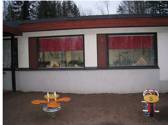
Kuva 2 Pihajulkisivulla sokkelin viereinen maanpinta on montulla.
