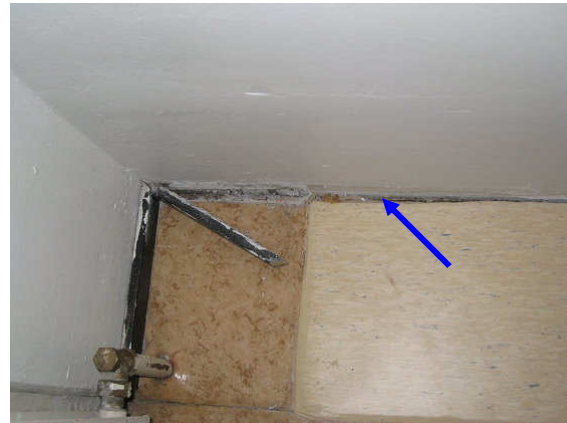
Kuva 4 Huoneessa LH-2 lattian ja jalkalistan välissä on rako, josta virtaa korvausilmaa sisätiloihin.
