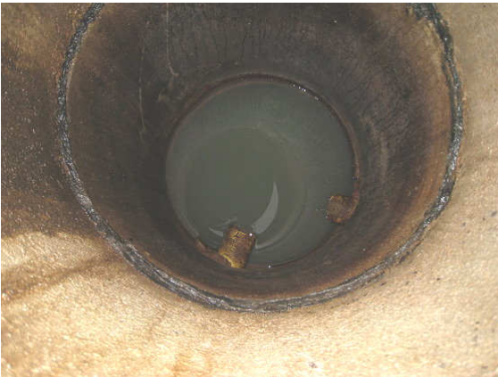
Kuva 3 Salaojan tarkastuskaivossa veden pinta on putken juoksupinnan tasolla.
