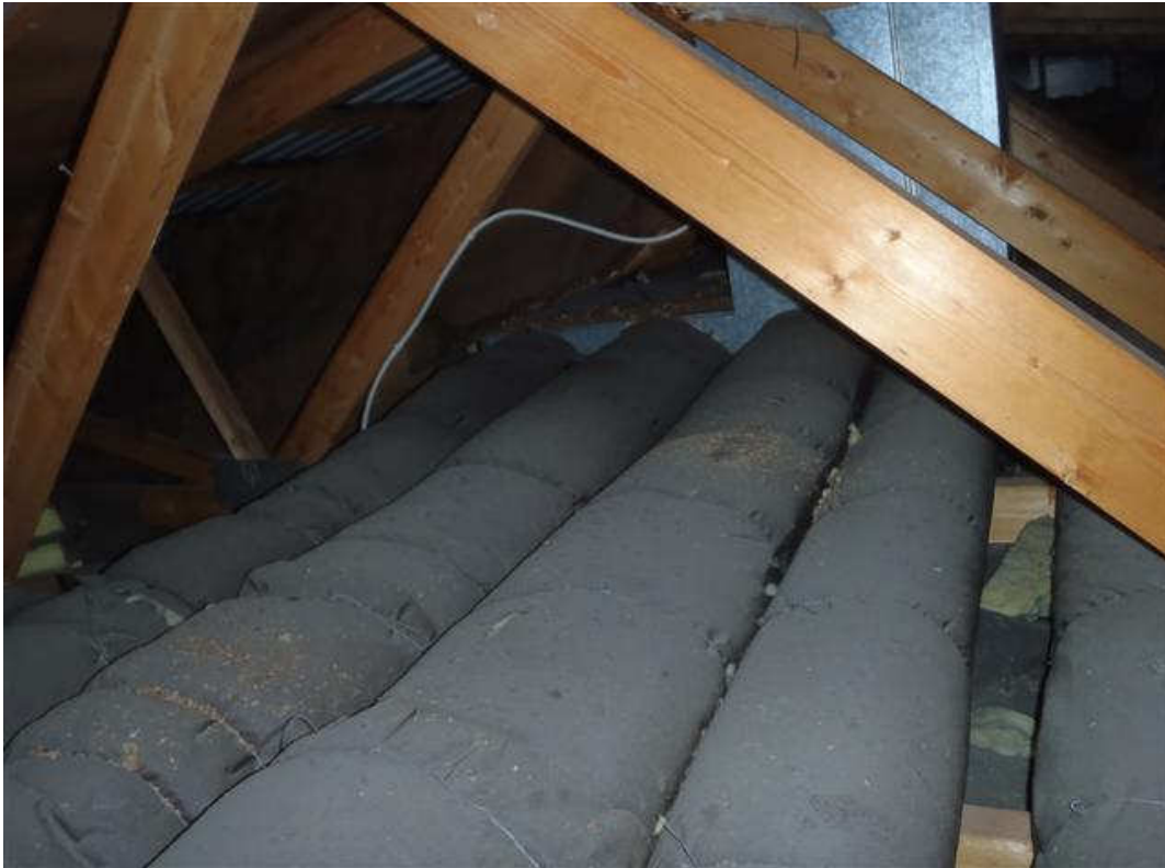
Kuva 5. Yläpohjassa kulkevia poistokanavia.
