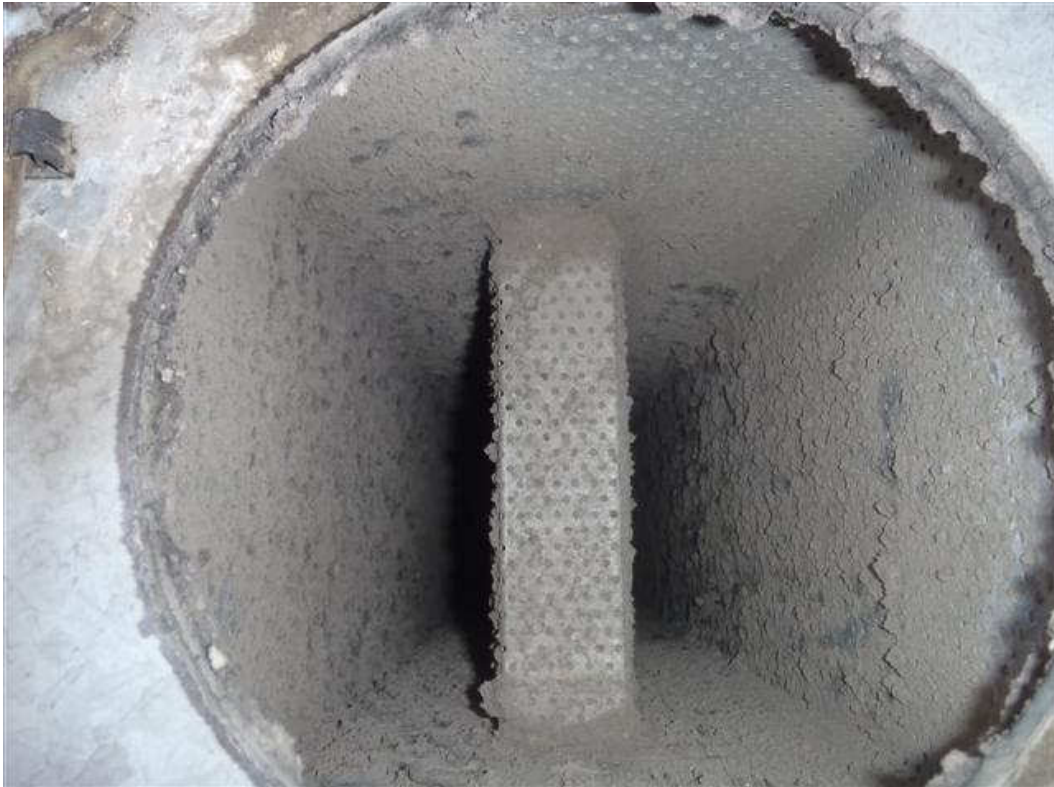
Kuva 3. Keittiön poistoilmakanavaa kuvattuna vesikatolta.
