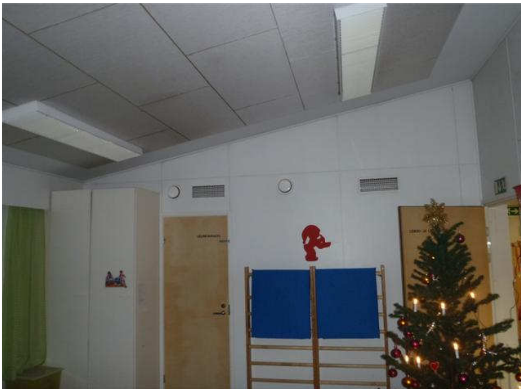
Kuva 4. Leikki- ja lepohuoneen (33,8 m 2 ) ilmanvaihdon pääte-elimet.
