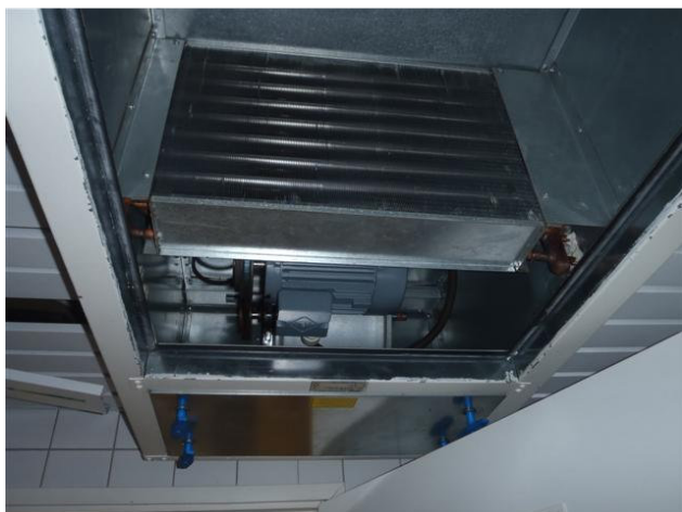
Kuva 1 Tuloilmakoneen lämmityspatterin ja puhallin ovat puhtaita.
