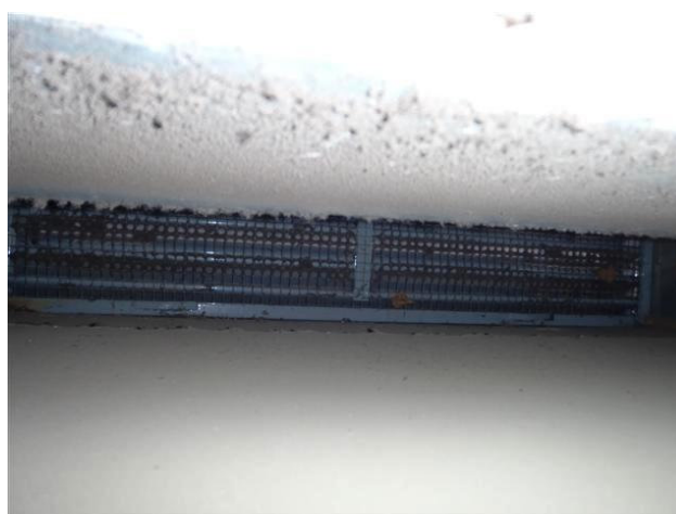
Kuva 4 Raitisilmäsäleikkö ja -kanava olisivat syytä puhdistaa.
