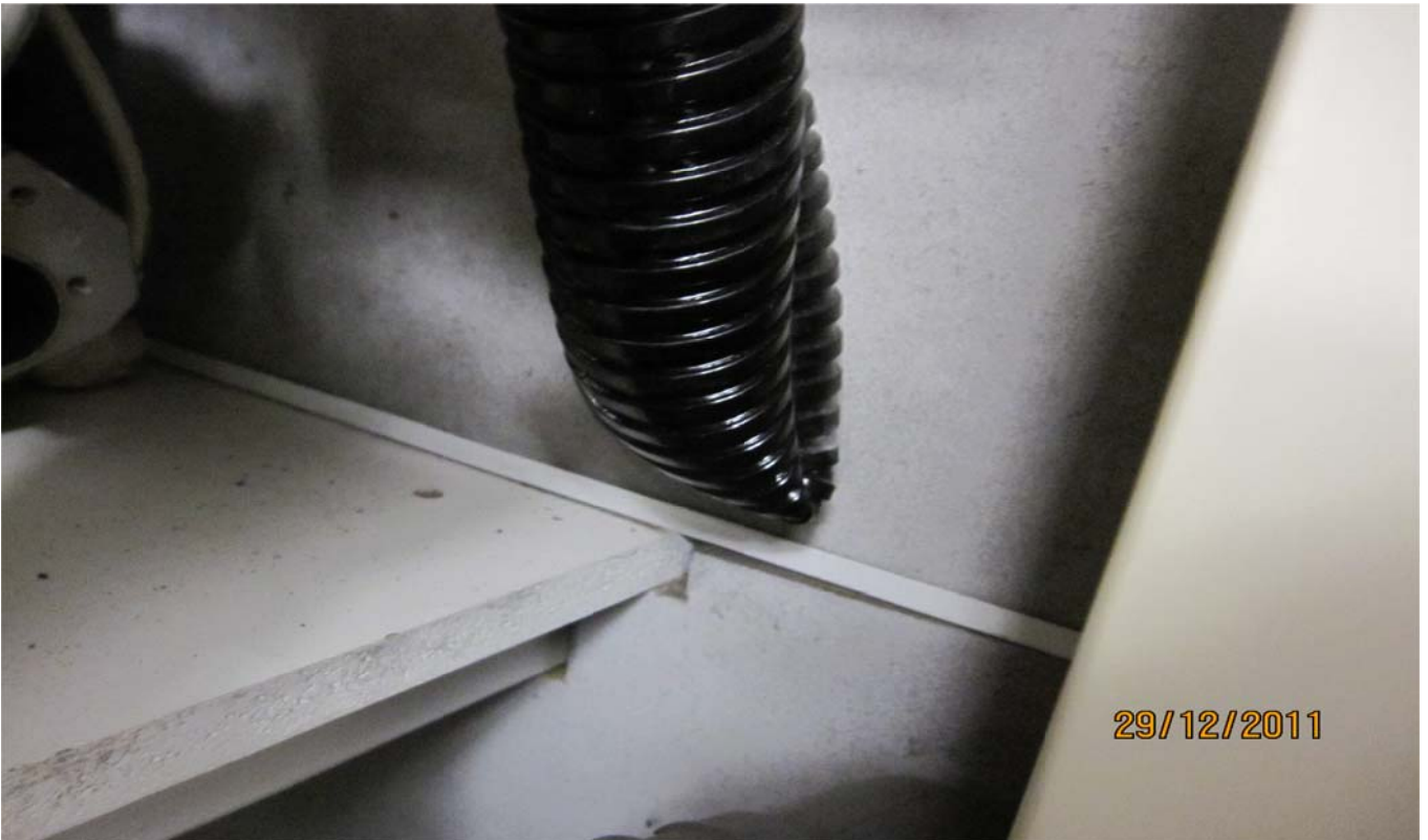
Kuva 3 Taittunut suuimurin putki
