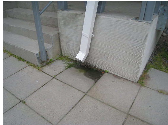
Kuva 16 Kattoveden ohjaus puutteellinen sisäänkäyntien kohdilla.
