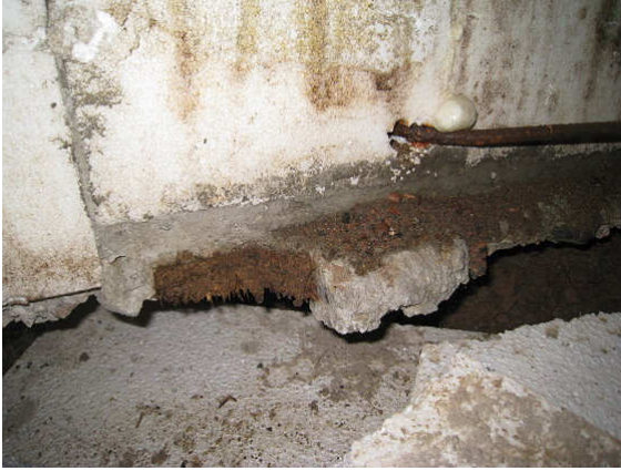
Kuva 7 Perustuspalkkien alla kosteus- ja mikrobivaurioituneita alasiladelautoja.
