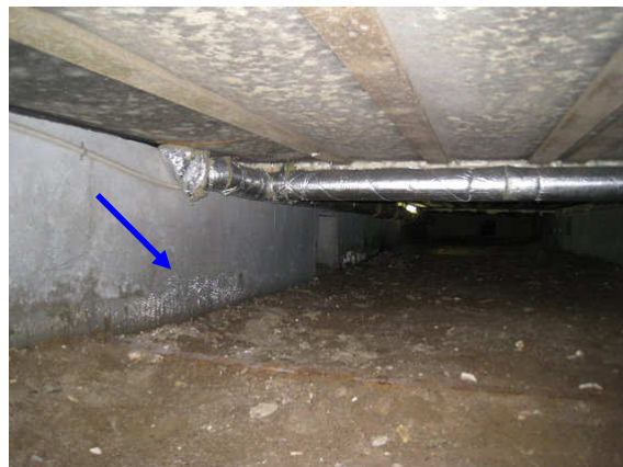
Kuva 6 Perustuspalkkien alaosat ovat märät ja pinnoilla helmeili vesipisaraita.
