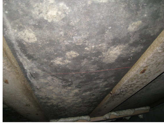
Kuva 8 Bituliittilevyn ja lautojen pinnoilla runsasta mikrobikasvustoa.
