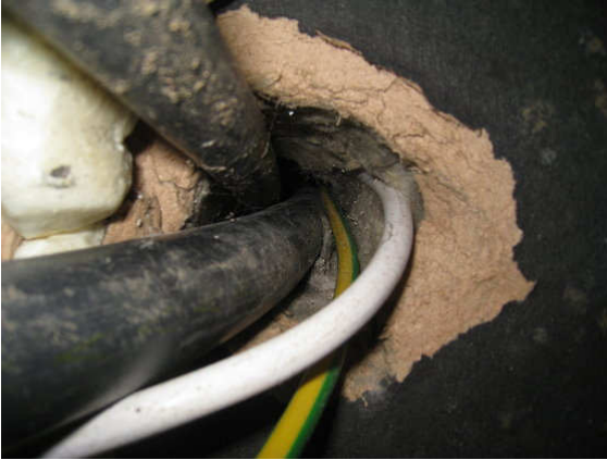
Kuva 13 Tiivistämätön läpivienti sähköpääkeskukseen.
