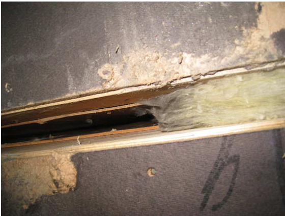
Kuva 9 Rakennusosien tiivistämätön liitoskohta lounaan puoleisella osalla.
