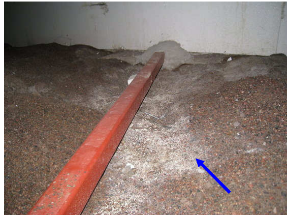
Kuva 4 Tukirakenteiden kohdalla täyttökerros on pieni ja pinnalla on mikrobikasvustoa.
