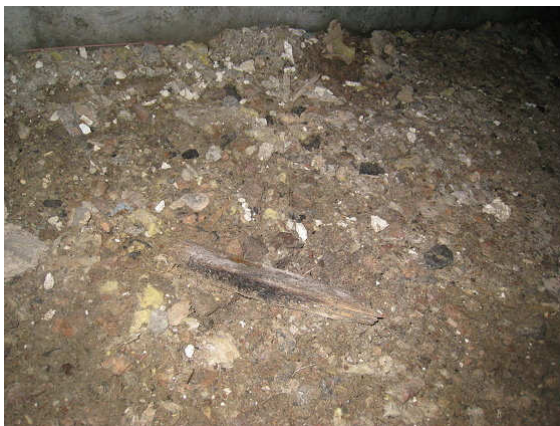
Kuva 5 Koillispuoleisella osalla on kostea hiekkaa ja pinnalla on kosteus- ja mikrobivaurioituneita puun ja lastulevyn kappaleita.
