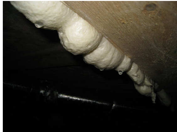
Kuva 10 Polyuretaanivaahdon pinnalla on vesipisaroita.
