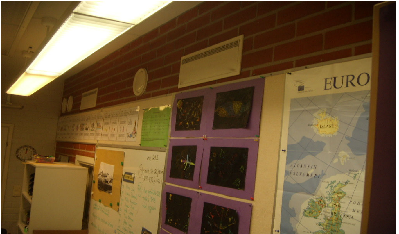
KUVA 24. Luokkahuoneiden valaisimia on osin asennettu heittokuvioiden eteen.
