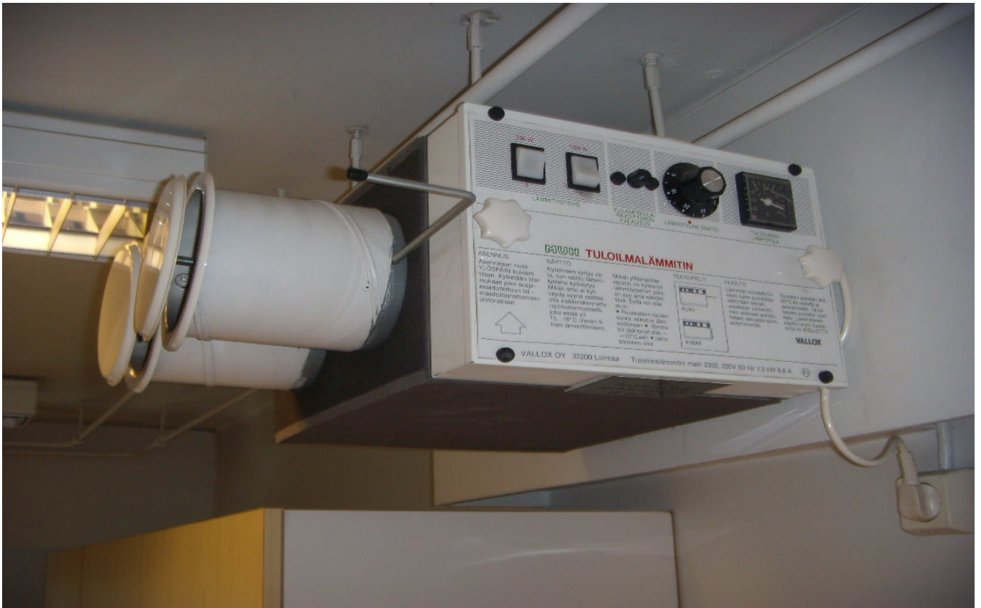
KUVA 18. Yleiskuva hammashoitolan tuloilmalämmittimestä.
