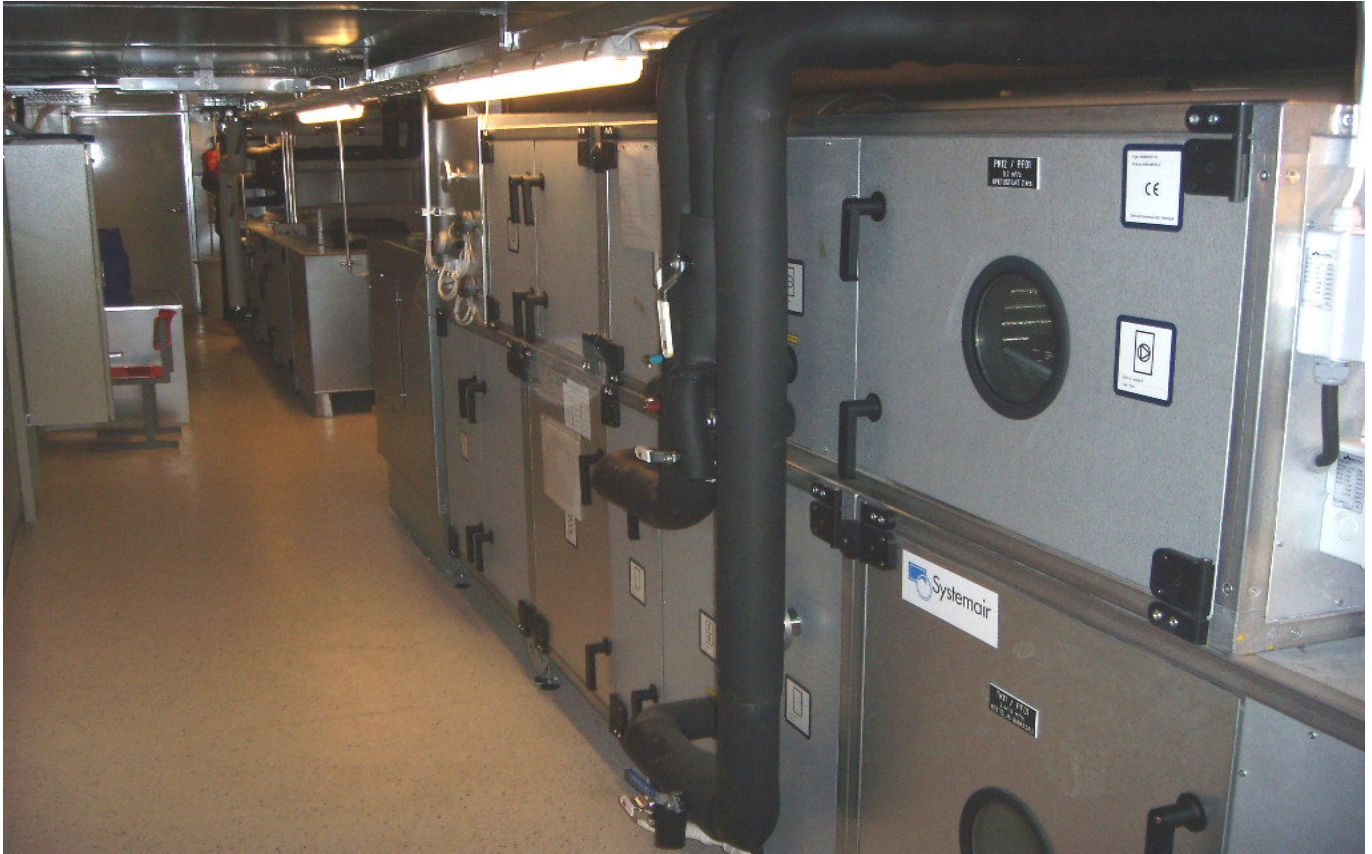
KUVA 1. Yleiskuva IV- konehuoneesta.
