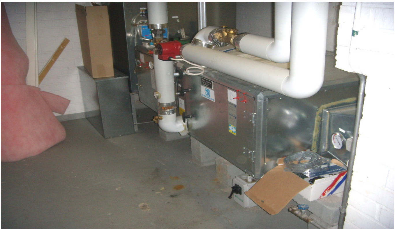
KUVA 2. Yleiskuva IV- konehuoneesta.
