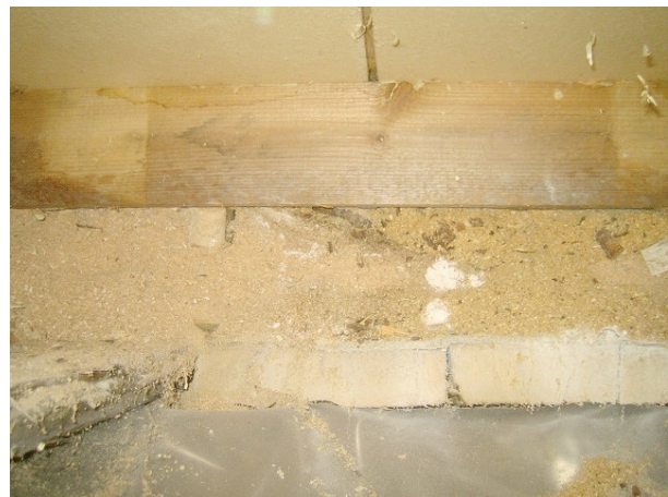
Kuva 2 Lattia on joskus aukaistu, aukon osalla ei ollut eristeitä. Muovit tulee poistaa.
