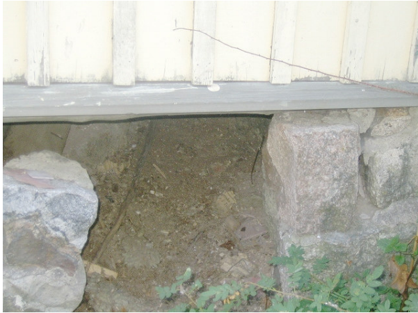
Kuva 5 Kunnolliset kulkuluukut puuttuivat
