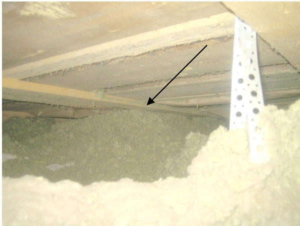
Kuva 3 Päärakennuksen puoleinen pääty. Maapohjan päällä oli paljon puhallusvillaa. Villa tukki osittain lattian tuuletuksen. Alapohjan lautarakenne oli uudempaa.
