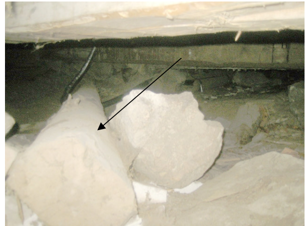
Kuva 4 Päärakennuksen puoleisessa päässä oli yksi kannatinhirssi pudonnut.
