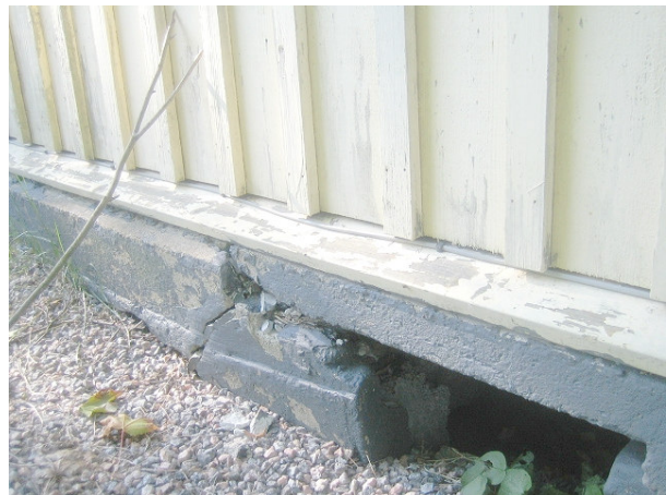
Kuva 6 Kadunpuoleinen sokkeli oli liikkunut ja sitä oli korjattu betonilla. Kuvassa näkyy ahdas "tarkastusaukko"
