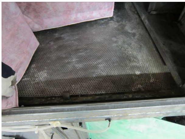
Kuva 2. Suodatinosassa on kosteuden jättämiä jälkiä.
