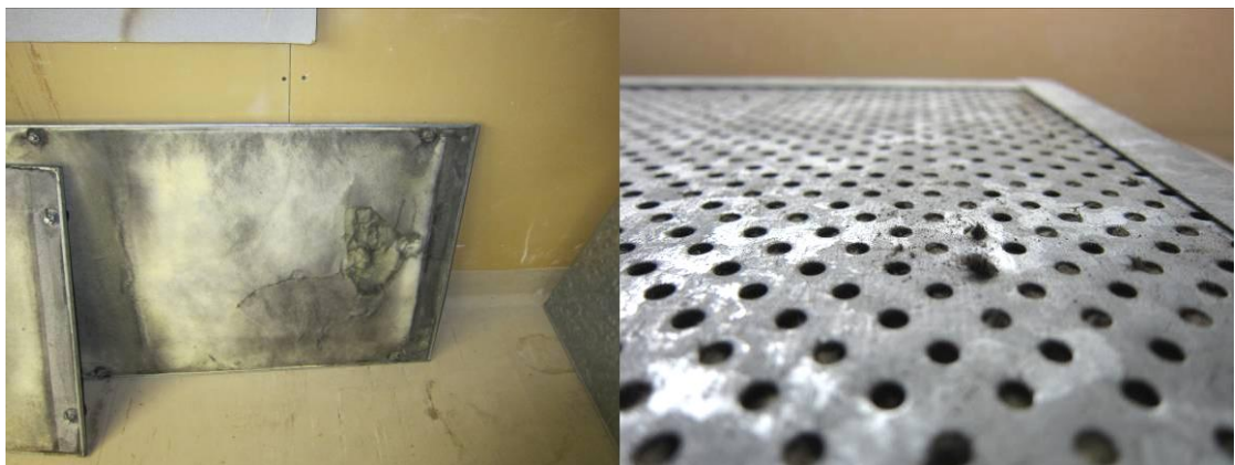
Kuvat 7-8. Tuloilmakammio on päällystetty mineraalivillalla, joka on osittain päällystetty reikäpellillä. Villapinnat ovat paikoin rikkoutuneet.
