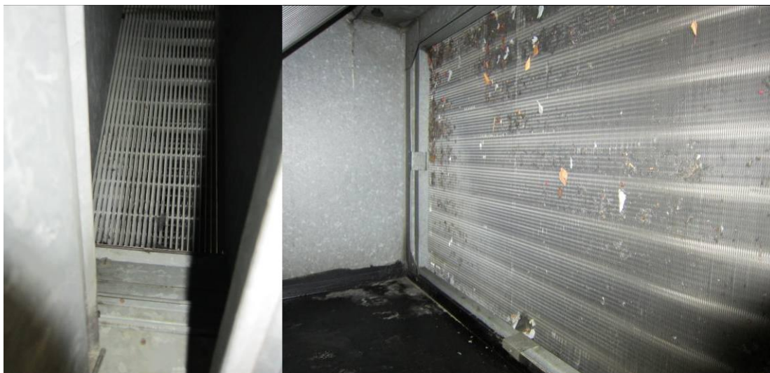
Kuvat 3-4. Ilmanvaihtokoneen LTO- kuutiosta ja lämmityspatterissa on havaittavissa pölyä ja roskaa.
