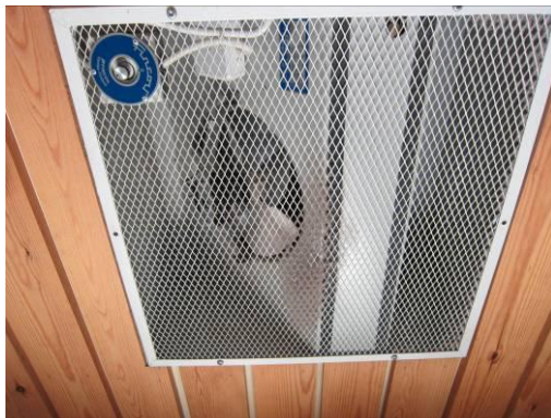
Kuva 18. Yleiskuva tuulikaapin kiertoilmakoneesta.
