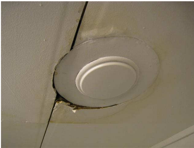
Kuva 35 Länsipäädyn IV-poistokanavan juuri on vuotanut harjan lähellä.
