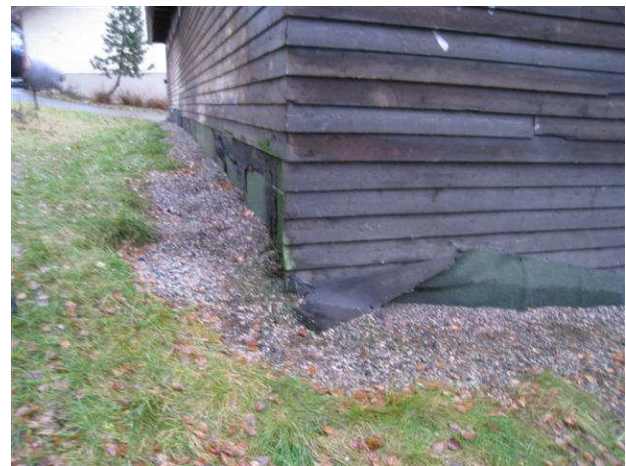
Kuva 48 Puuvuoraus on maata vasten, maasto viettää kohti huoltorakennusta.
