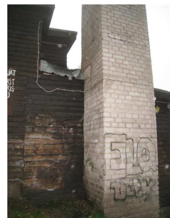
Kuva 50 Vesikatto on rikki huoltorakennuksen piipun kupeesta.
