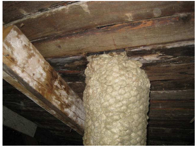
Kuva 28 Pohjoislappeen itäpäädyn IV-puhaltimen juurivuoto, jossa puu on jo lahoa.
