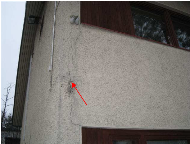
Kuva 5 Ulkoseinän halkeama lounaiskulmalla
