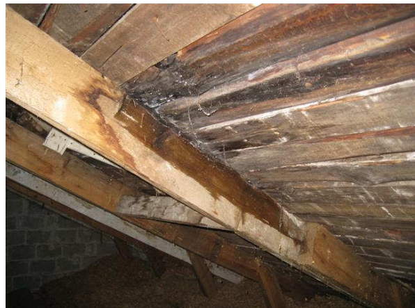
Kuva 32 Ullakon sivuontelossa itäpäädyn etelälappeella on vesivuotoa ja vaurioita.
