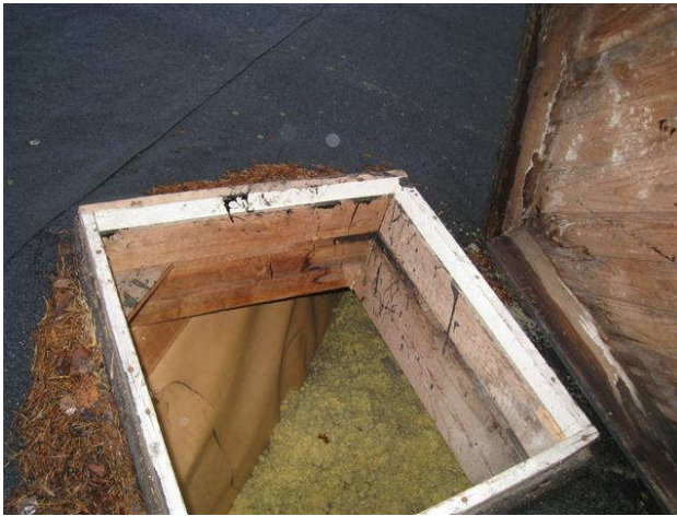
Kuva 23 Pohjoislappeen länsipäädyn luukku, jonka kehys kastuu.
