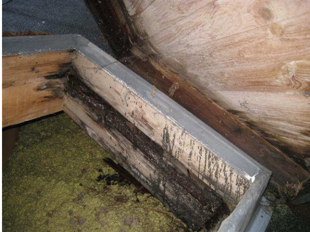
Kuva 21 Etelälapteen länsipäädyn luukun reunasta on vesivuotoa
