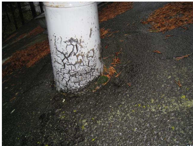
Kuva 17 Kulunut vesikate ja vuotoriski läpiviennissä.
