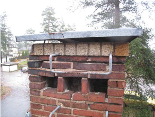
Kuva 15 Kulunut piipun pää on hauras.
