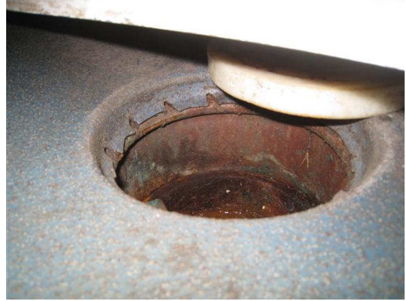
Kuva 40 Lattiakaivon kiristysrengas puuttuu.
