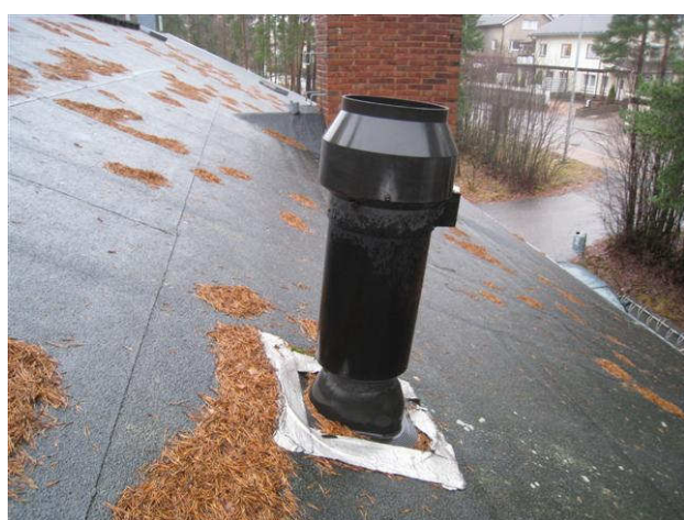
Kuva 14 Tämän IV-puhaltimen juuriliitos ei ole tiivis. On teipattu katteen päälle ks 28.
