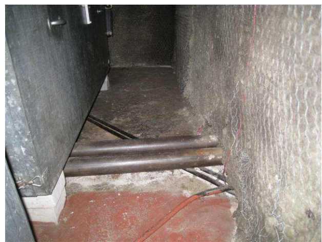
Kuva 36 Ullakon länsipäädyn IV-kojetilan lattiasa ei havaittu vesieristettä.
