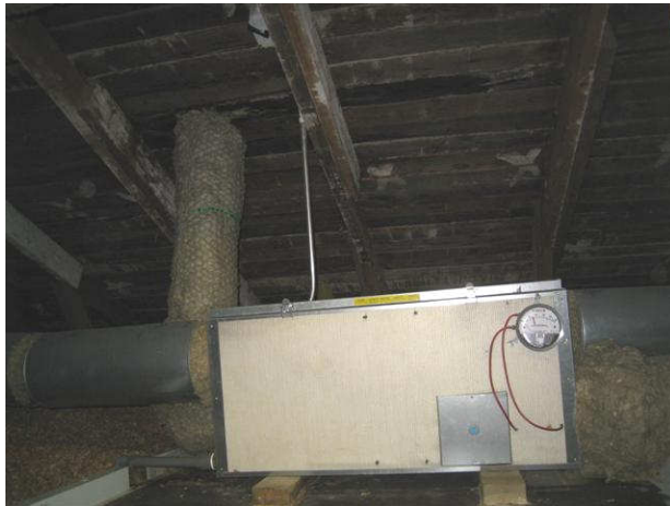
Kuva 29 Ullakon sivuontelo pohjoislappeen alla, jossa on IV-koje, ei ollut päällä.
