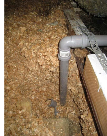
Kuva 30 IV-kojeen poistovesiputken liitos oli auki, tästä vesivuotoa toimistotilan katossa.
