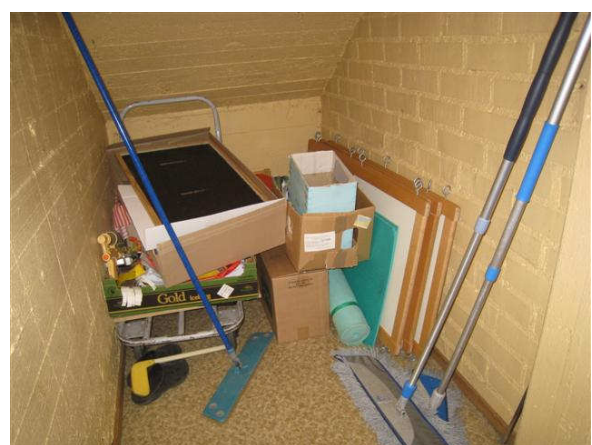
Kuva 38 Pohjakerroksen/ kellarin portaan alla varastotilan lattian kosteudet koholla ja on selvä mikrobivaurioon viittaava haju.
