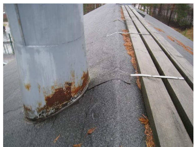
Kuva 18 Kattosiltojen kiinnitys on tehty naulaten huovan läpi. Juuriliittymä on huono.
