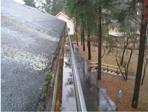
Kuva 27 Rännit ovat ruosteessa.
