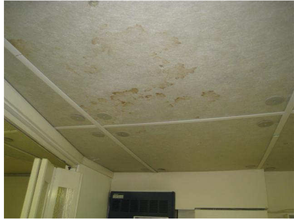
Kuva 34 Vesivuotojälkiä itäpäädyn tilojen katossa.
