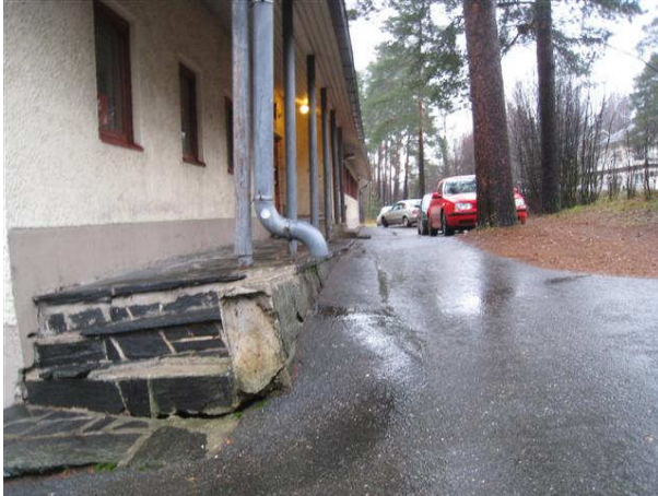
Kuva 3 Pohjoissivun terassi on vääntynyt, pintakallistukset ovat kohti taloa.
