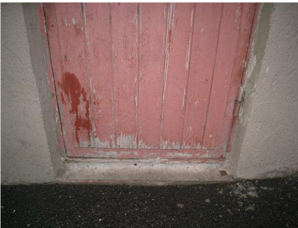
Kuva 7 Kulunut ulko-ovi, josta puuttuu potkupelti.
