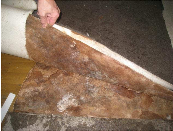
Kuva 51 Huoltorakennuksen eteistilan lattiassa on paha mikrobivaurio.
