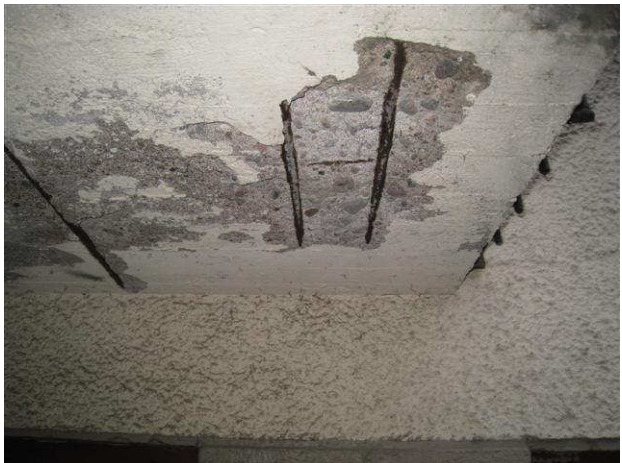
Kuva 12 Parvekelaatan alapinnassa olevat teräkset ovat ruosteessa.
