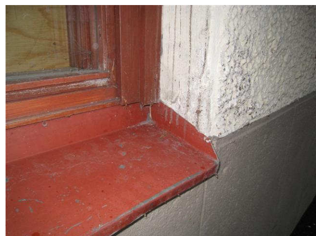
Kuva 8 Ikkunat ovat kuluneet ulkopinnoiltaan.
