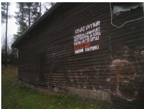
Kuva 49 Huoltorakennuksen julkisivuverhouksen on kulunut.
