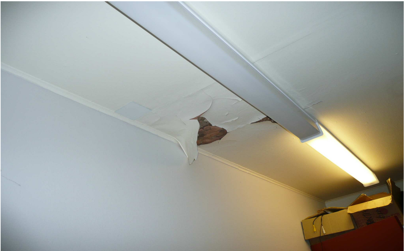
RAK- kuva 13. Toimistuhuoneen katossa on kosteuden aiheuttama vaurio.
