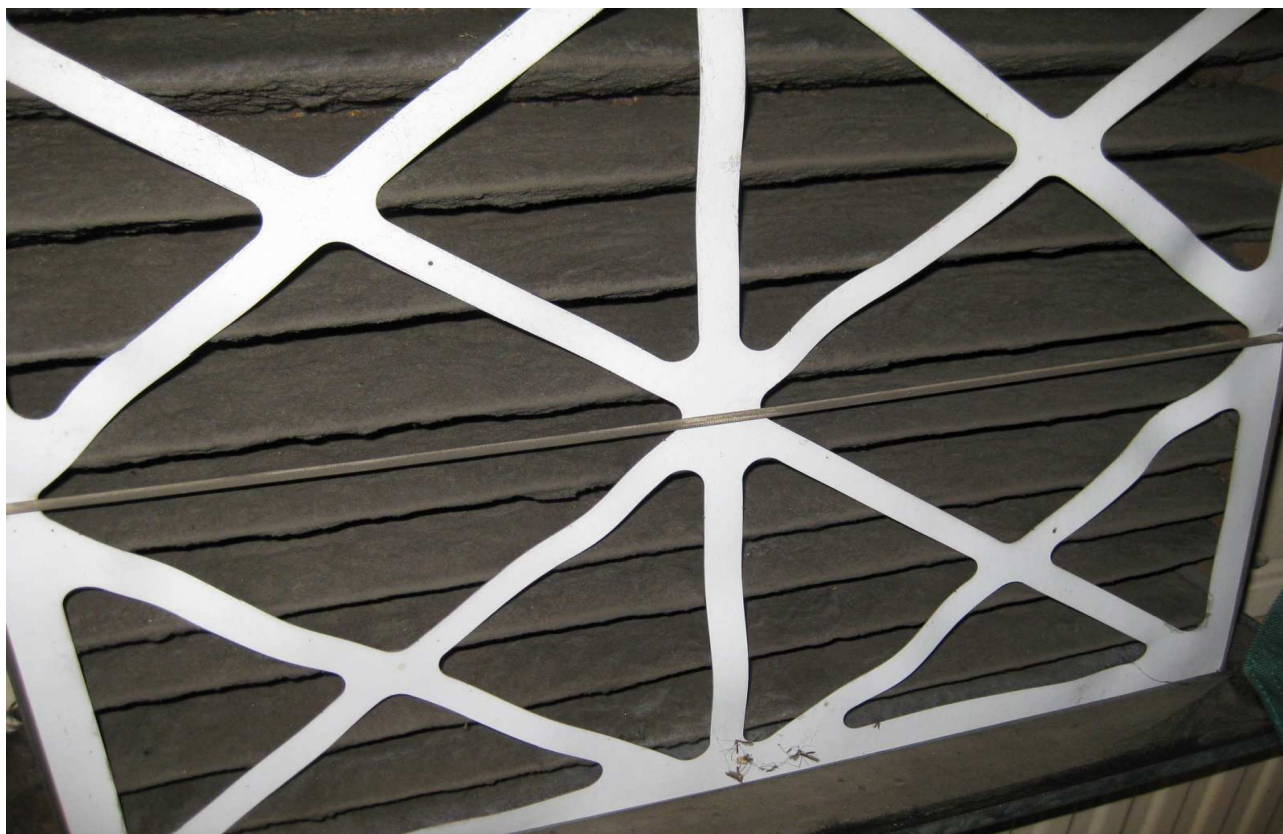
LVI- kuva 11. Yleiskuva tuloilmasuodattimista.
