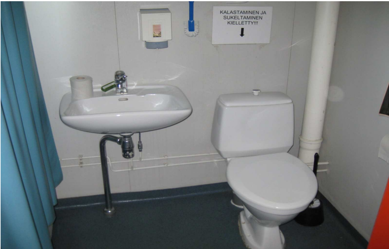
LVI- kuva 7. Yleiskuva vesikalusteista.
