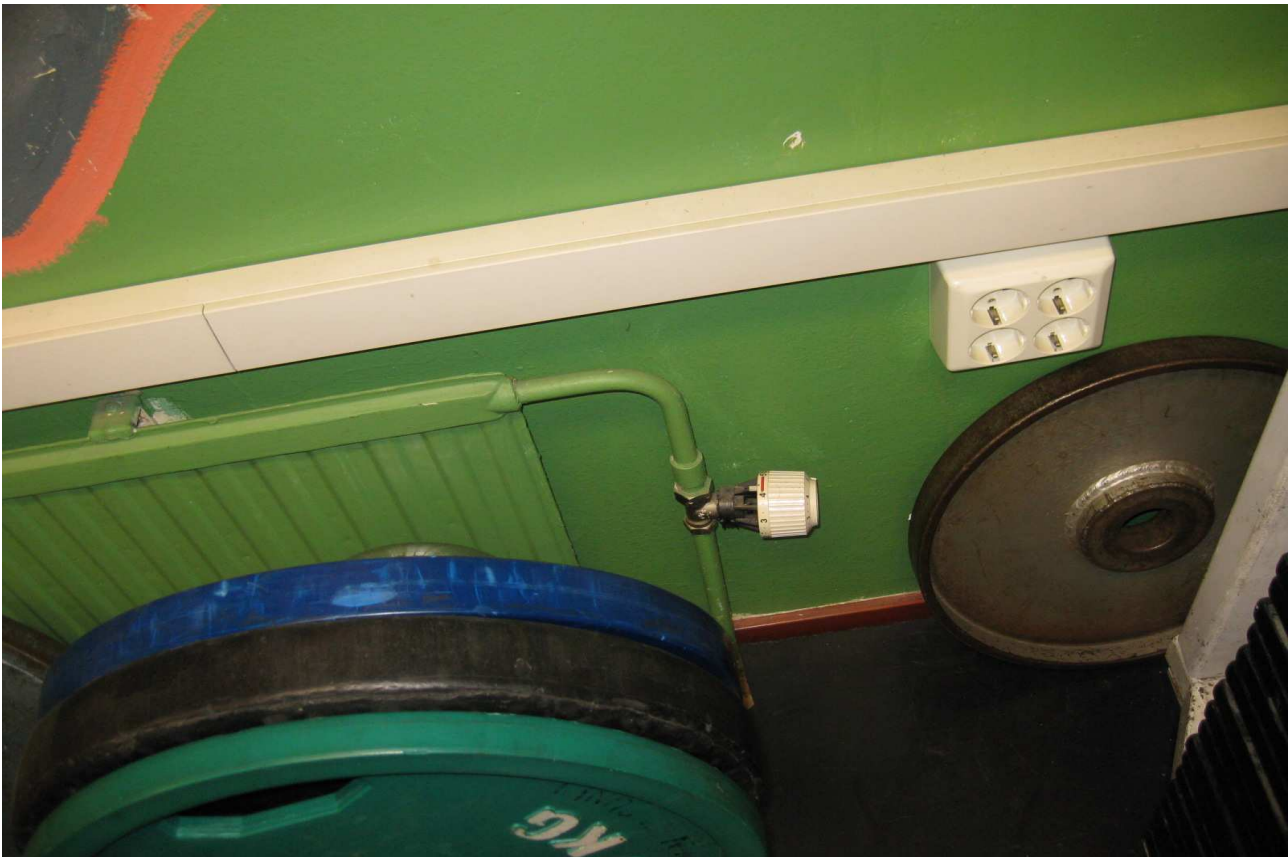
LVI- kuva 3. Yleiskuva patteriventtiilistä.
