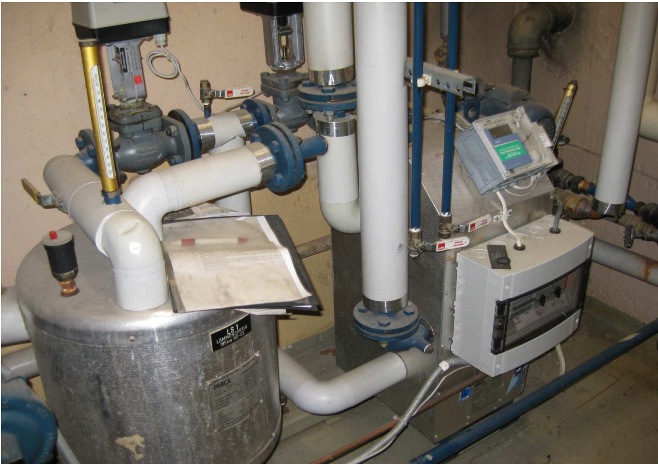
LVI- kuva 1. Yleiskuva lämmönjakuhuoneesta.
