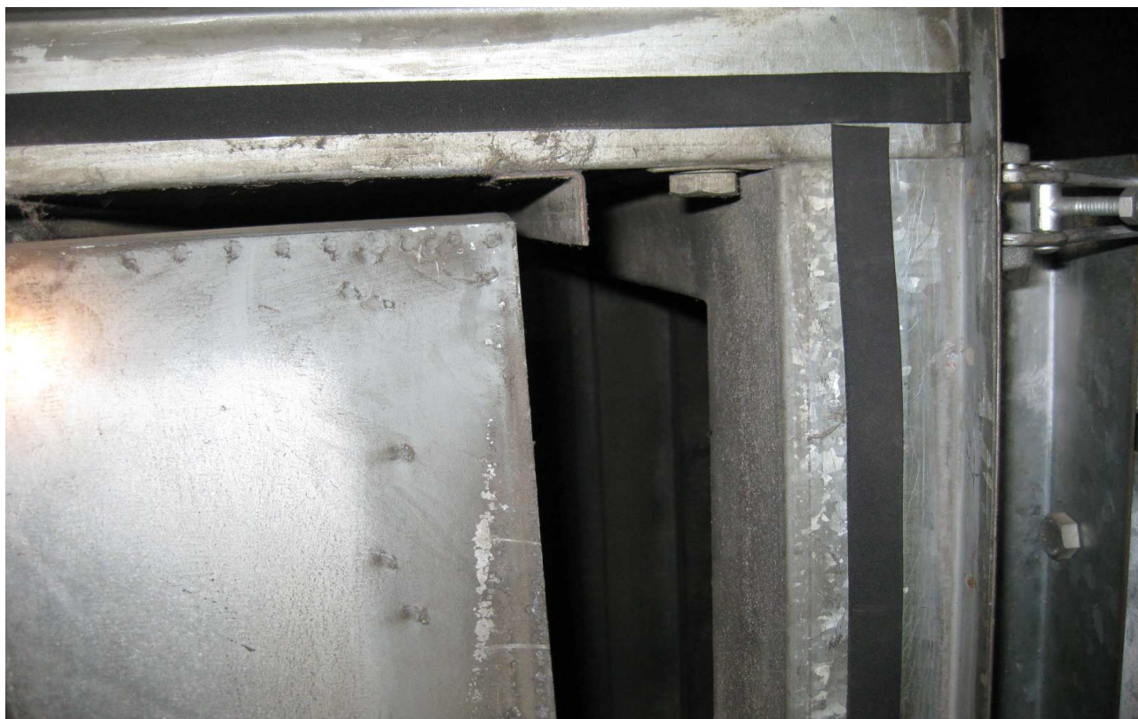
LVI- kuva 13. Yleiskuva tuloilmasuodattimen kehikosta.
