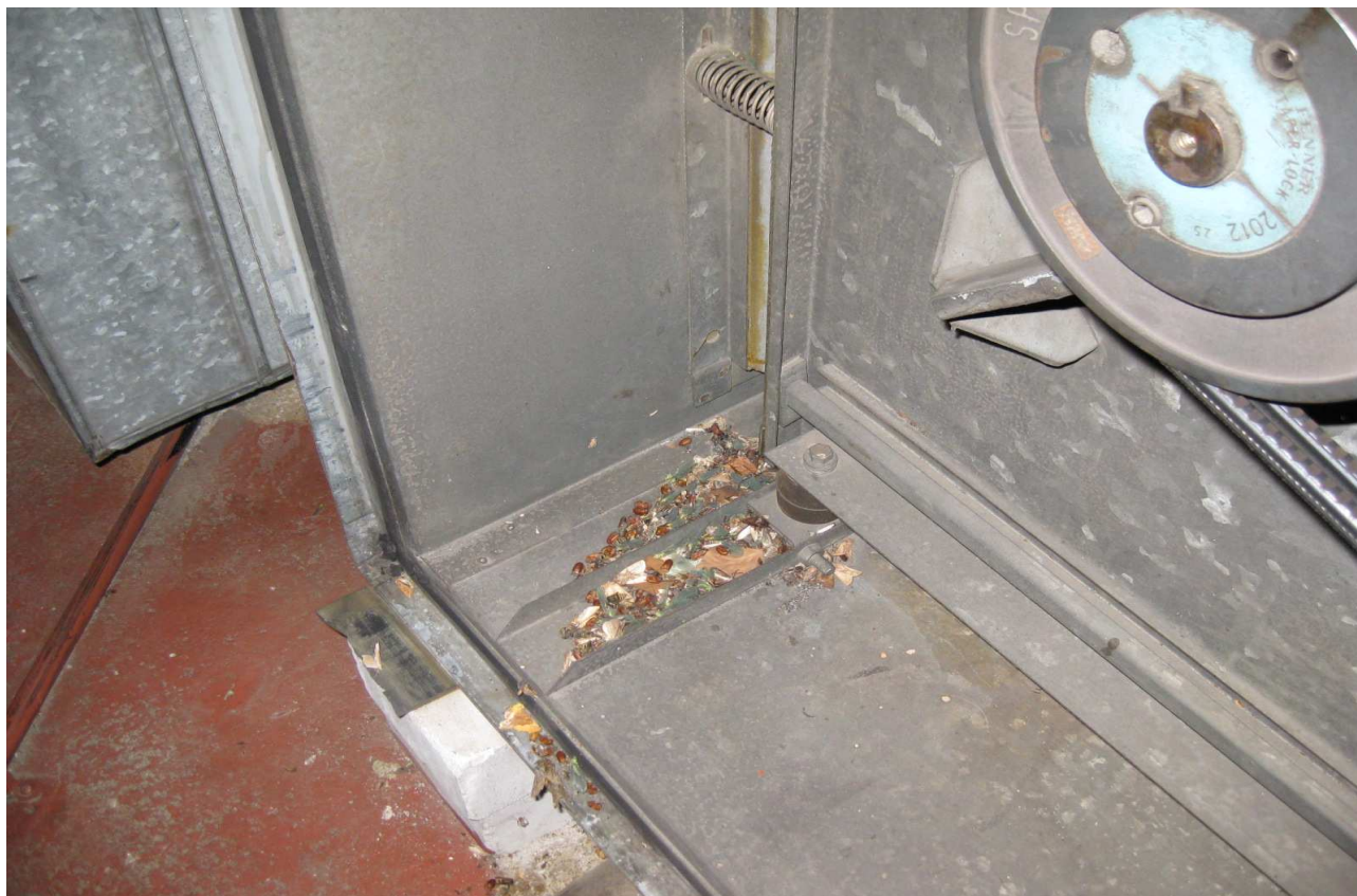
LVI- kuva 14. Yleiskuva tuloilmakoneen kammiosta.
