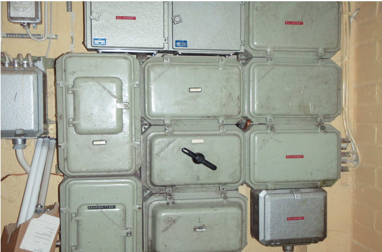
S- kuva 3. Sähköpääkeskus.
