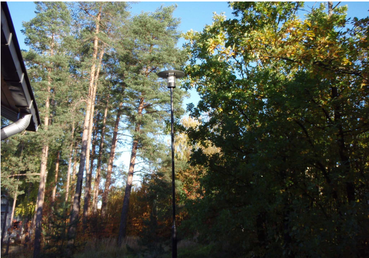
S- kuva 2. Pylväsvalaisin.
