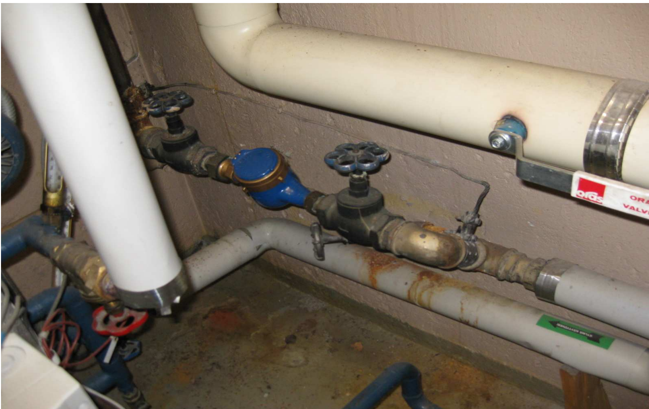
LVI- kuva 4. Yleiskuva vesimittarista ja pääsuluista.
