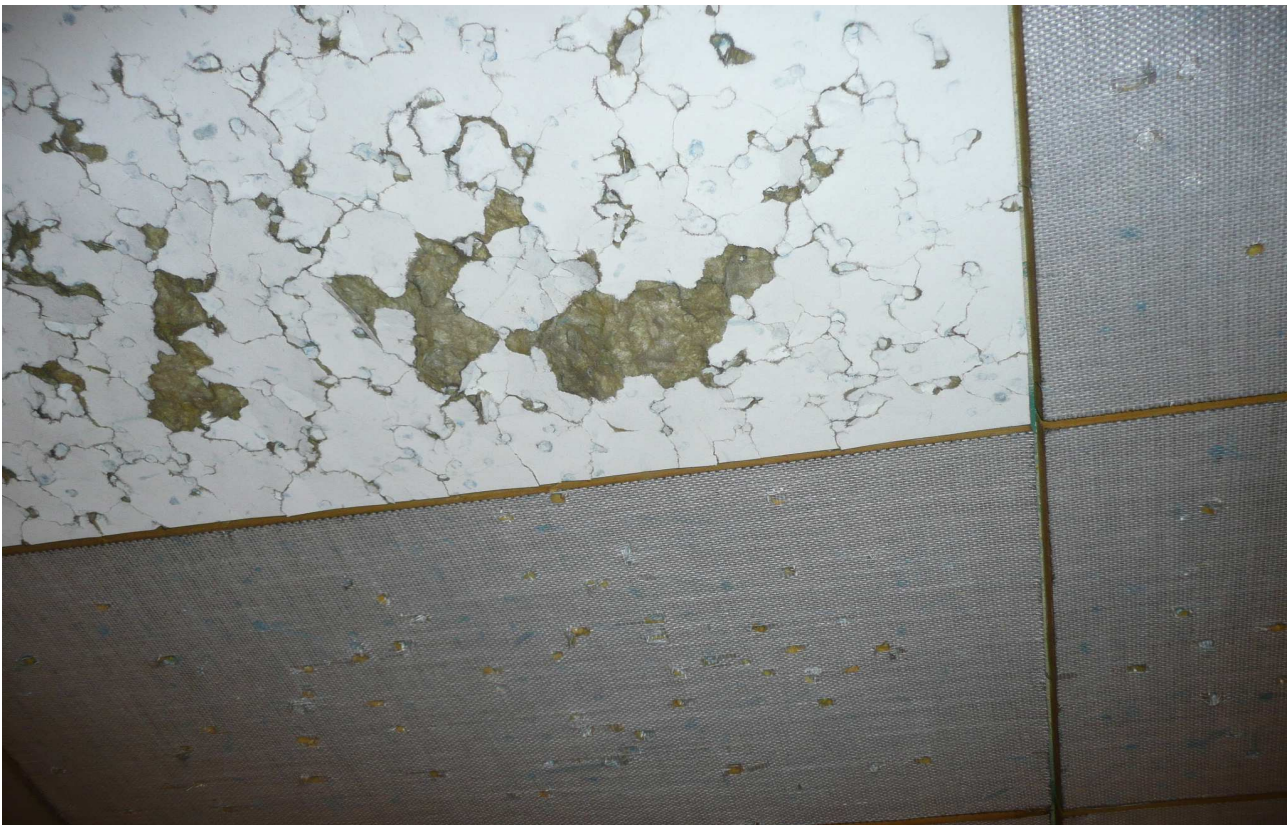
RAK- kuva 14. Akustovillalevyt ovat vaurioituneet.
