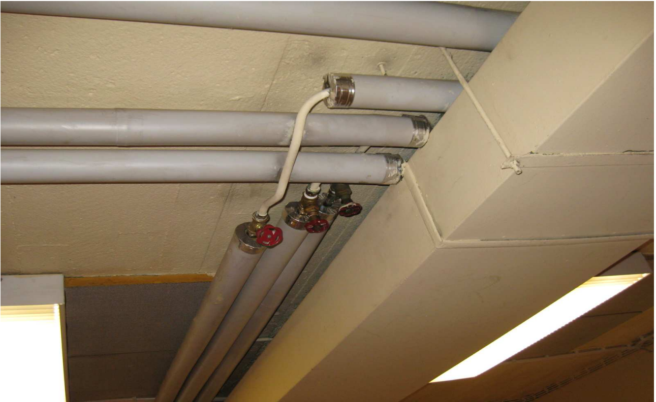
LVI- kuva 5. Yleiskuva käyttöveden sulku- ja säätöventtiilistä.
