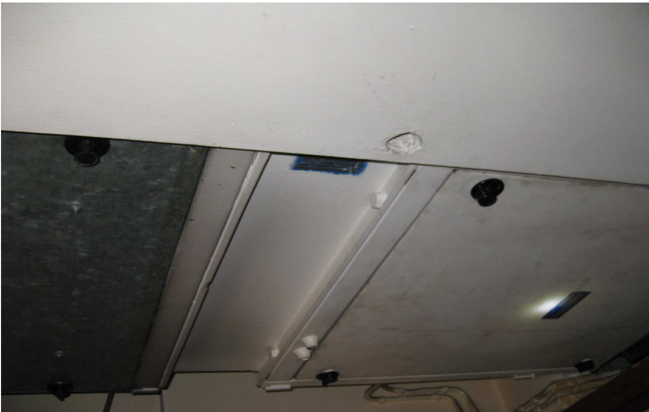
LVI- kuva 8. Yleiskuva toimistuhuoneita palvelevasta IV- konehuoneesta.
