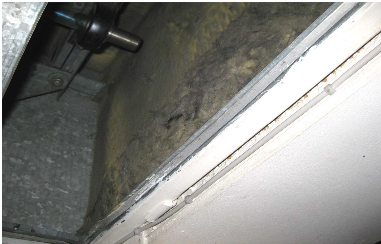
LVI- kuva 12. Yleiskuva tuloilmakammioista, joka on eristetty mineraalivillalla.
