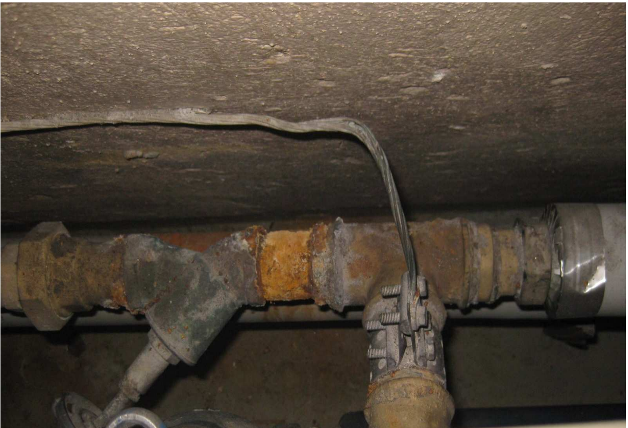
LVI- kuva 6. Kylmävesiverkostossa on heikkokuntoinen kohta, joka tulisi korjata.
