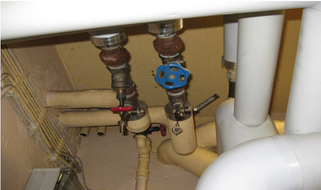
LVI- kuva 2. Yleiskuva lämpöjohtoverkoston venttileistä.
