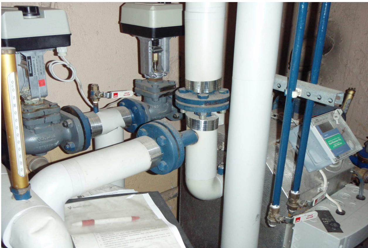
S- kuva 14. Lämmitysjärjestelmän moottoriventtiilit.
