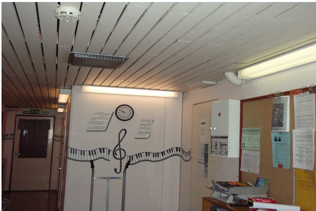
S- kuva 9. Käytävä ja aulatilojen valaisimet.
