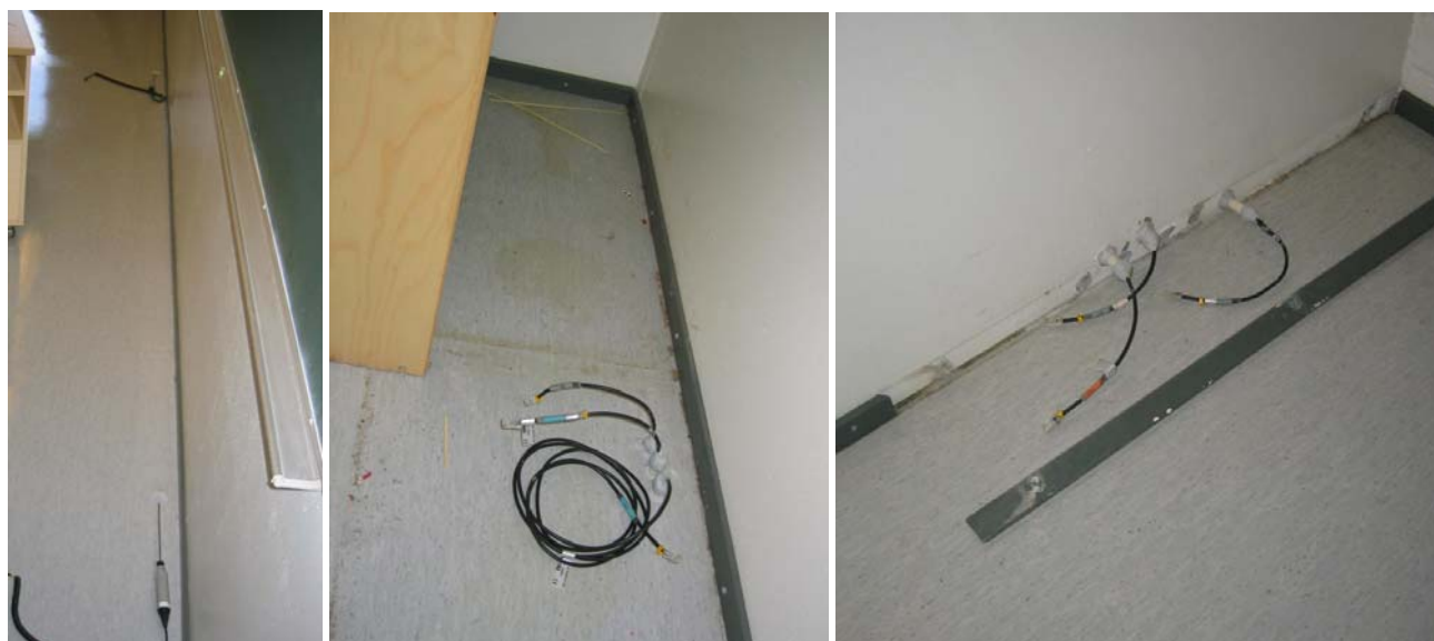
Kuva 12. Luokan 003 rakennekosteusmittaukset: vasemmalla muovimaton alapuolinen viiltomittaus, keskellä lattian porareikämittaus ja oikealla seinän alaosan porareikämittaus. Keskimmaisessä kuvassa näkyy huoneen ulkonurkassa oleva kaappi, jonka alle päässyt vesi (todennäköisesti lattian pesemisestä tullutta) on aiheuttanut jälkiä mattoon ja kaapin sileään alapintaan, joka on suoraan kiinni lattiassa.
