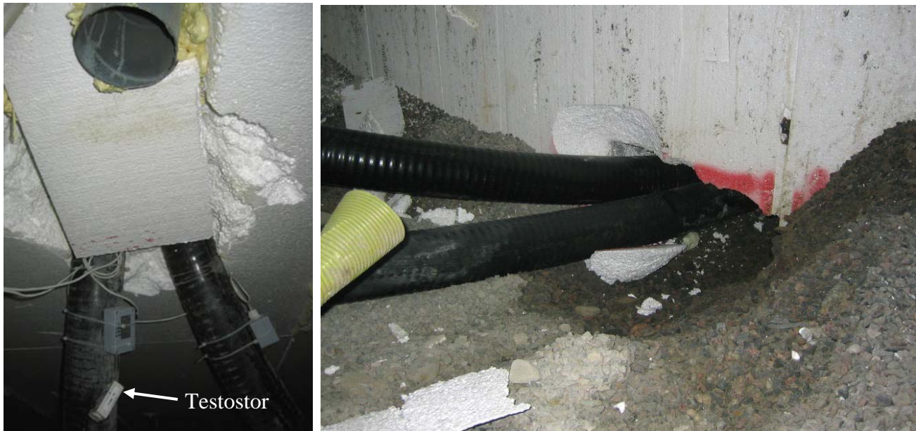
Kuva 15. Vasemmalla poistoilmakanavan alapää. Kuvassa näkyy myös ilman lämpötilaa ja kosteutta mittaava Testostor 175 – 2 tiedonkeruulaite. Laitteen yläpuolella on jokin lähetin, joka saattaa esimerkiksi mitata ryömintätilan olosuhteita ja säättää puhaltimen toimintaa tarvittaessa. Oikealla moduulilinjaa D alta ryömintätilaan tulevat putket, joiden alapuolella on vesilammikko.
