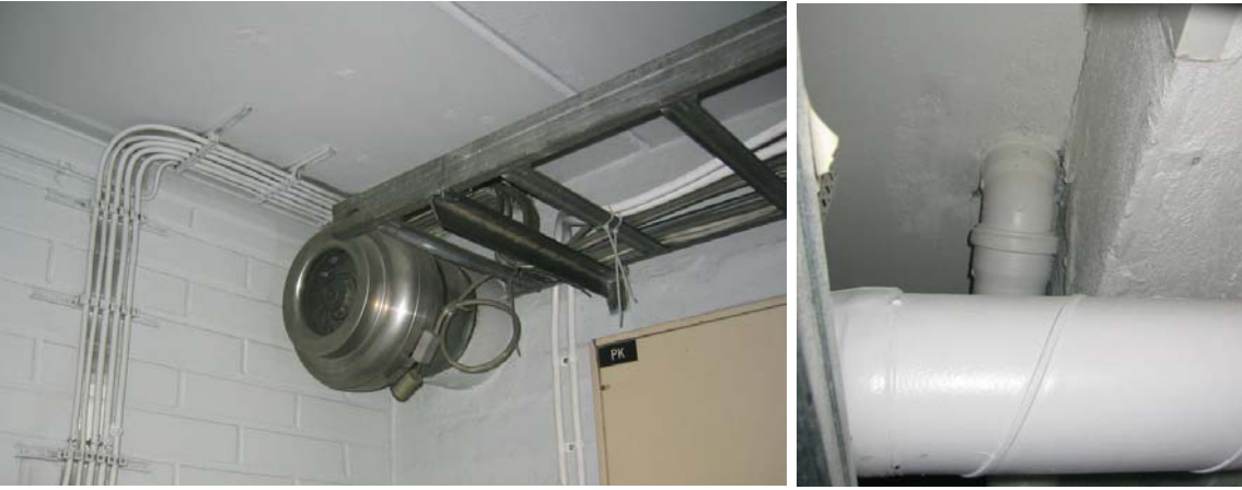
Kuva 19. Tuuletusputkeen asennettu kanavapuhallin ja viemärin läpivienti kellarista yläpuoleiseen luokkaan.
