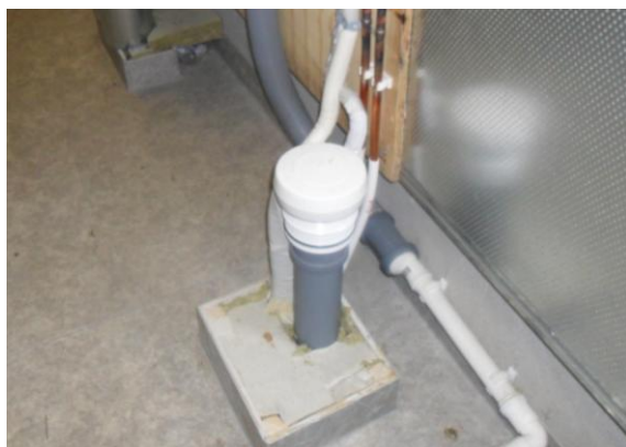
Kuva 1 Läpiviennin päällä vain villalevy
