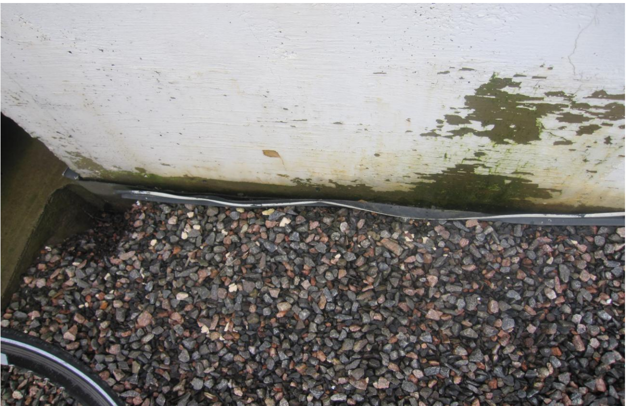
Kuva 2 ATK-luokan valokuilun huonosti asennettua vedeneristystä
