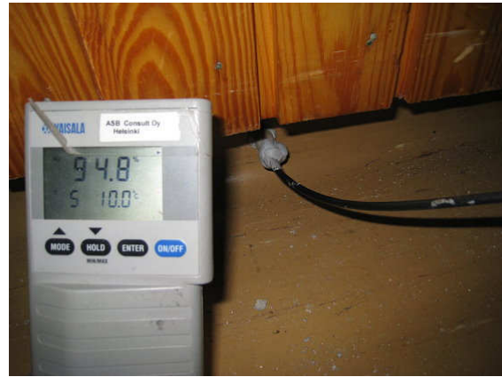
Kuva 2 PRS19:sta kosteusmittaus meneillään.
