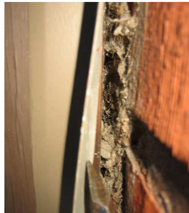
Kuva 10 Ikkunakarmien ja tiilimuurauksien välejä on tiivistetty polyuretaanilla. Paikoin välit ovat tiivistämättömät.
