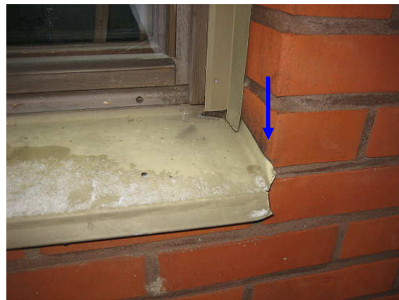
Kuva 12 Ikkunoiden vesipellityksien asennuksissa on puutteita.
