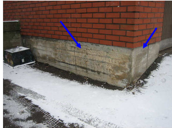
Kuva 2 Sokkelissa on paikoin halkeamia.
