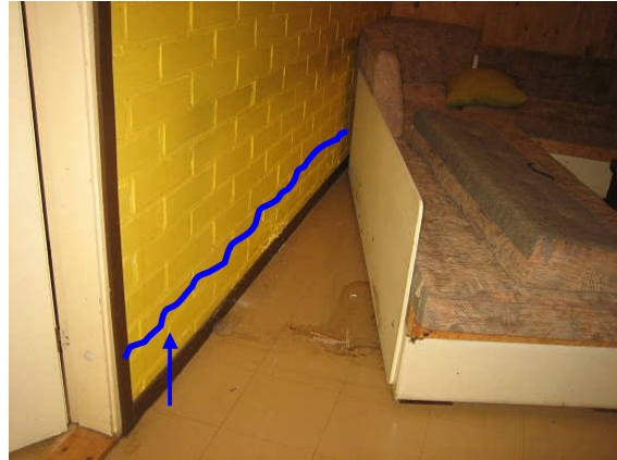
Kuva 14 Paikoin pesuhuoneiden kohdilla on viereisten tilojen puolella näkyvillä kosteuden aiheuttamia jälkiä.
