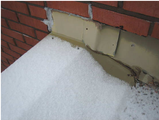
Kuva 9 Rästäspellityksien juurinostojen tiivistyksissä on puutteita.
