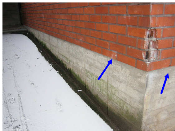
Kuva 6 Tiilimuurausta on rikkoontunut kulmasta. Alimman tiilirivin alaosalla on saumoissa "tuuletus" reikiä.
