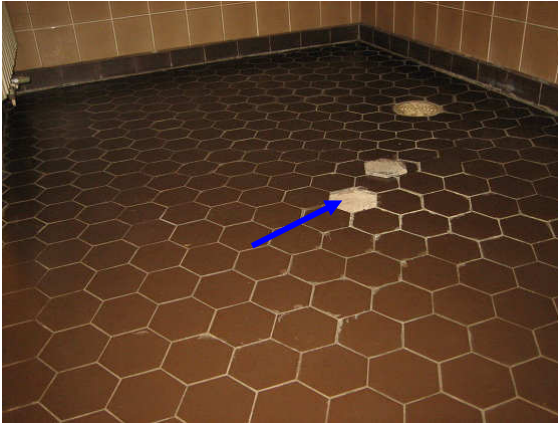
Kuva 13 Pesuhuoneiden seinissä havaittiin normaalista poikkeavia kosteuksia ulottuen alimman laattarivin korkeudelle. Lattialaattoja on irronnut alustastaan. Betonipinnan pintakosteus oli normaalia korkeampi irrotetun laatan kohdalla.
