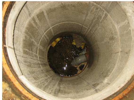
Kuva 4 1.kerroksen käytävän lattianssa oleva salaojien keräilykaivo.
