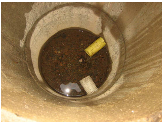
Kuva 5 Länsisivustan salaojien tarkastuskaivo.
