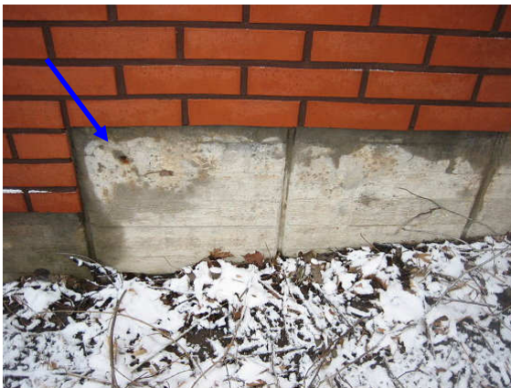
Kuva 3 Ruostunutta raudoitusta on näkyvillä.
