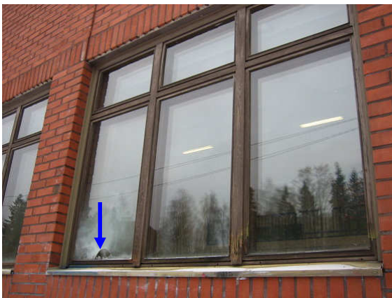
Kuva 11 Monitoimisalun rikottu ikkuna. Puurakenteiden maalit ovat hilseilleet ja suojalistoissa on lahovaurioita. Ikkunan yläpuolella on teräspalkki.
