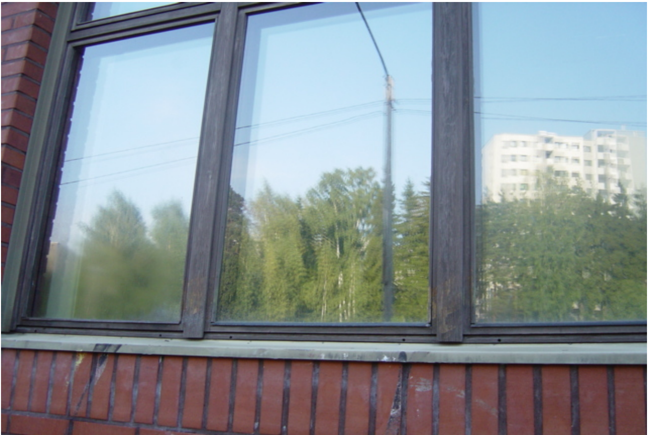
R-kuva 3. Länsisivun ikkunoiden ulkopuitteen pinnan kulumia.
