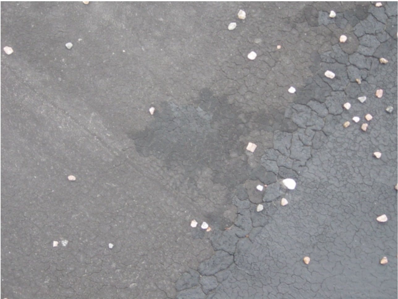
R-kuva 5. Bitumihuovan päältä puuttuu osittain singelikiveystä. Kiveyksen puuttuminen on aiheuttanut huovan halkeamisen.
