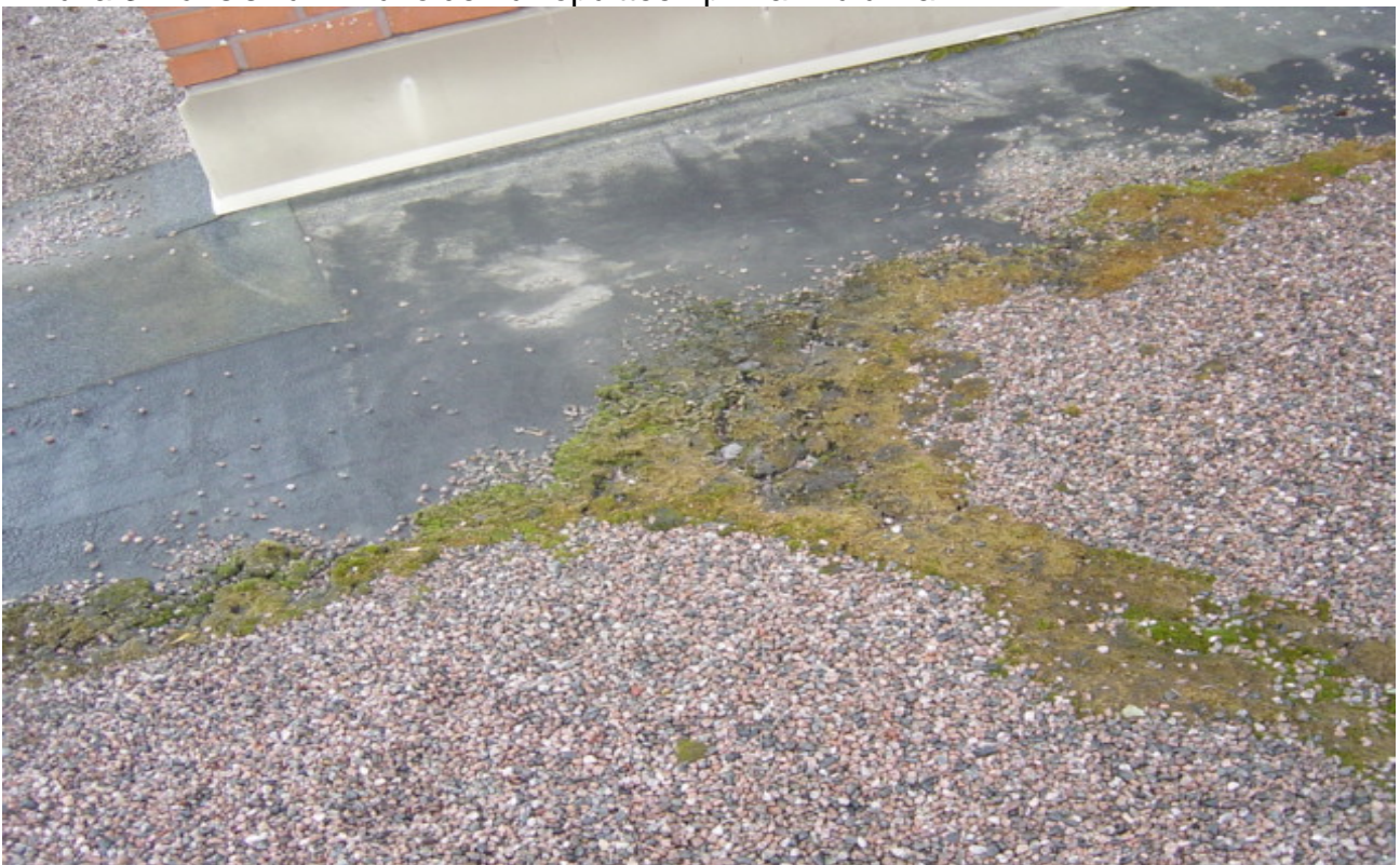
R-kuva 4. Vesikatolla on sammalkasvua.
