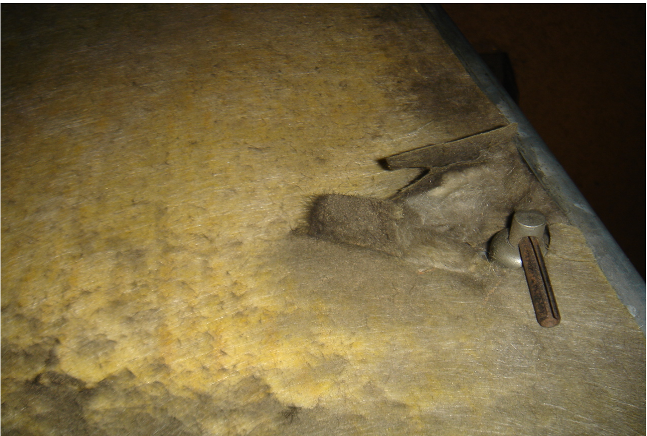
LVI-kuva 13. Villapinta on kolhiintunut.
