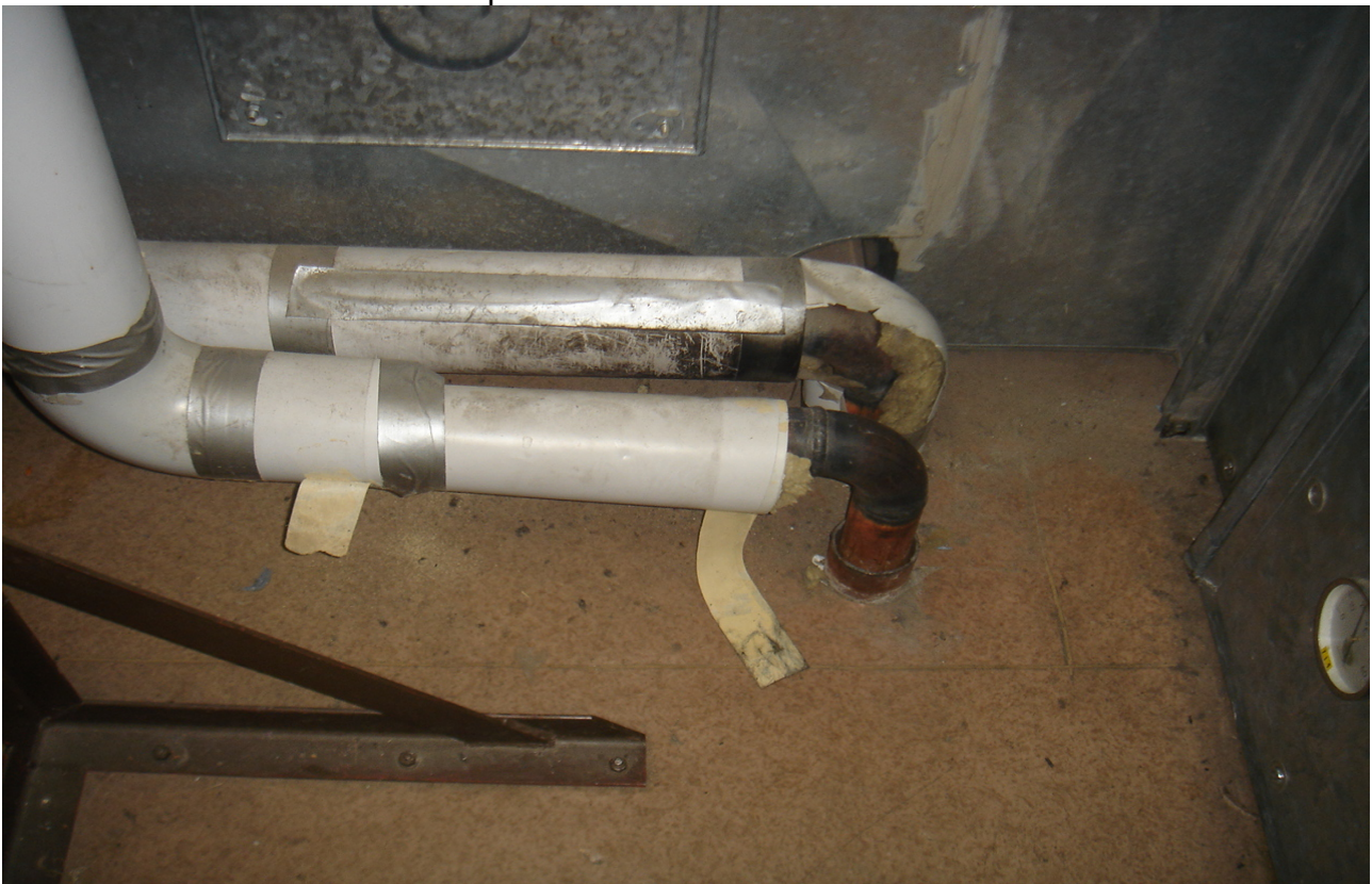
LVI-kuva 3. Putkieristeet ovat kolhiintuneet iv-konehuoneessa.
