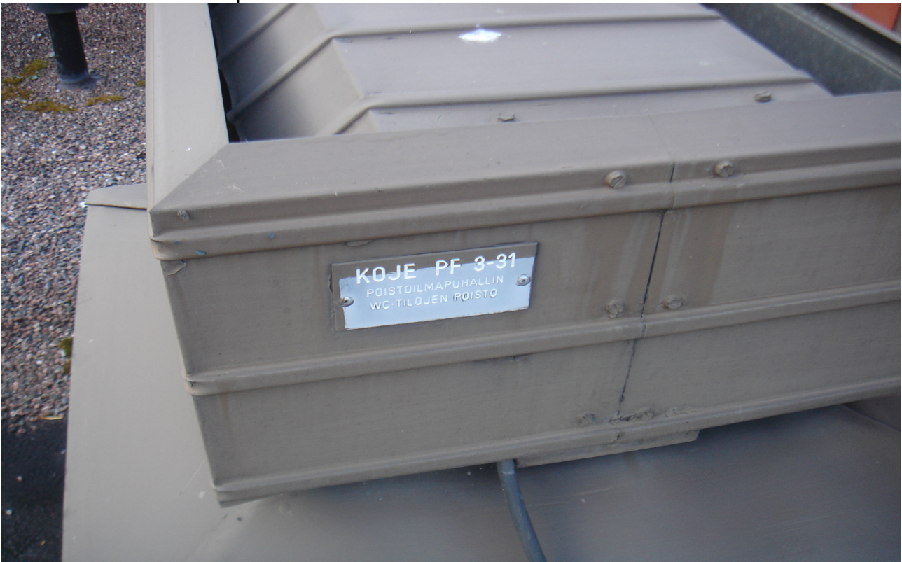
LVI-kuva 15. Yleiskuva huippuimurista.
