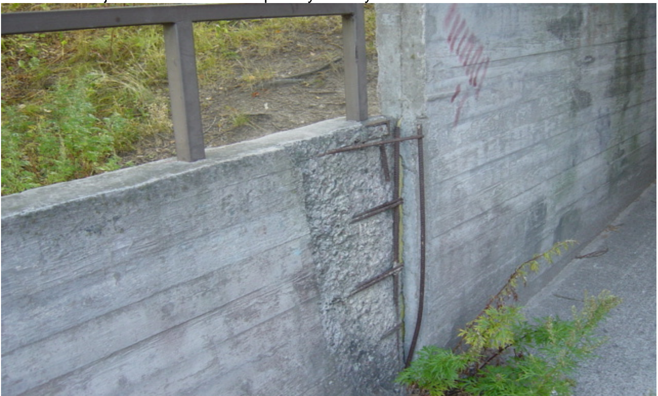
R-kuva 2 Pohjoispäädyn tukimuurin lohkeaman johdosta betoniteräkset ovat näkyvissä.
