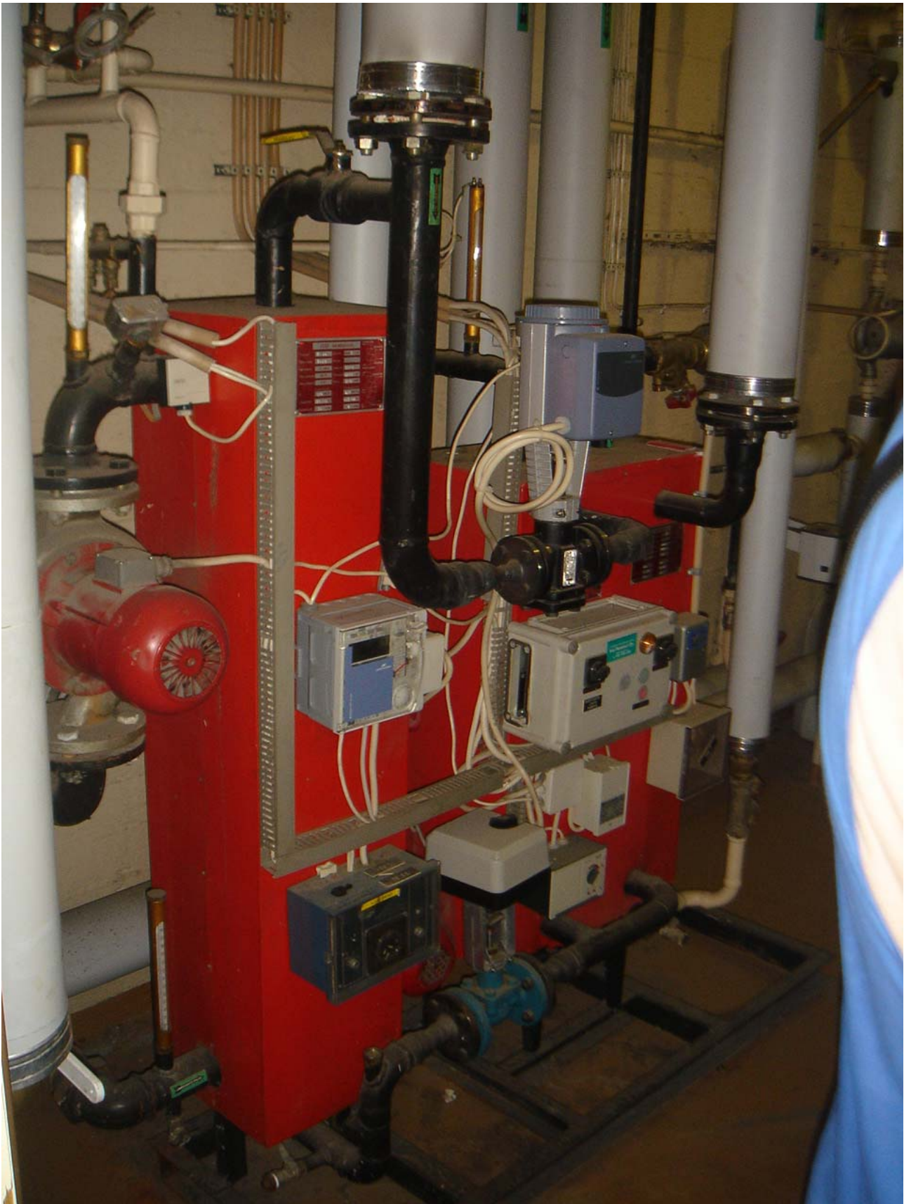
LVI-kuva 1. Yleiskuva lämmönjakuhuoneesta.
