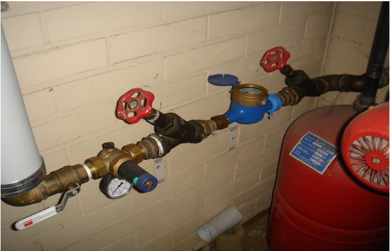
LVI-kuva 4. Yleiskuva vesimittarista ja pääsuluista.
