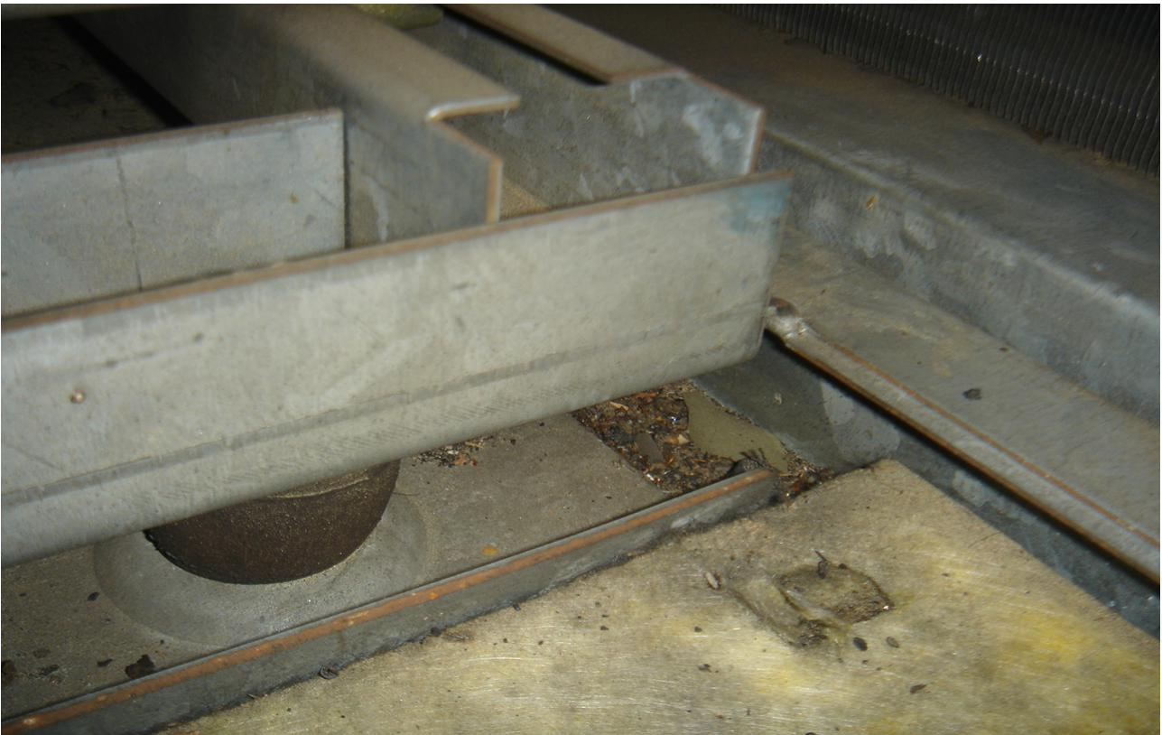
LVI-kuva 12. Puhallinkammiossa on roskaa.
