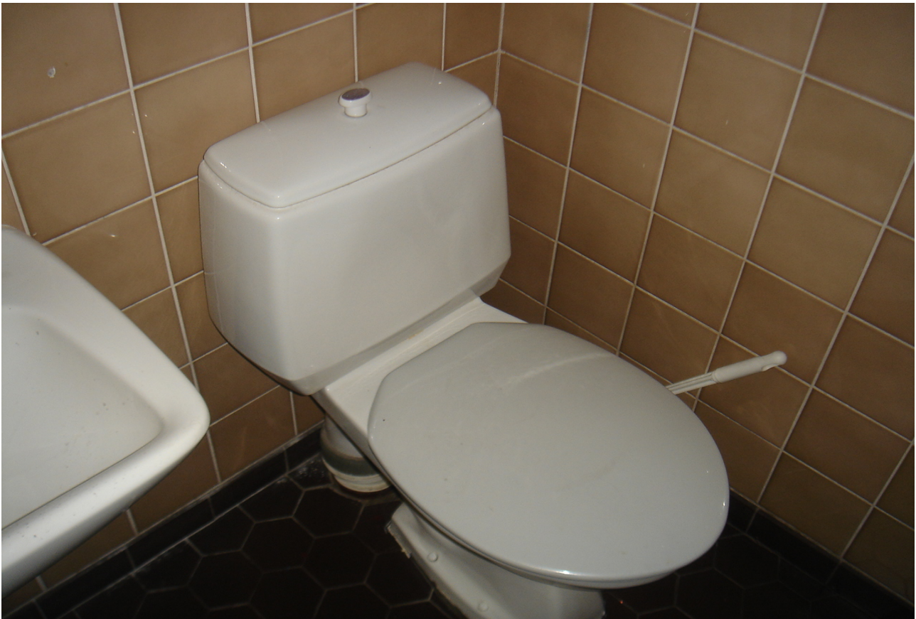
LVI-kuva 8. Yleiskuva wc-istuimista.
