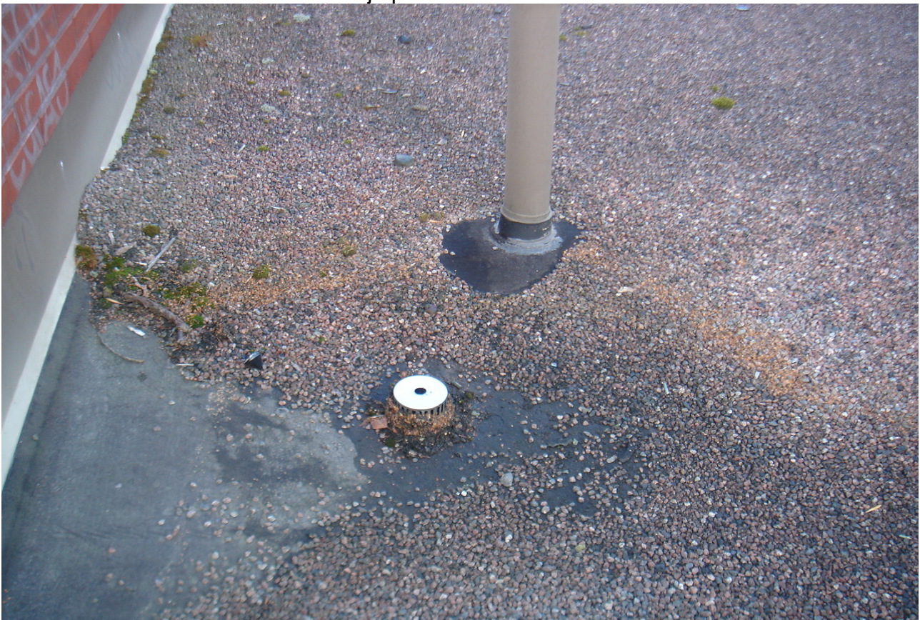
LVI-kuva 5. Kattokaivot on tukossa.
