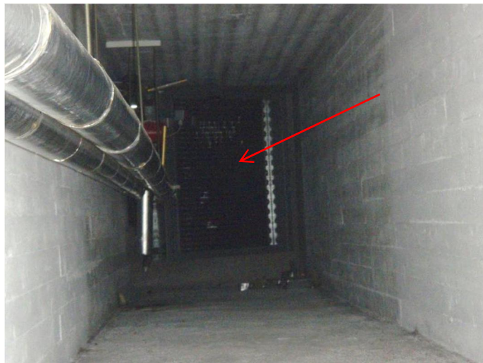
Kuva 15. Auditorion alustatila on yhteydessä tuloilmakanavaan.
