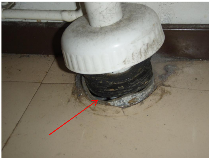
Kuva 11. Lepohuoneen 075 pesualtaan epätiivis viemäriiliitos
