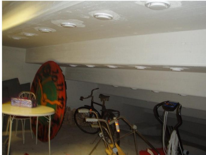
Kuva 14. Auditorion alustatila; kuvassa näkyy auditorion penkkien alla olevat tuloilmaventtiilit.
