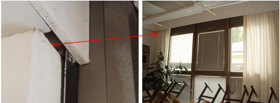
Kuva 9. Kotololiittymä on epätiivis. Kotelossa on mineraalivillaa.
