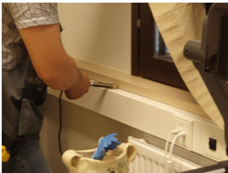
Kuva 4. Sähkökourujen liittymässä havaittiin ilmavuotoa. Tämä oli tyypillinen vuoto-kohta.
