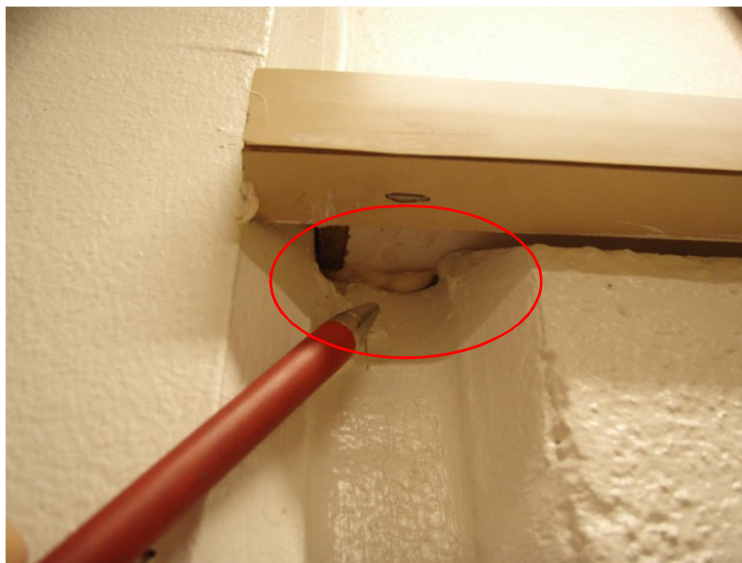
Kuva 1. Betonielementin ja pilarin välisen sauman kohdalla ikkunapenkin alla on rako. Tämä oli tyypillinen vuotokohta.
