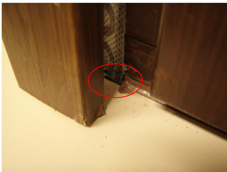
Kuva 2. Ikkunan peitelistan ja ikkunapenkin välissä on rako. Tämä oli tyypillinen vuotokohta.
