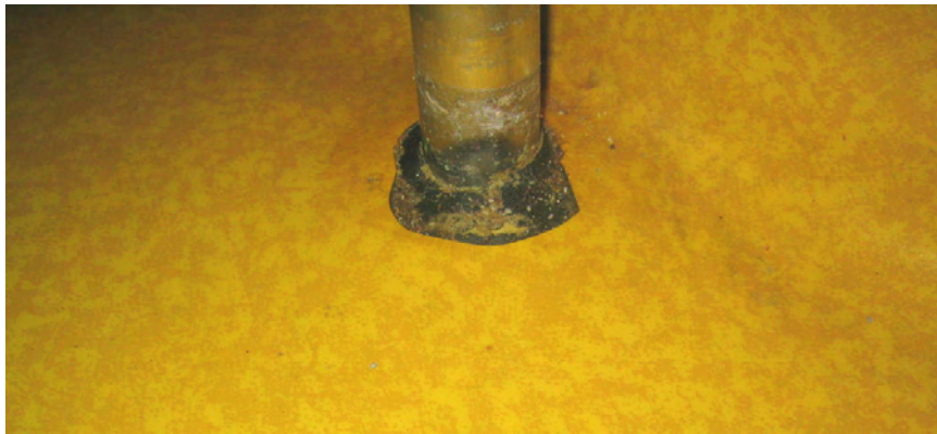
Kuva 12. Lattianpäällysteen liittyminen läpivientiin ei ollut kaikilta osin ehdottoman tiivis.
