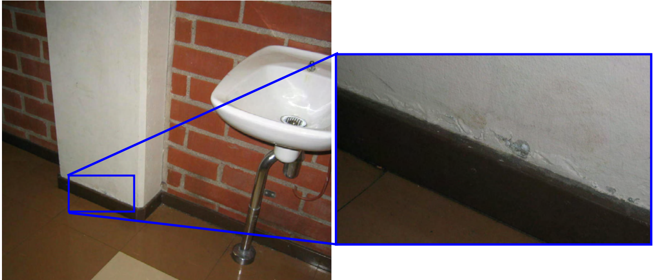
Kuva 5. Vahtimestarin huoneen 1095 läheisyydessä olleen pilarin alareunassa havaittiin mahdollisesti kosteuden aiheuttamaa maalin hilseilyä pienellä alueella.
