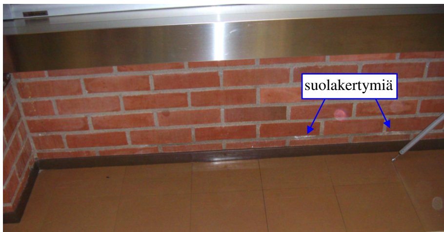
Kuva 4. Ruokalan linjaston edessä korkeiden pintakosteuslukemien kohdalla oli hieman suolakertymiä tiiliseinän saumalaastissa.
