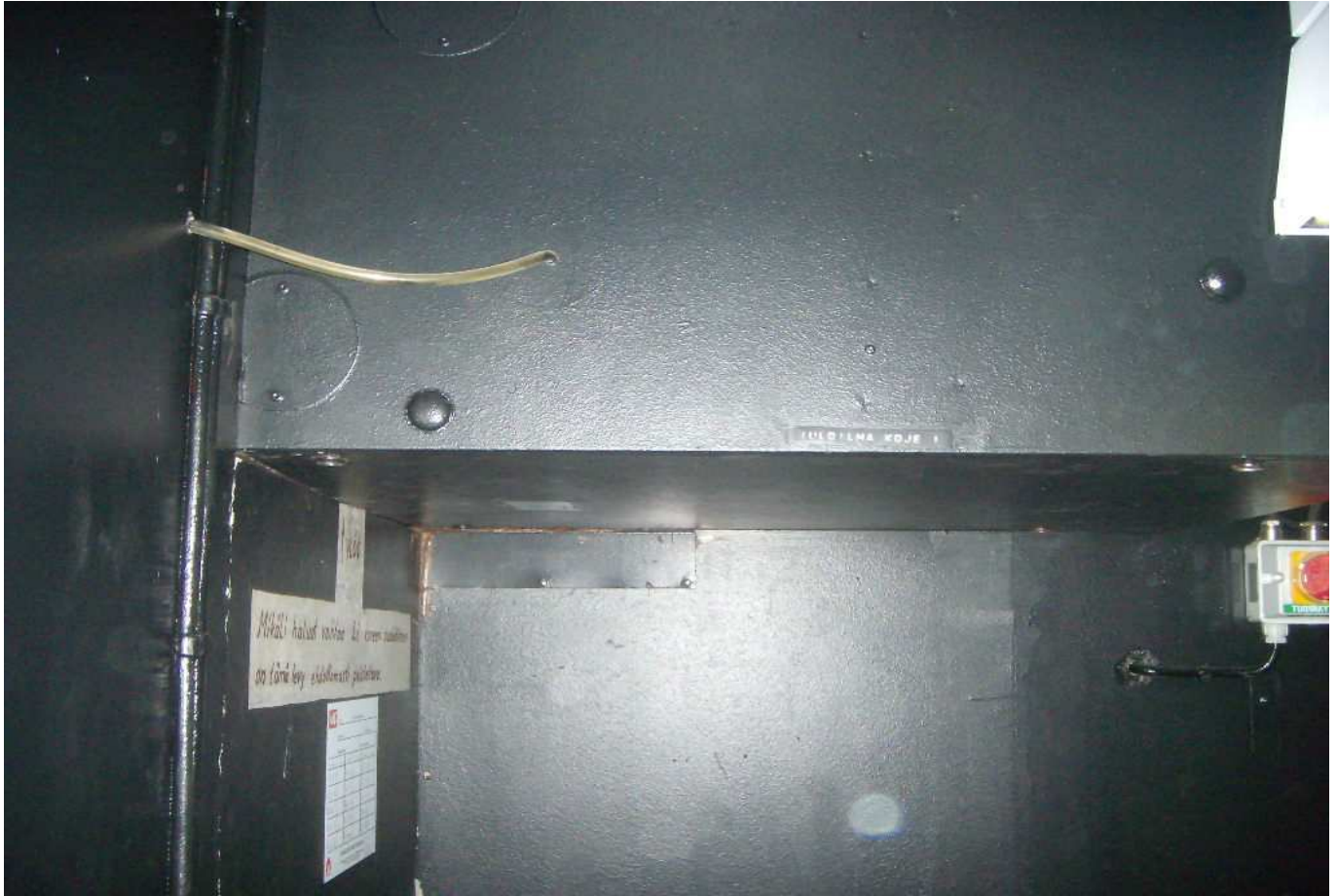
KUVA 1. Yleiskuva IV- konehuoneesta.
