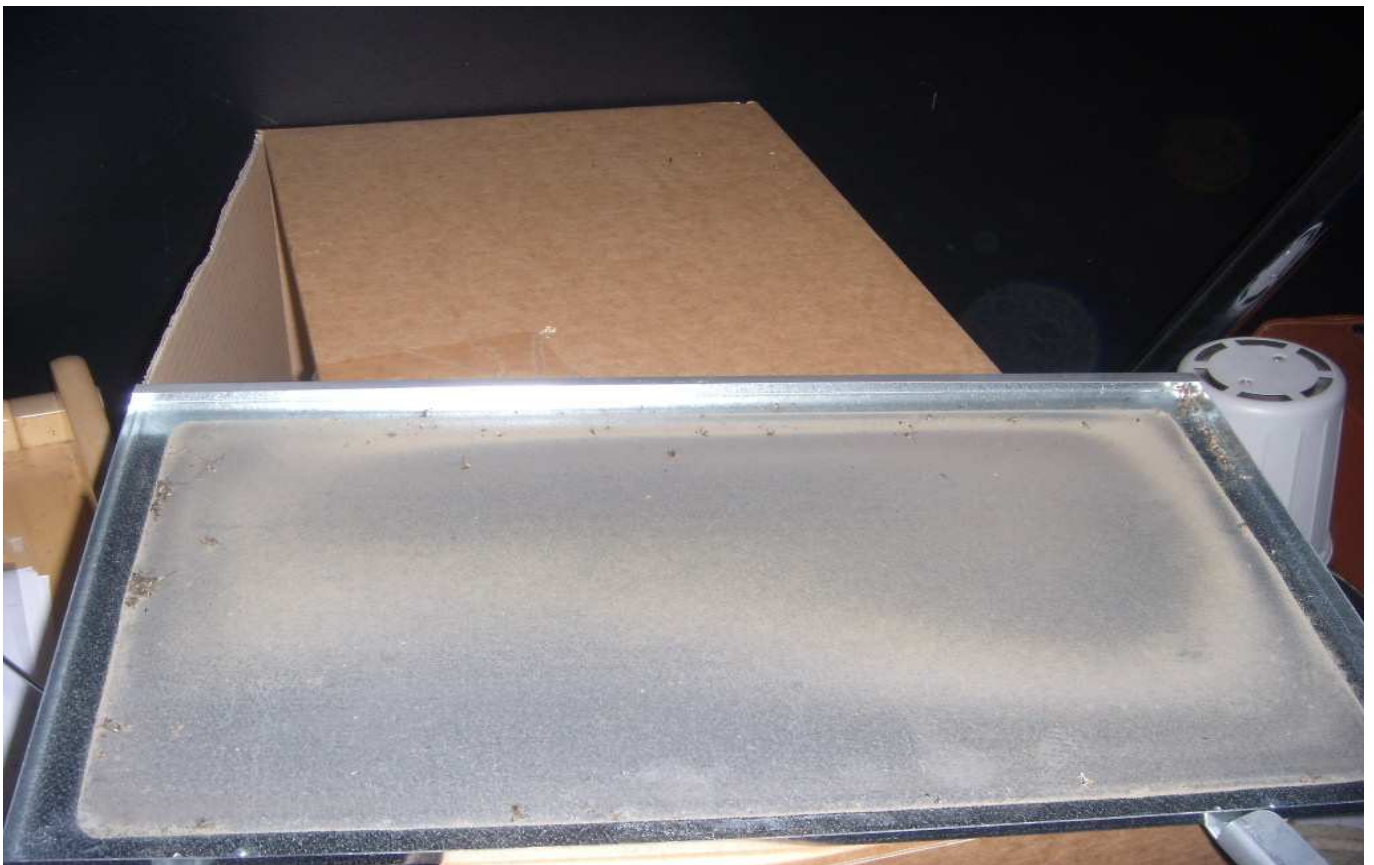
KUVA 8. Tuloilmakammiot ovat pölyiset.
