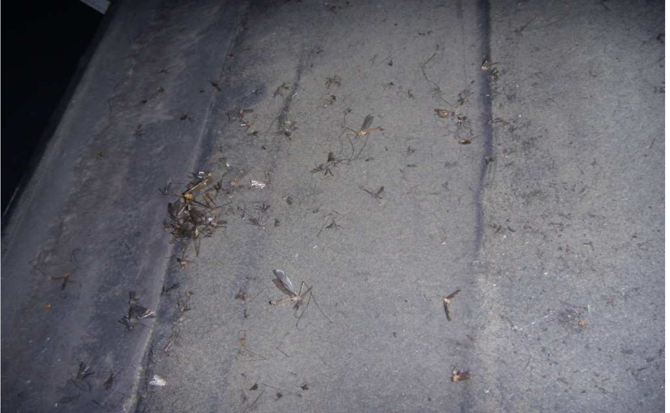
KUVA 5. Tuloilmakoneen kammio on eristetty mineraalivillalla, joka on pölyinen, roskainen ja paikoin rikki.
