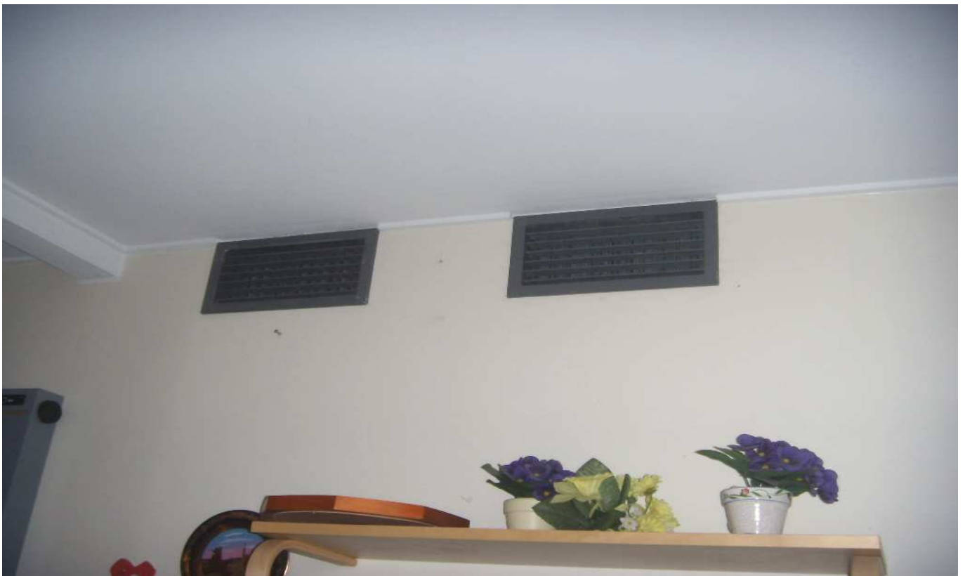
KUVA 10. Yleiskuva tuloilman pääte-elimistä.
