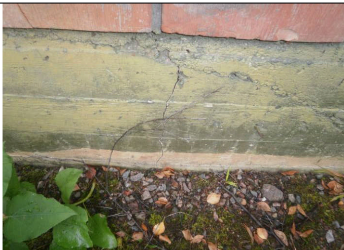
1. Rakennuksen sokkelissa olevia halkeamia.
