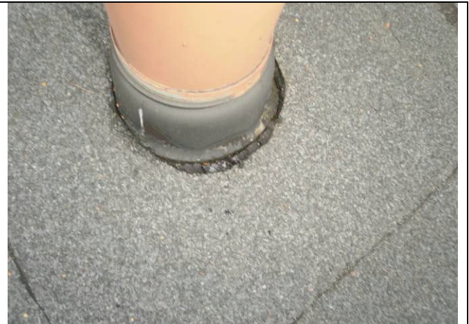
16. Tuuletusputken alaosan tiivistys on kulunut vuosien saatossa. Suositellaan tiivistämistä.
