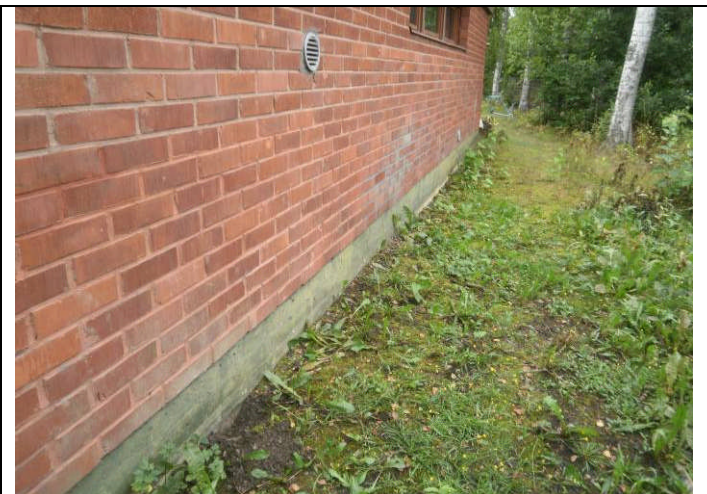
2. Rakennuksen vierustalla on humuspitoista maa-ainesta ja kasvillisuutta.
