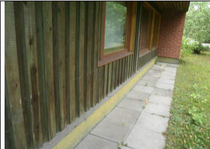
7. Julkisivua takapihan puolelta. Lautaverhouksessa havaittiin haalistumaa.
