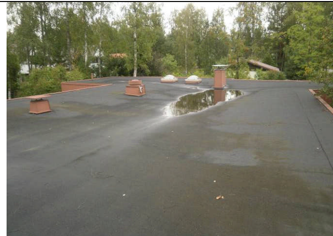
15. Näkymä katolla. Sadevedet ovat kertyneet puhdistamattoman kaivon ympärille.
