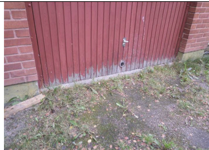
13. Autotallin ovi. Oven alaosa on vaurioitunut kosteudesta.
