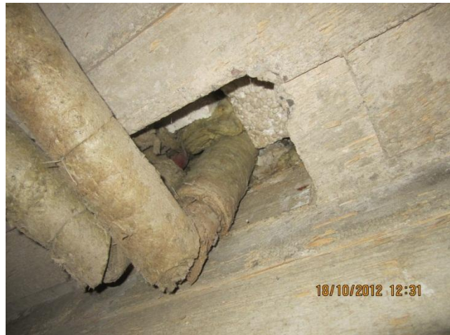
kuva 10 Alapohjan läpiviennit ovat tiivistetty villalla ja polystyreenin paloilla.
