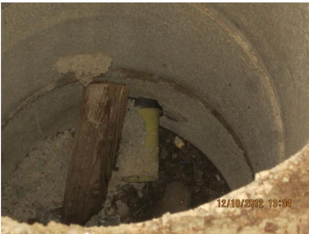
kuva 3 Salaojakaivoissa on ylimääräistä tavaraa.
