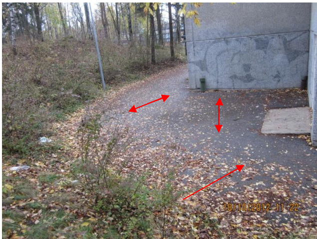
kuva 19 Liikuntasalin sisäänkäynnin edusta saattaa uittaa vettä välipohjarakenteisiin.
