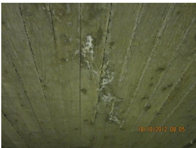
kuva 13 Myös varastotilan katossa on paikapaikoin kosteusvaurioita.
