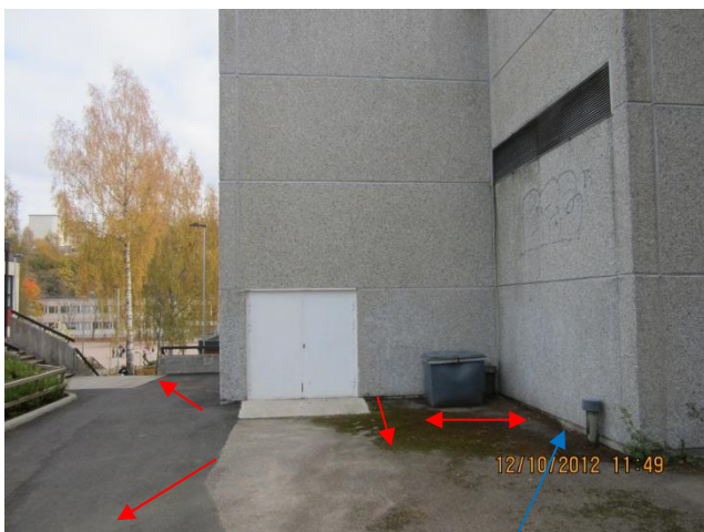
kuva 21 Liikuntasalin toisen sisäänkäynnin lähellä on sokkelin vierellä paha painauma .
