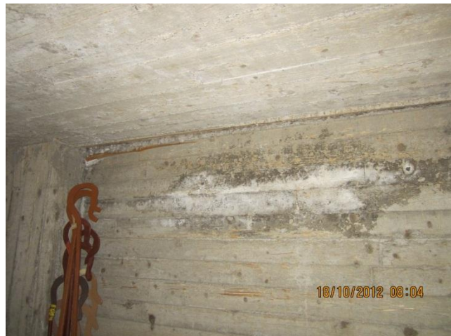
kuva 4 Sekä alustatilan että kuvan varaston seinissä on paljon kosteusvauriojälkiä.
