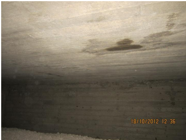
kuva 9 Myös alapohjassa on kosteusjälkiä.
