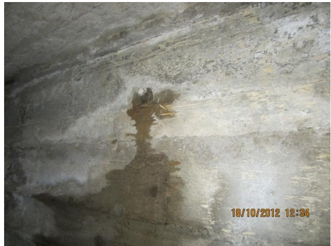
kuva 8 Perusmuurissa on alustatilan puolella näkyvissä kosteusjälkiä.
