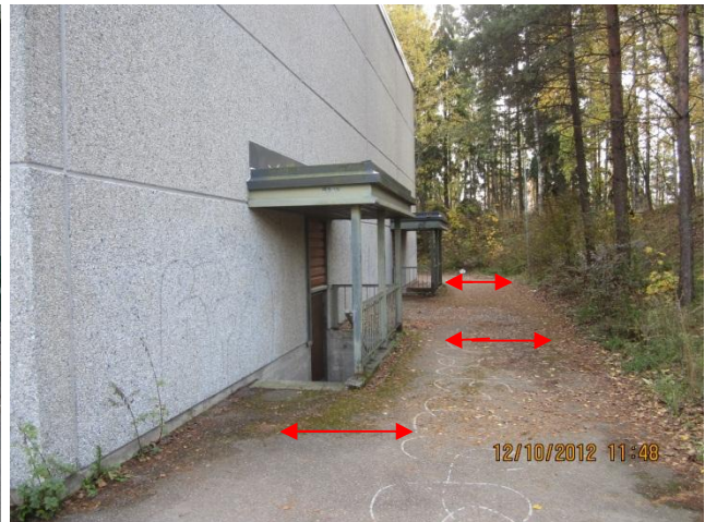
kuva 18 Yläpihan pintakallistukset eivät ole riittävät.
