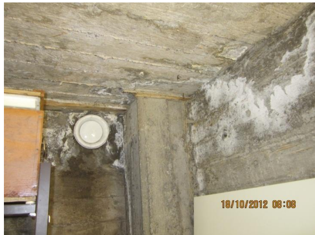
kuva 12 Varaston seinissä on runsaasti kosteusjälkiä, varsinkin sokkelläpiviennin kohdalla. Poistoilmaventtiili on tarkoitettu koneellisen ilmanvaihtojärjestelmään.
