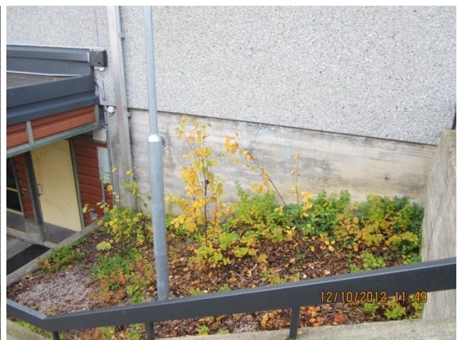
kuva 22 Alustatilassa on perusmuurissa kosteusjälkiä pensaskasvuston kohdalla.
