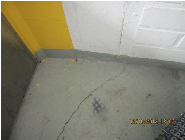
kuva 1 Tuulikaapin 037 betonilattiasa on halkeama.
