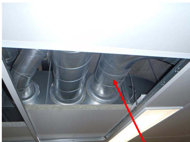
Kuva 1. Runkokanavasta lähtevä tuloilmakanava.
