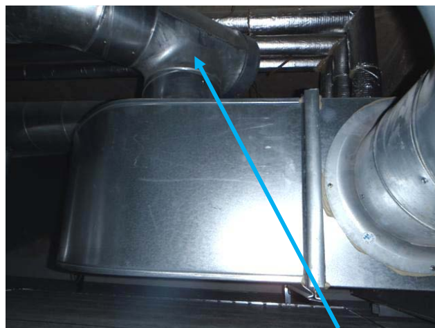
Kuva 2. Runkokanavasta lähtevä poistoilmakanava.
