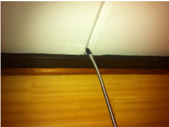
Ilmavuotoreitti väliseinien pystysauman kohdalla.
