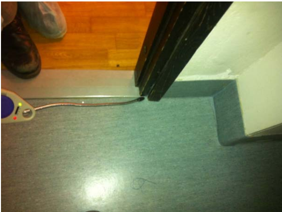
Ilmavuotoreitti kynnyksen kohdalla.
