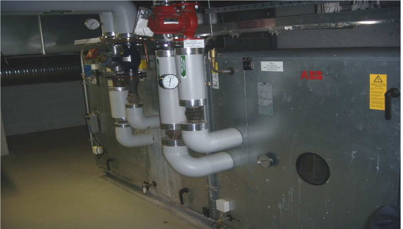
KUVA 1. Yleiskuva IV- konehuoneesta.
