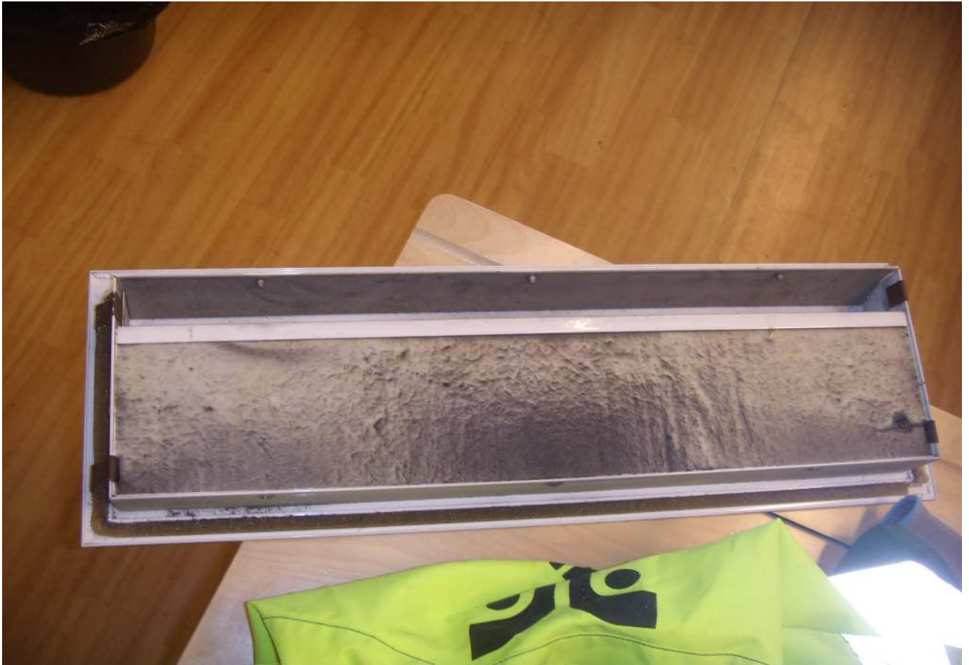
KUVA 10. Tuloilmaelimien äänieristeenä on käytetty mineraalivillaa.
