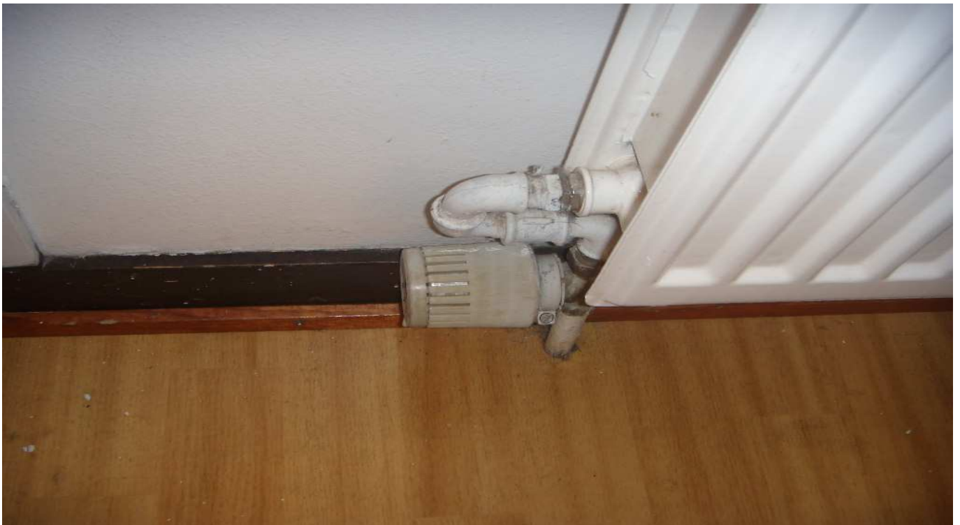
KUVA 11. Yleiskuva vanhasta patteriventtiilistä.
