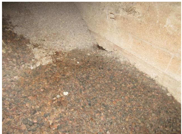
kuva 20 Kosteutta on perusmuurin vierellä ja alla. Vastatäyttö puuttuu.
