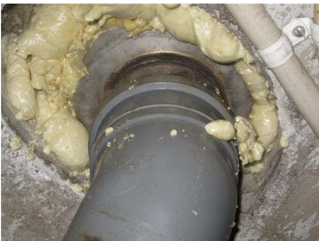
kuva 32 Viemäriputken liitos on huonosti kiinni
