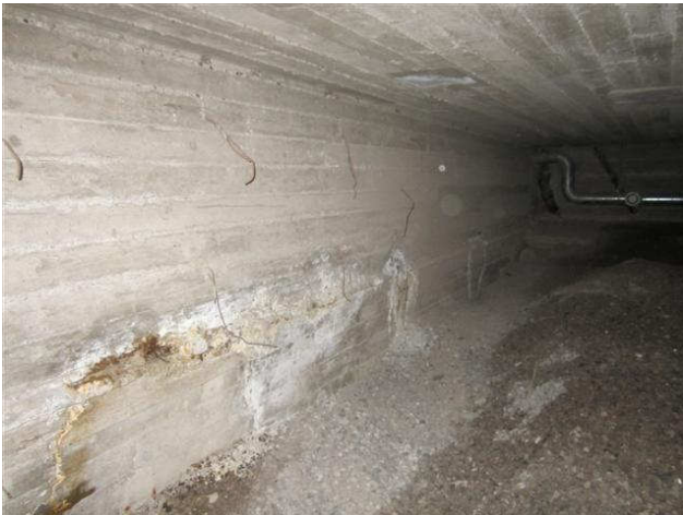
kuva 21 Perusmuurissa on kalkkijälkiä.
