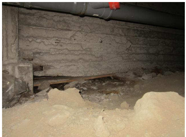
kuva 33 Perusmuurin alla on lahoavaa puuainesta.
