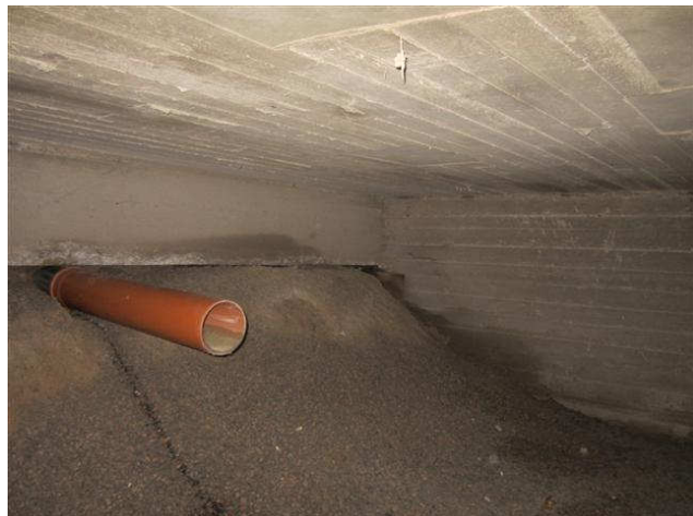
kuva 8 Tuuletusputkea on jatkettu muoviputkella.
