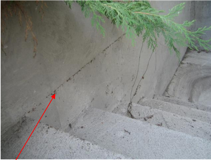
Vesi tullut paineella viemärin kautta, vesiraja näkyy seinässä. Vesi mennyt oven kautta jumppasaliin.
