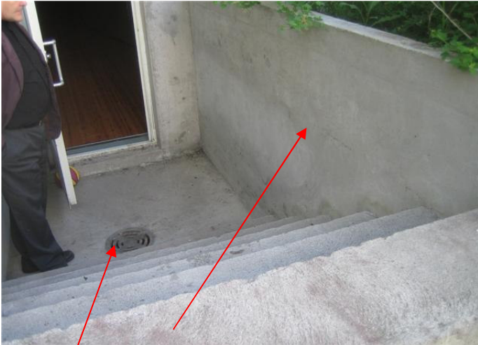
Vesi tullut paineella viemärin kautta, vesiraja näkyy seinässä. Vesi mennyt oven kautta jumppasaliin.
