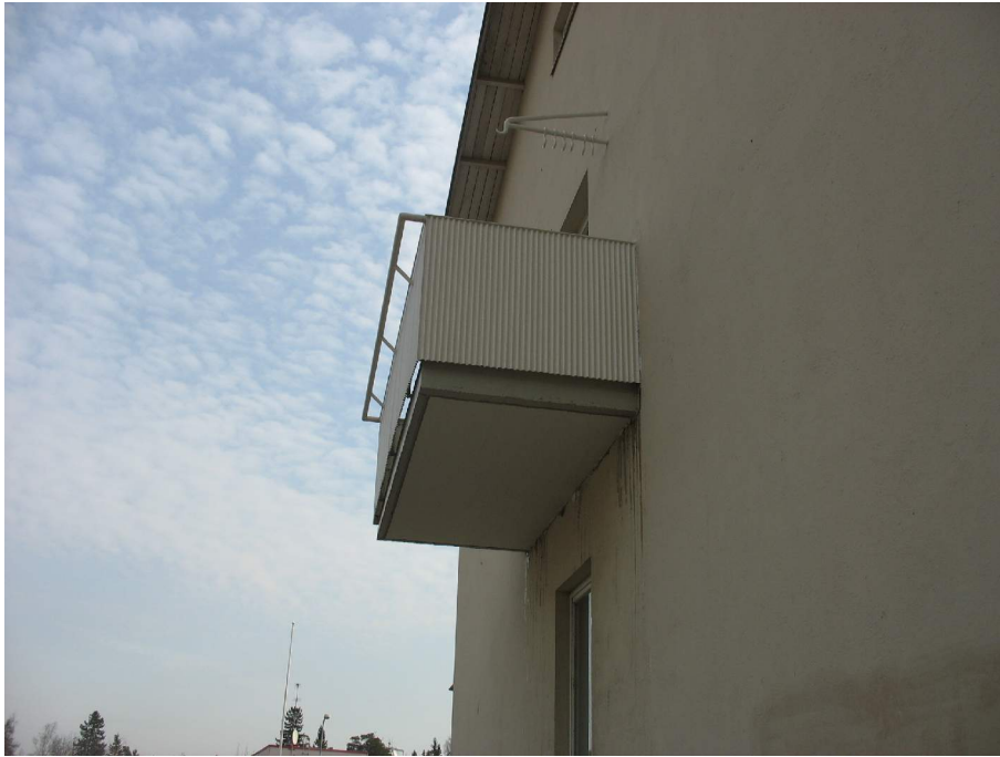
Kuva 13. Parveke pohjoissivulla, parvekekorjaustyön valumajälkiä rappauspinnalla.
