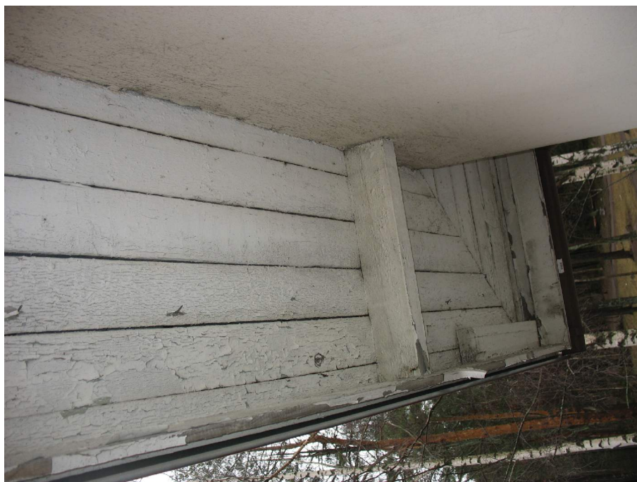
Kuva 12. Pohjoispäädyn puurakenteinen räystäs. Maalipinta hilseilee koko räystäsosalla. Puurakenteet ovat kuitenkin säilyneet ehjinä, ilman lahovaurioita.
