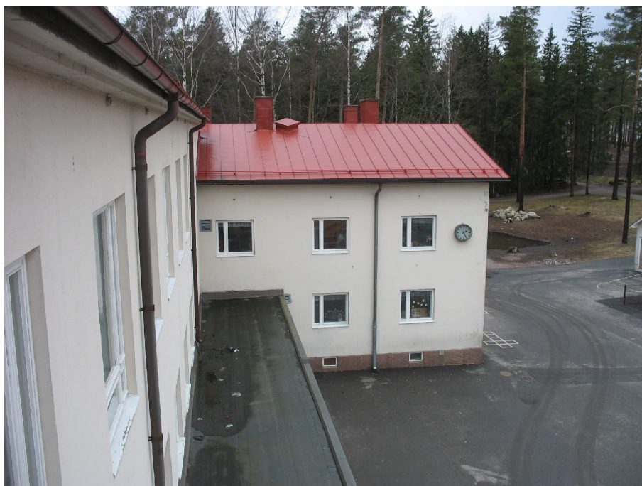
Kuva 10. Pohjoissivun katoksen sadevesikaivot ovat herkästi tukossa. Tutkimuspäivänä katolla lainehti vesi. Kaivojen roskasihtien puhdistamisen jälkeen vesi poistui nopeasti katolta.
