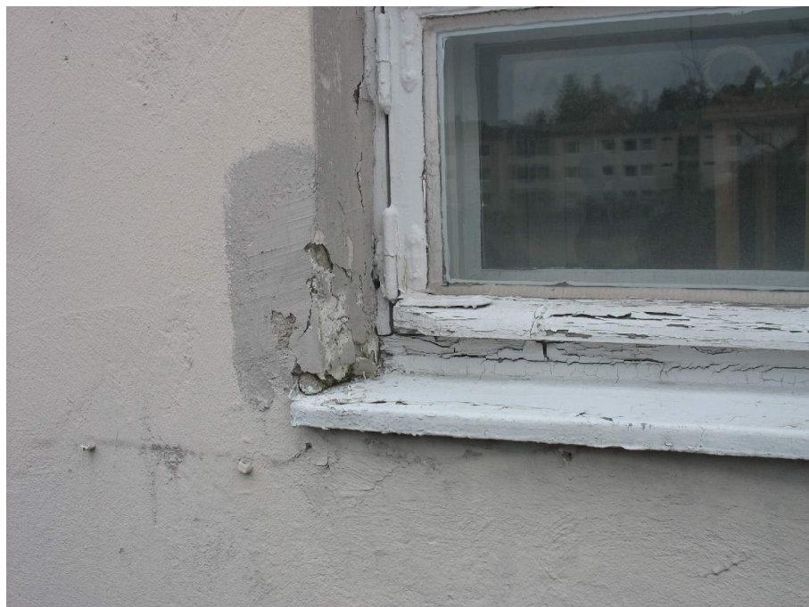
Kuva 9. Ikkunapielien paikkaukset. Näitä on kohteessa muutamia, ja lähes kaikki paikkakohdat ovat irti tiilipinnasta.
