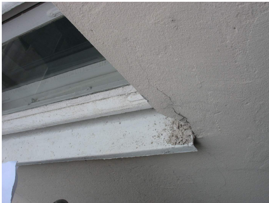
Kuva 11. Tyypillinen ikkunanpieli, laasti ikkunanurkassa on irti alustastaan ja nurkassa laasti on rapautunut
