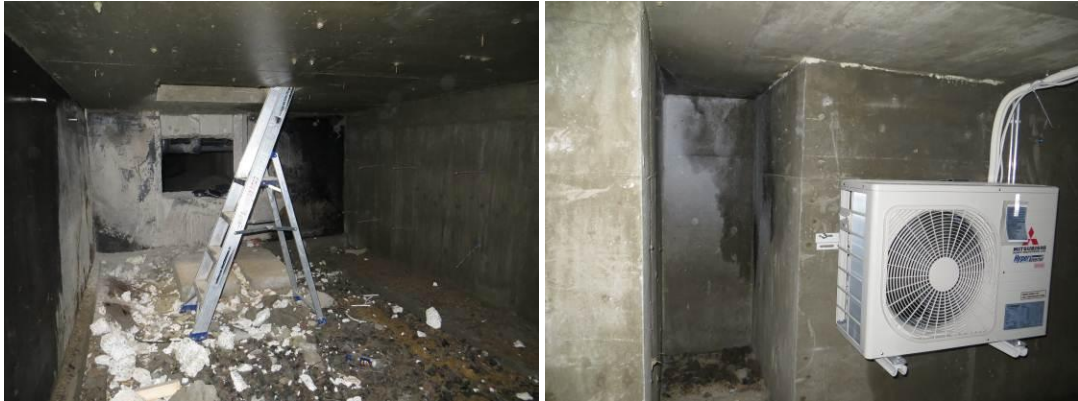
Kuvat 12a ja 12b. Betonipinnat ovat kastuneet todennäköisesti kondenssin takia vaunuvarasto 1090 alla. Lastaussillan ontelotilan huurtunut seinä kenno, joka on kastellut betonia ja maata.
