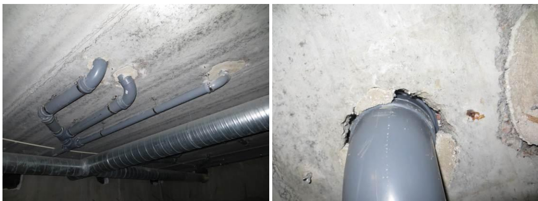
Kuvat 7a ja 7b. Vasemmanpuoleisessa kuvassa tiiviltä vaikuttavia viemärläpivientejä ja oikean puoleisessa kuvassa epätiivis täyttövalu viemäriputken läpiviennissä.
