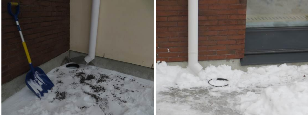
Kuvat 14a ja 14b. Väärin sijoitettuja rännikaivoja. Vesikattojen sadevedet eivät ohjaudu rännikaivoon vaan sadevedet lisäävät perustusrakenteiden kosteusrasitusta.
