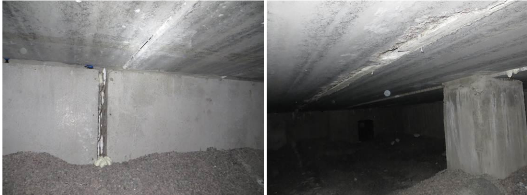
Kuvat 10a ja 10b. Sokkelielementin sauma on valamatta, tila 1046 kohdalla. Ontelolaatan saumavalussa on halkeilua ruokasalin 1019 sivulla.
