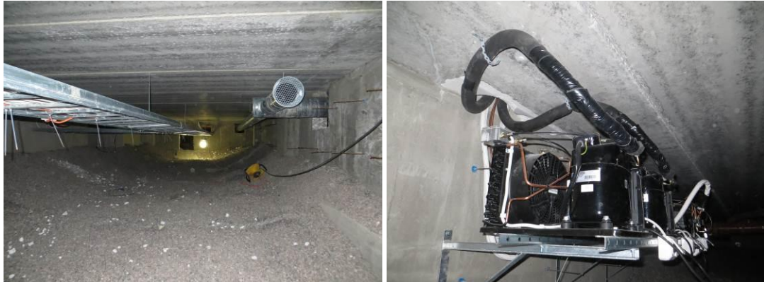
Kuvat 6a ja 6b. Vasemmalla ilmanpoistokanava ruokasalin 1019 alla vahtimestari 1003 lähellä. Keittiön kylmälaitteiden lauhdutinkompressoreita tilan 1038 alla.
