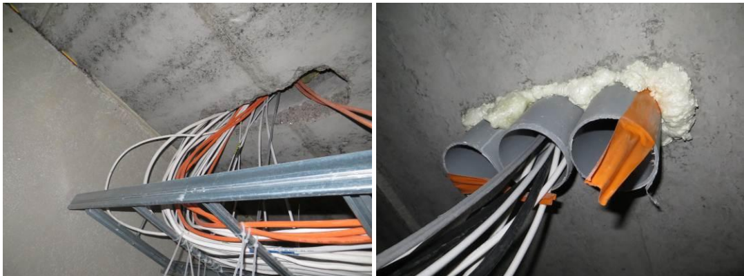
Kuvat 9a ja 9b. Vasemmalla tiivistämätön sähköläpivienti ruokasali 1019 alla. Oikealla kuvassa sähkönousukeskuksen 1018 kohdalla sähköputkitusläpivienti on tiivistetty sivuilta, mutta putki on keskeltä tiivistämättä, korkealla putken yläpinnassa on vuorivillaa tukkeena.
