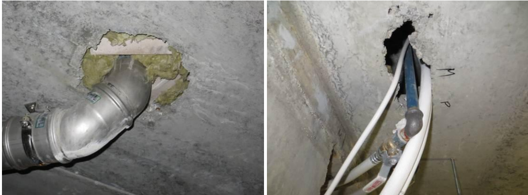
Kuvat 8a ja 8b. Vasemmalla tiivistysvalu on jäänyt tekemättä tilojen 1020 alla. Oikealla kuvassa tiivistämätön putki- ja sähköjohtoreitti vahtimestari 1033/ruokasali 1019 kohdalla.
