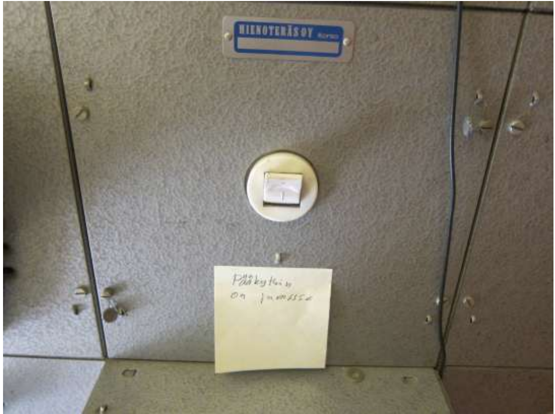
S6: Pääkytkin on jumautunut.
