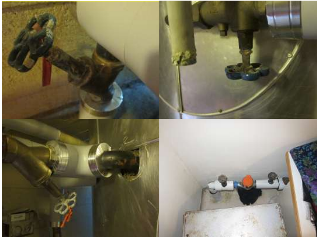
Kuva: L3. Vesi- ja lämmitysverkoston vanhoja karasulkuja.
