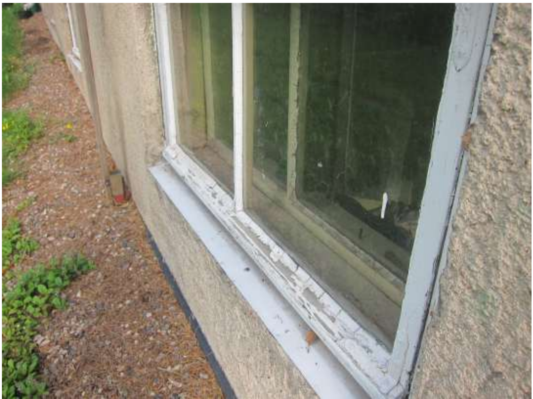
KUVA R10: Puuikkunoiden ulkopuitteissa maalipinta ja kittaukset ovat säänmukaisesti vaurioituneet eri puolilla rakennusta.
