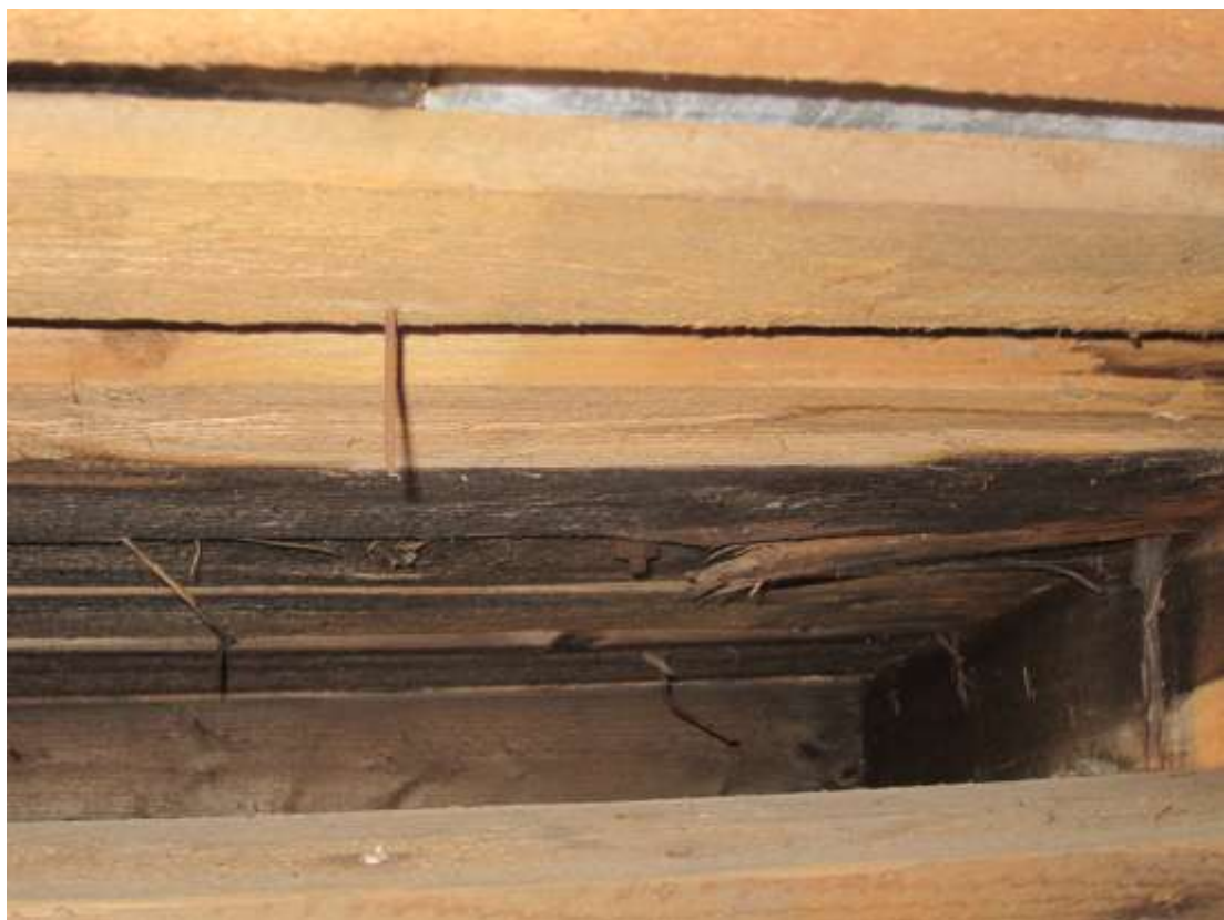
KUVA R20. Räystäskoteloissa kattokannattajien päät ja aluslaudoitus selkeästi altistuu kosteudelle muuta kattoa enemmän ja tummuu / lahoaa.
