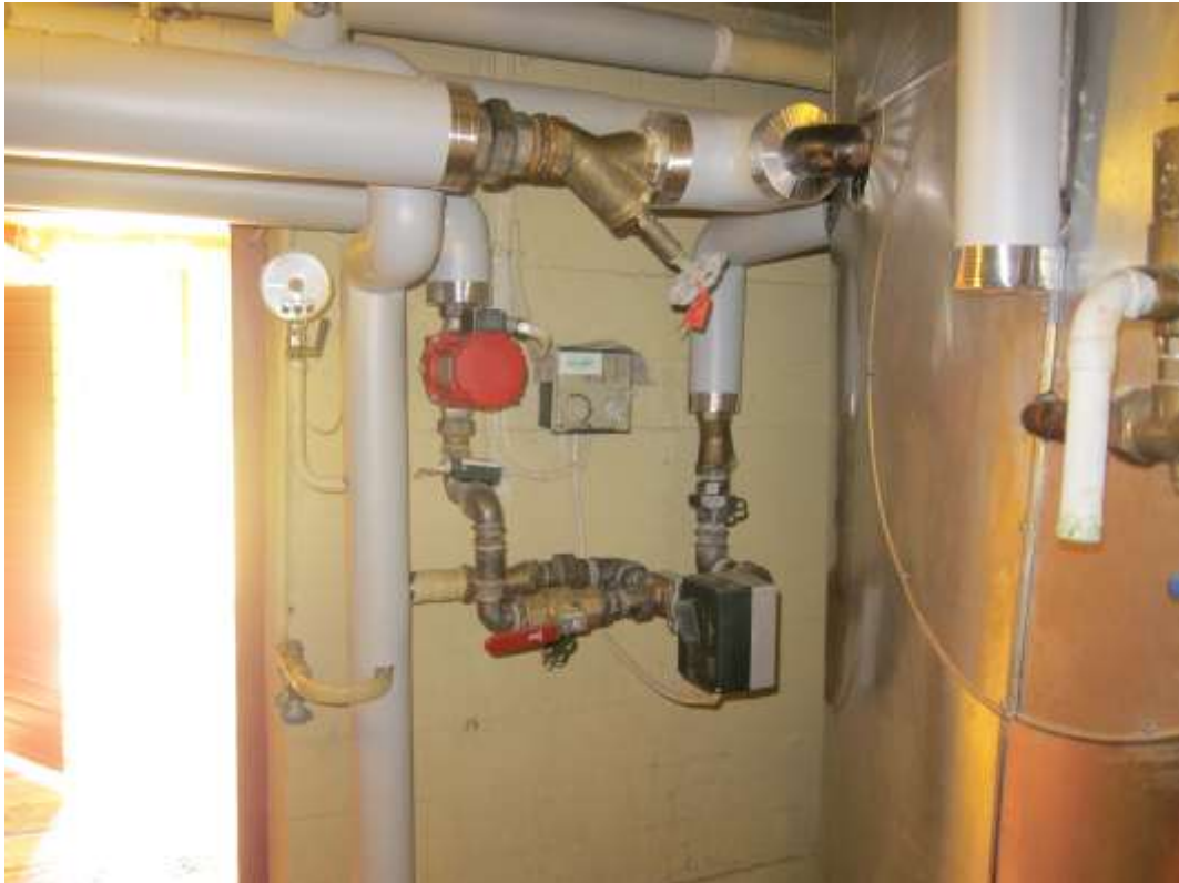
Kuva L1: Kuva "pannuhuoneen" ovelta. Sähkövastuksin lämmitettävä varajasäiliö oikealla. Keskellä lämmityksen kiertopumppu, säätökeskus ja moottoriventtiili.
