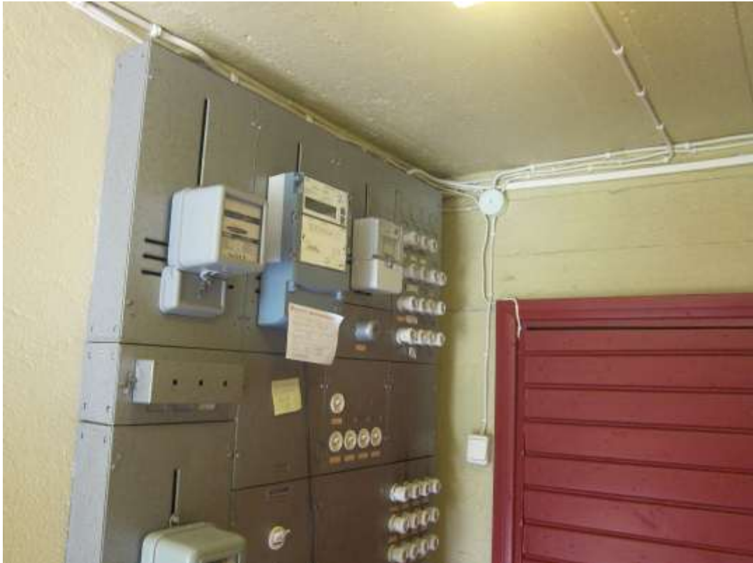
S1: Sähköpääkeskus pohjakerroksen käytävällä.
