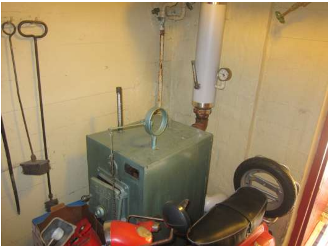
Kuva: L2. Vanha lämmityskattila. Vesi kiertää edelleen kattilan kautta.
