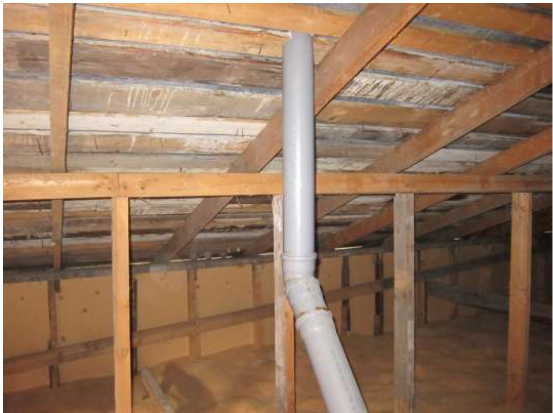
Kuva: L6. Viemärin tuuletusputki yläpohjassa on eristämätön.
