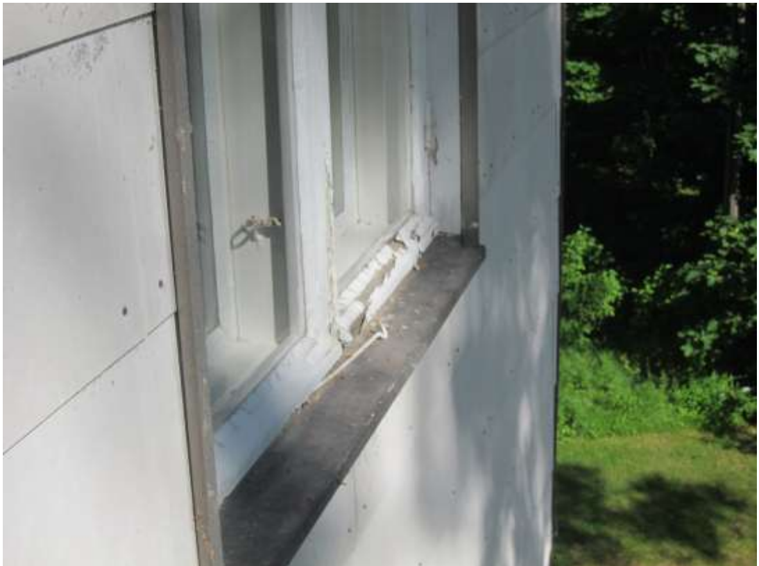
KUVA R12. Puikkunoiden ulkopuitteissa maalipinta ja kittaukset ovat säänmukaisesti vaurioituneet eri puolilla rakennusta.
