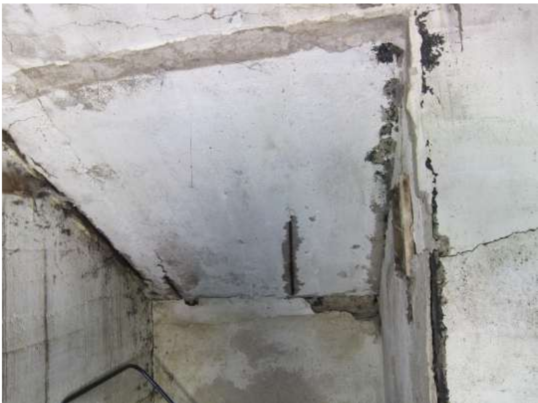
KUVA R6: Em. ulkoportaan alustaa.
