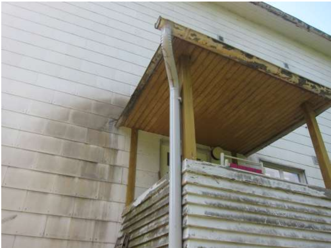
KUVA R4: Pohjoissivustan sisäänkäynti, katos ja ulkoporras. Katos valuttaa vedet seinälle ja portaalle.
