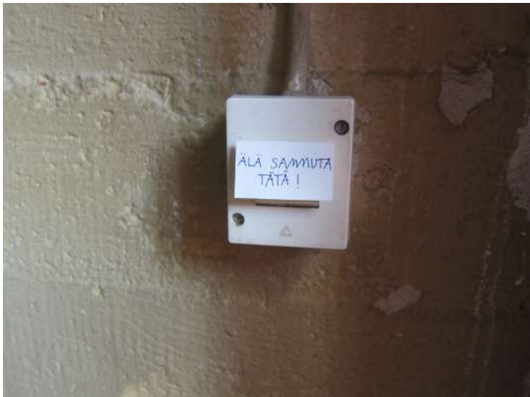
S5: Ulkovalaistuksen "ohjaus".
