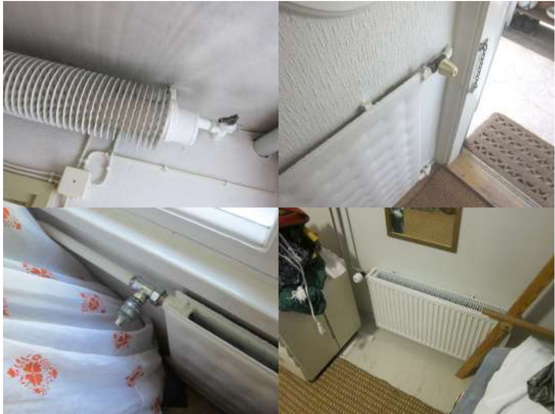
Kuva: L5. Ylärivissä alkuperäinen ja vanha käsikäyttöpyörä, alarivissä -78 asennetut termostaattiset patteriventtiilit ja yksittäinen 2006 uutena asennettu lämmityspatteri + termostaattinen patteriventtiili.
