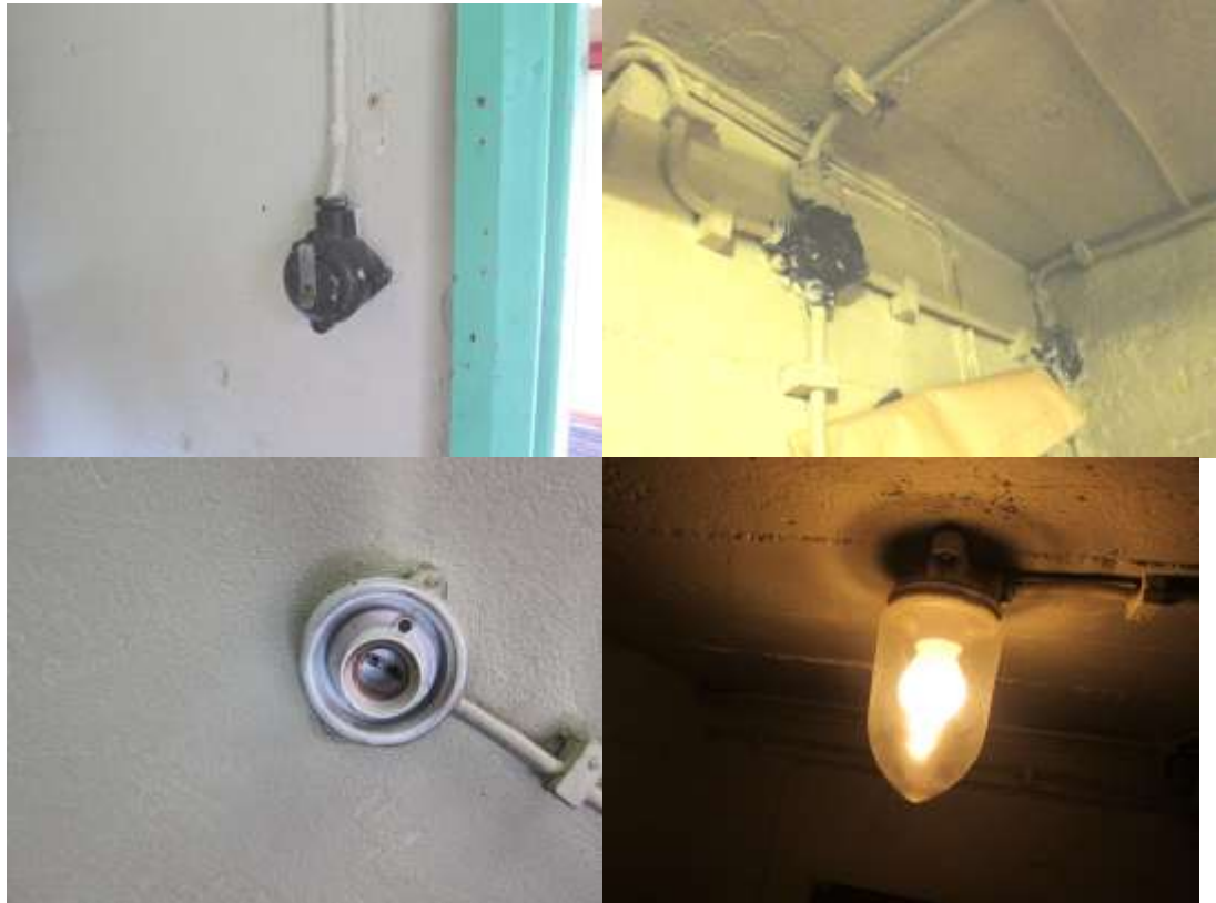
S4: Pohjakerroksessa on jäljellä runsaasti vanhoja johdotuksia, kytkimiä ja valasimia..
