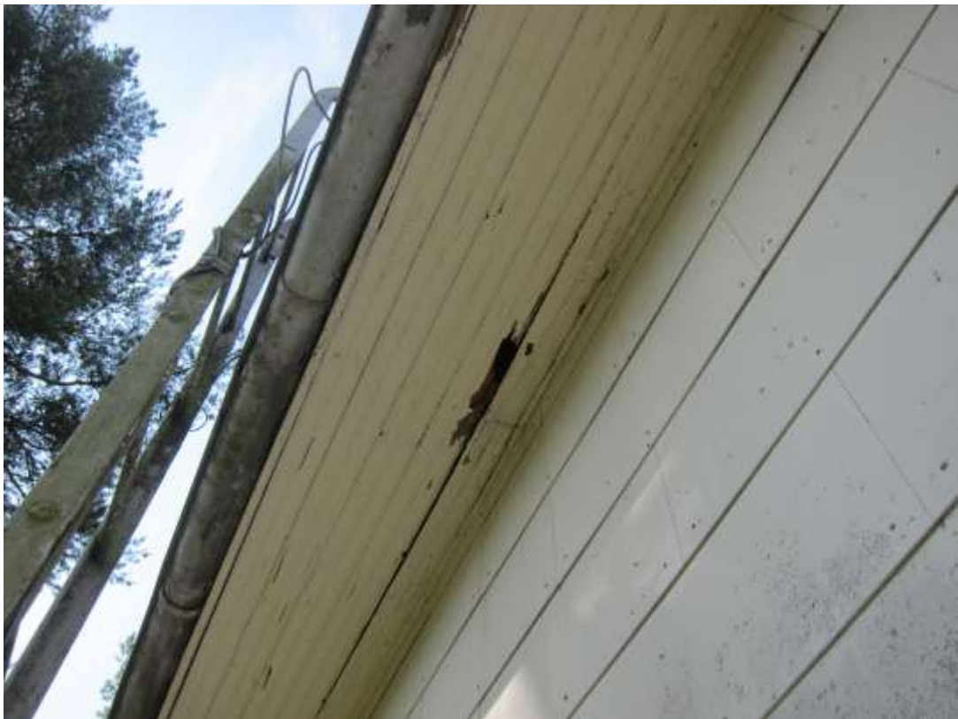
KUVA R18. Räystäiden aluslaudoituksessa maali hilseilee yleisesti, ja itäsivustalla on läpi lahonnut kohta.
