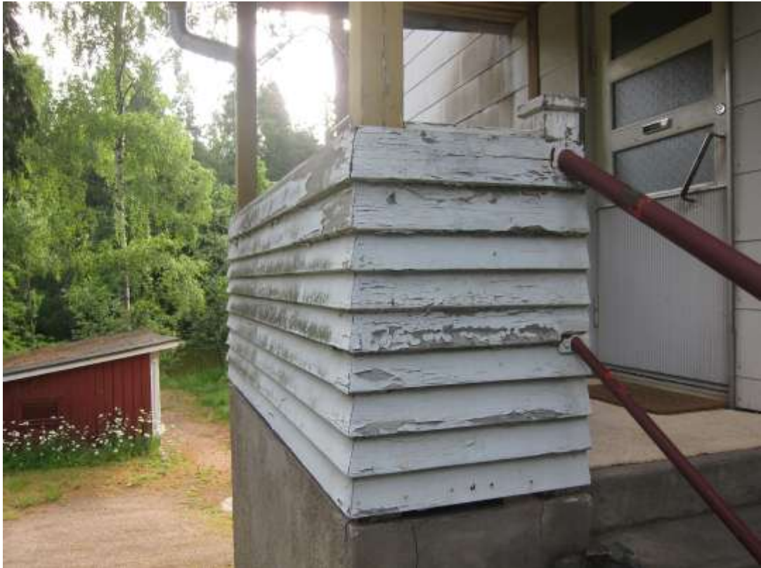
KUVA R5: Pohjoissivustan sisäänkäynti, katos ja ulkoporras. Katos valuttaa vedet seinälle ja portaalle.
