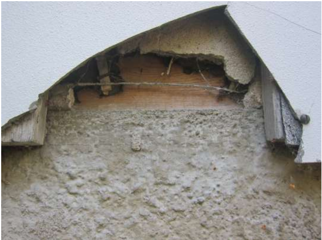
KUVA R8: Minerit- julkisivussa on kuvatun laisia rikkoutumia eri puolilla rakennusta.
