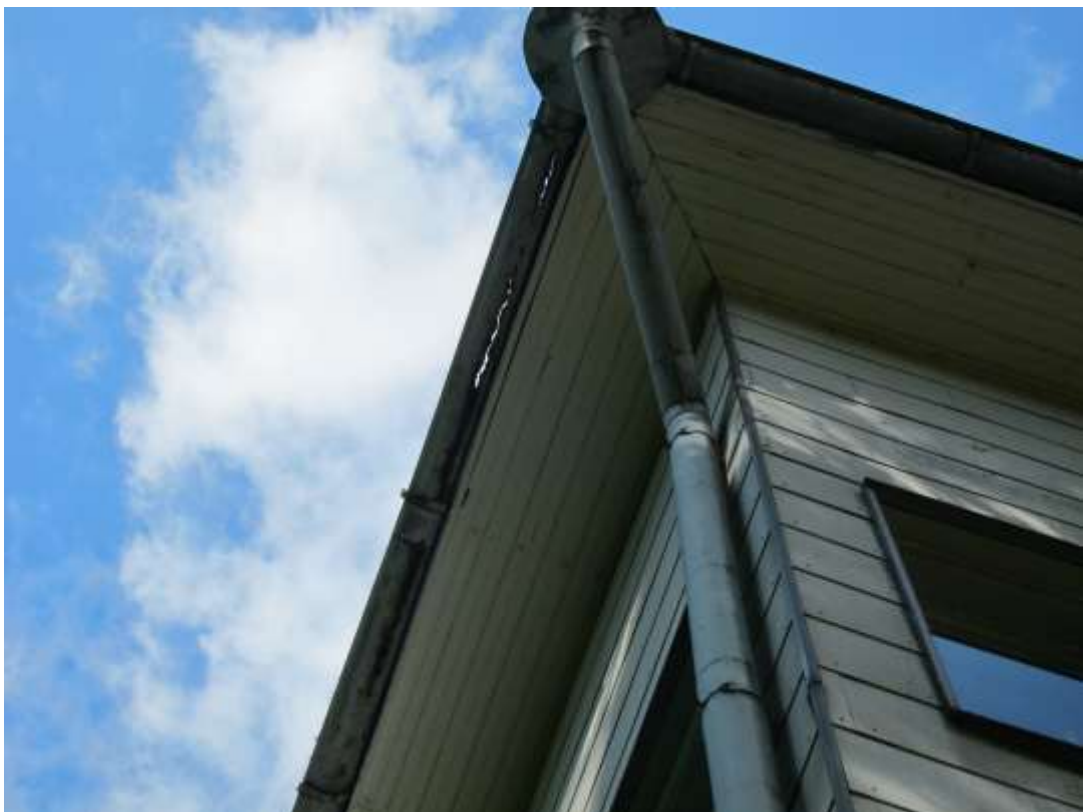
KUVA R16. Vesikourut ovat heikkokuntoiset; yleisesti kourut ovat ruosteiset, vääntyneet, ja kuvan tapauksessa myös puhki ruostuneet.
