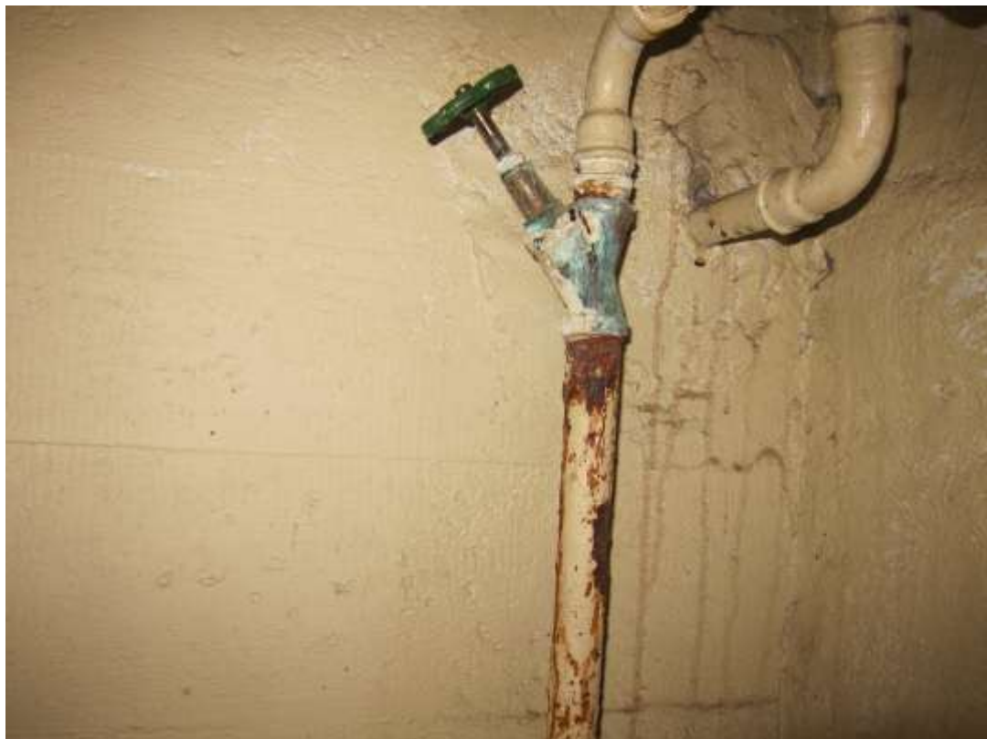
Kuva: L4. Pannuhuoneesta viereiselle pesutuvan patterille johtavat lämmitysputket ja sen karaventtiili ovat erityisen heikkokuntoisia.
