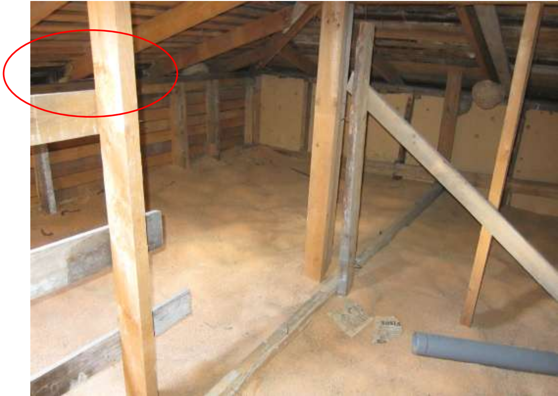
KUVA R19. Yläpohjatila. Räystäskoteloissa kosteuden aiheuttamaa puuaineksen tummentumaa. Punaisella ympyröity itäisivusta räystästä, jossa eniten tummentumaa, kts. edellisen kuvan laho.
