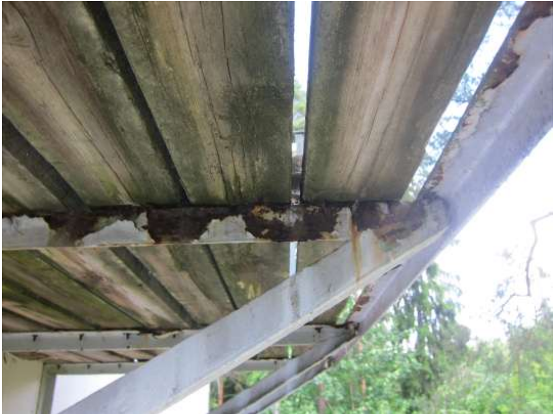
KUVA R15. Parvekkeen teräsrunkoa ja soirojen kiinnitys lähempää kuvattuna.
