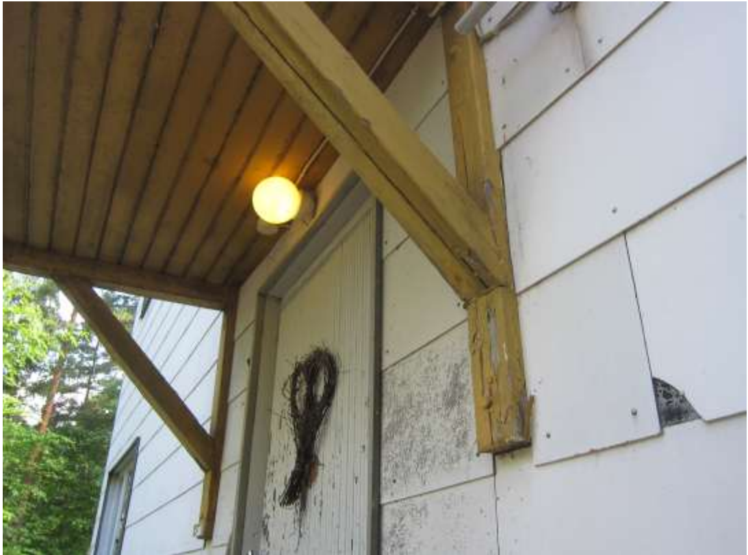
KUVA R7: Minerit- julkisivussa on kuvatun laisia rikkoutumia ja värjäytymiä eri puolilla rakennusta.
