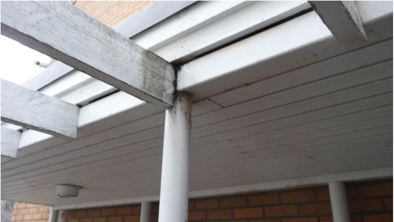
Kuva 9. Sadekourun vesikourun vuotoja
