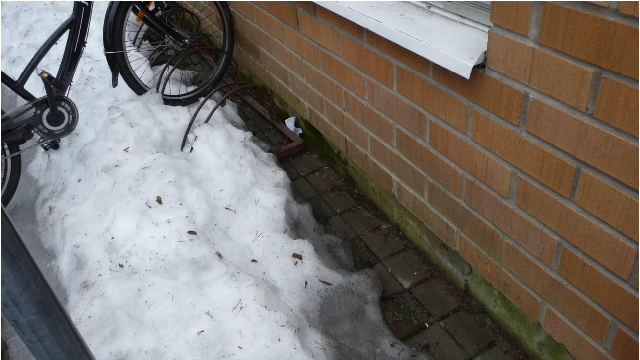
Kuva 7. Keittiön oven alueen sokkelialue, Ei havaittu patolevyä
