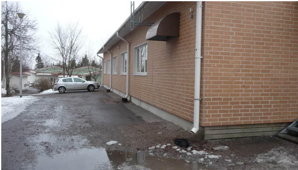
Kuva 2. Sivukoulun itäpuoli. Sadevedet ei osu kunnolla sadevesiviemäriin.
