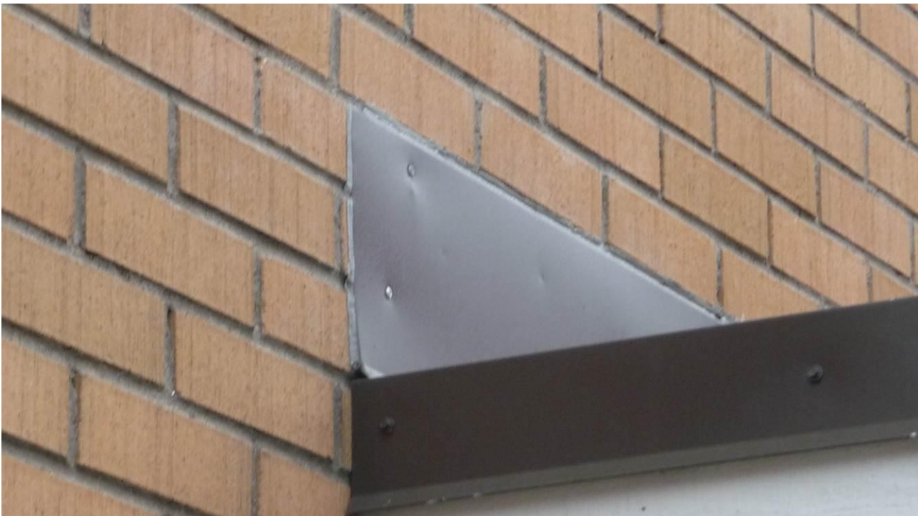
Kuva 10. Länsisisäänkäynnin katon pellitys siisti ja tiivistetty
