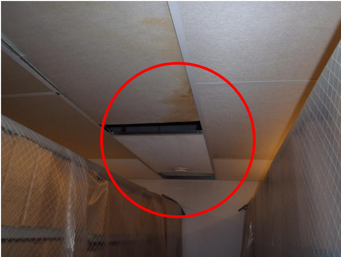
Arkistohuoneessa 3233 oli havaittu vesivuotoja kattorakenteen liikuntasaumojen kautta. Arkiston hyllyköt oli huputettu suojamuoveihin.
