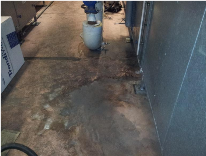
Toinen kuva iv-konehuoneen kosteusvauriojäljistä.
