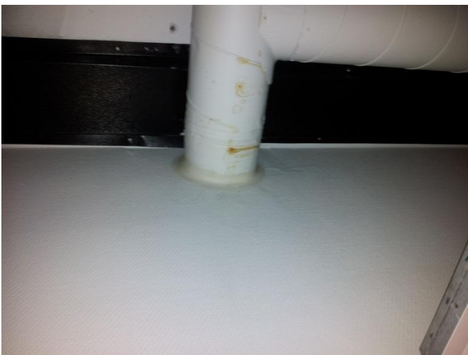
Kuva arkistohuoneen kattorakenteen liikuntasaumasta ja vuotojäljistä.
